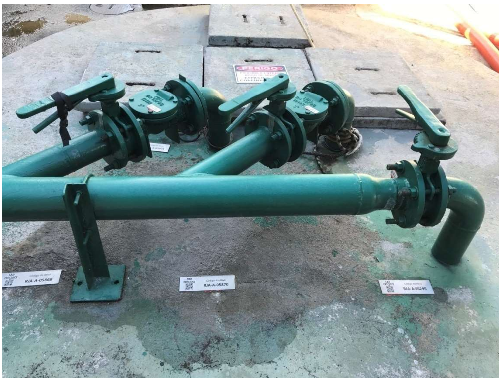
Foto 09 – Elevatória de recalque
