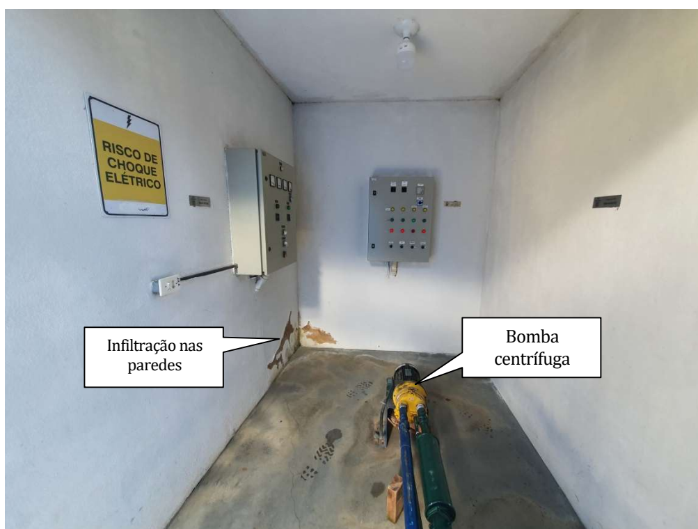
Foto 30 – Sala de comando
