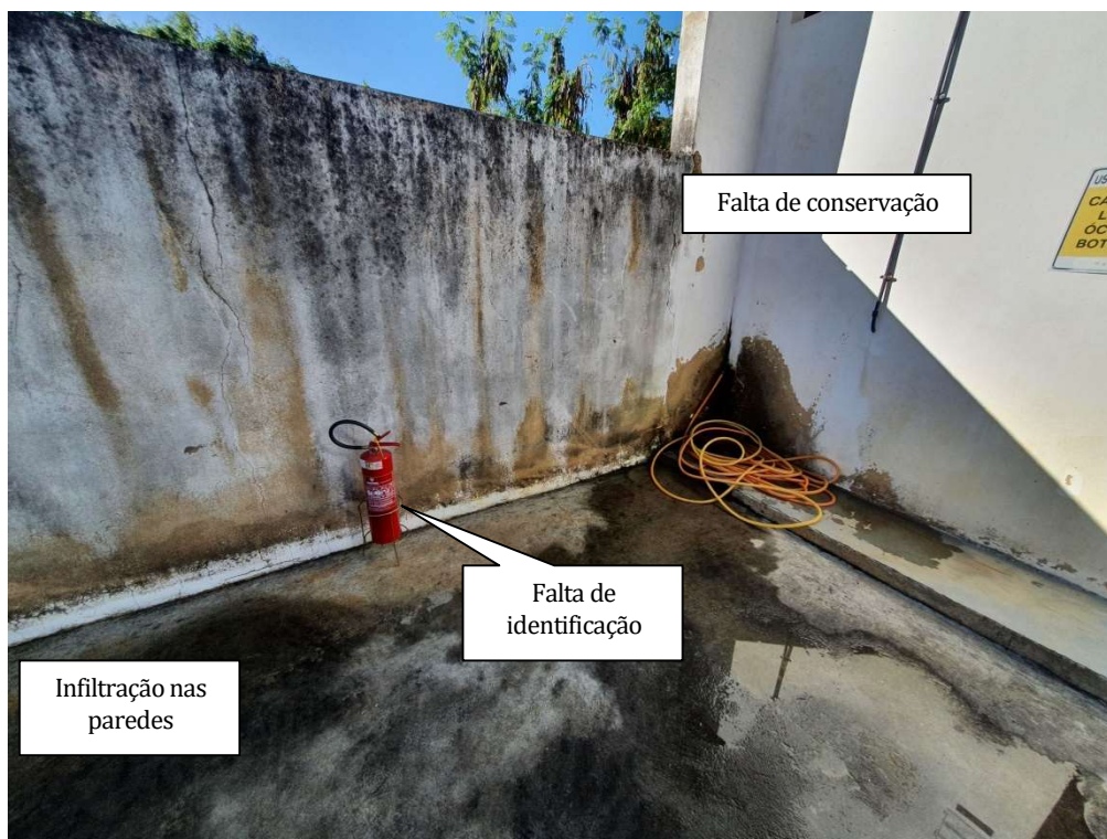
Foto 05 - Vazamento nas paredes da ETA
