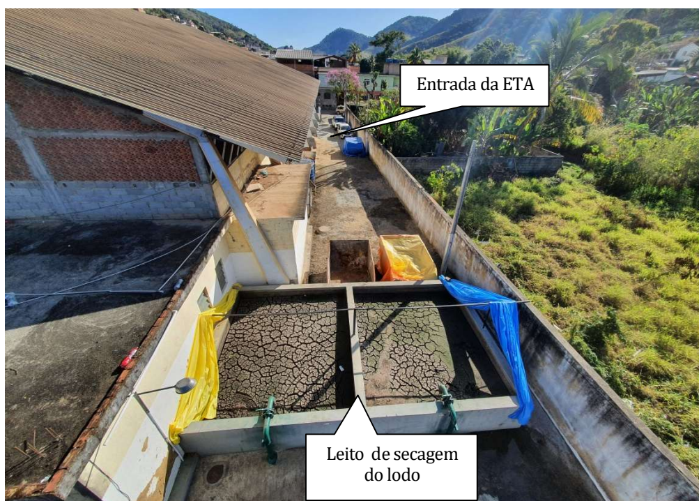
Foto 22 – Leito de secagem de lodo
