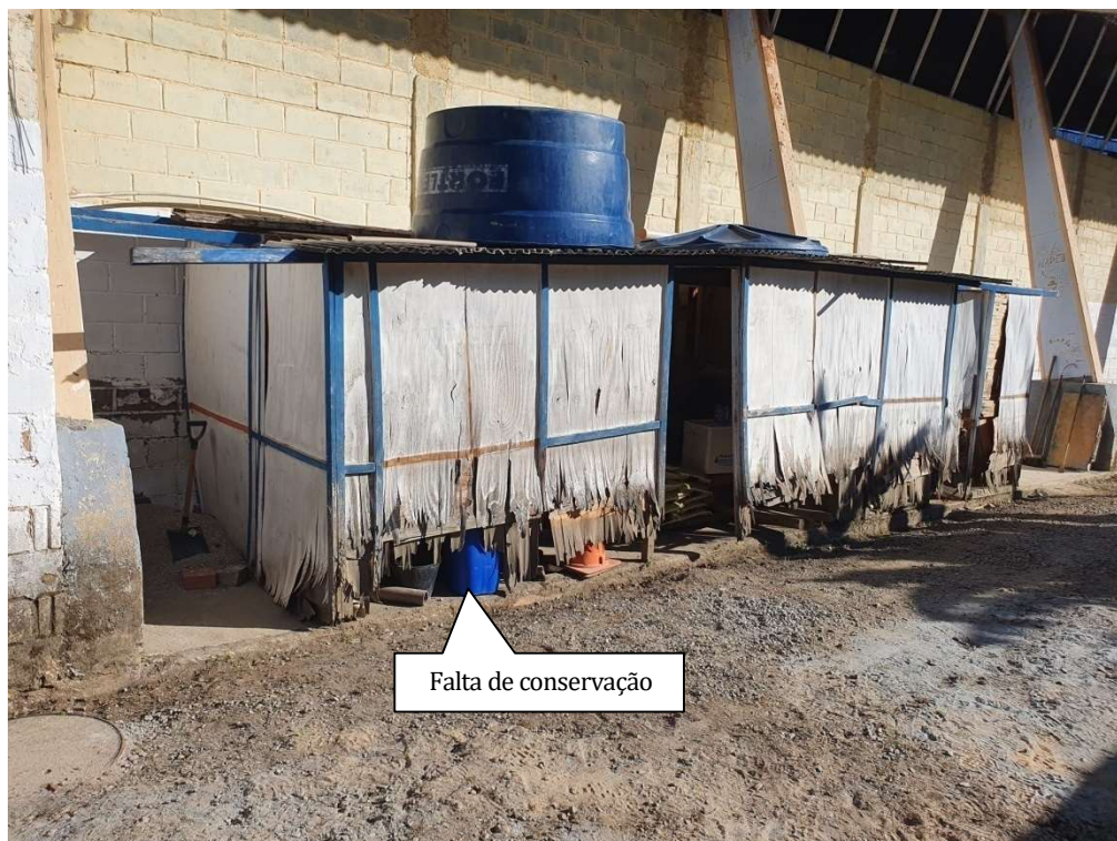
Foto 03 – Almojarifado com paredes quebradas
