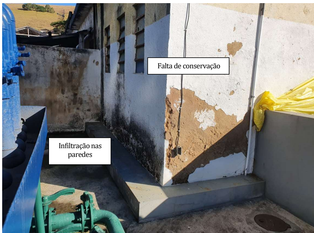
Foto 04 – Vazamento nas paredes da ETA
