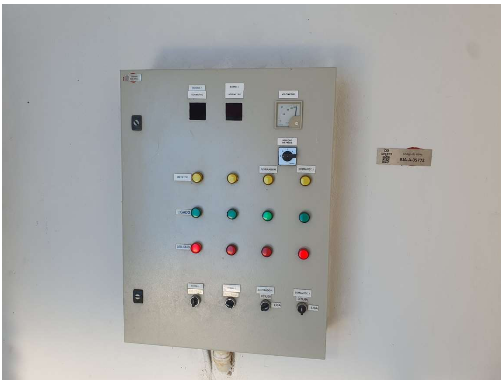
Foto 32 – Painel elétrico de comando
