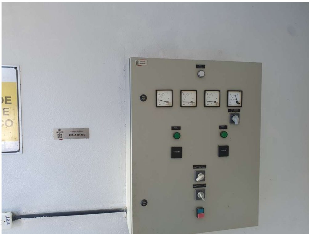
Foto 31 – Painel elétrico de comando
