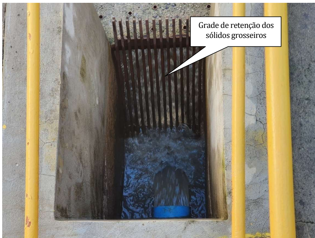
Foto 06 – Entrada de esgoto bruto
