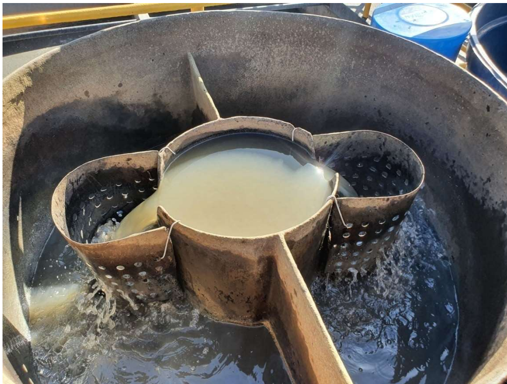
Foto 13 – Tanque de chegada
