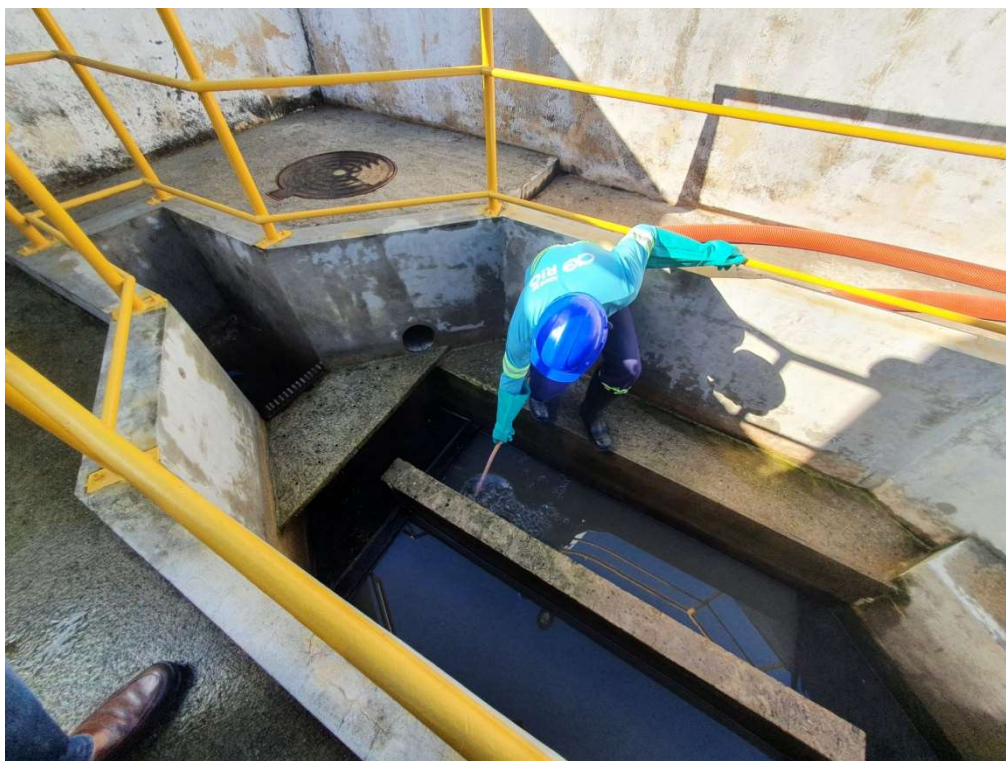
Foto 26 – Entrada do esgoto bruto
