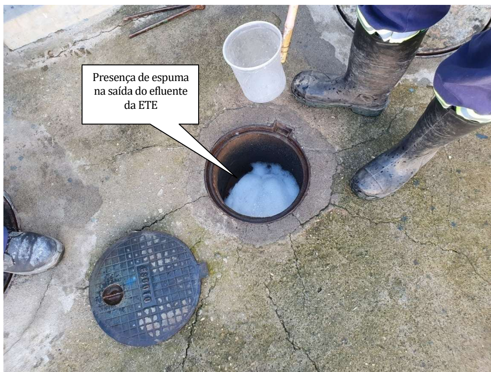
Foto 25 – Saída do efluente da ETE
