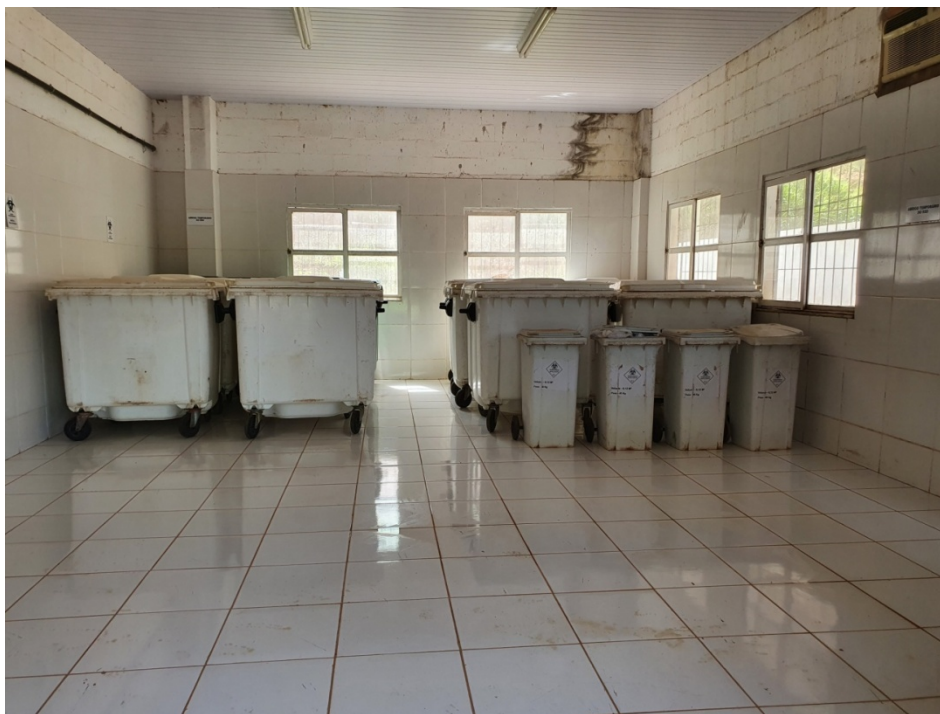
Figura 16: Abrigo temporário de RSS. Onde os resíduos são estocados até serem direcionados para a SERVIOESTE, empresa contratada para realizar a autoclavagem.
