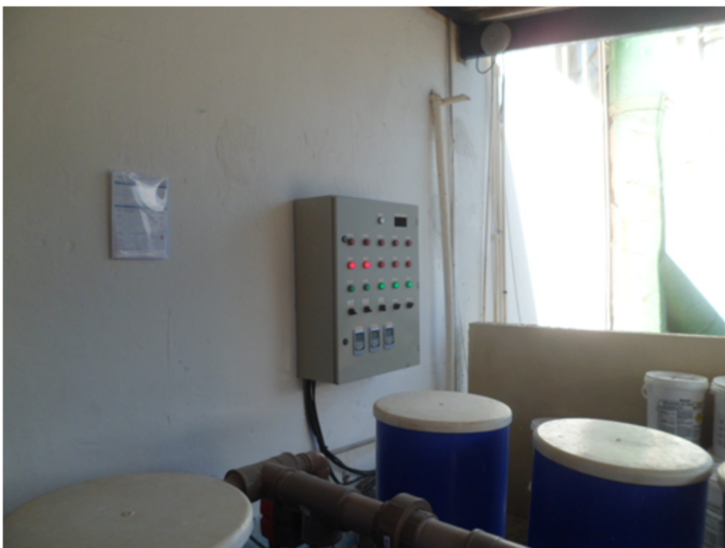
Foto 23 – Painele de Automação do Hipoclorito
