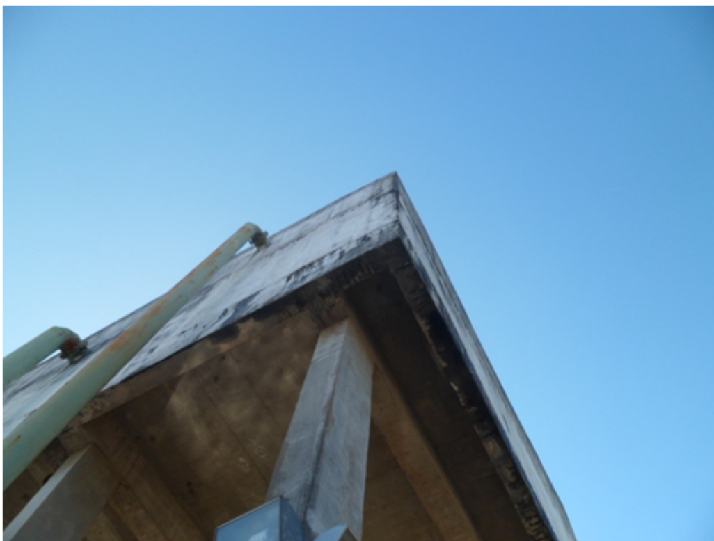
Foto 18– Infiltrações na Base da Caixa D'Água de Lavagem dos Filtros
