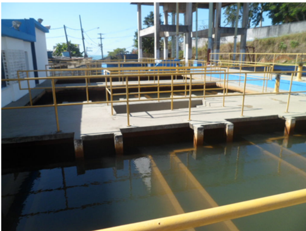
Foto 16 – 06 (seis) Filtros Advindos dos Decantadores
