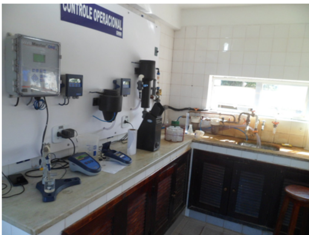
Foto 05 – Sala de Controle Operacional ETA
