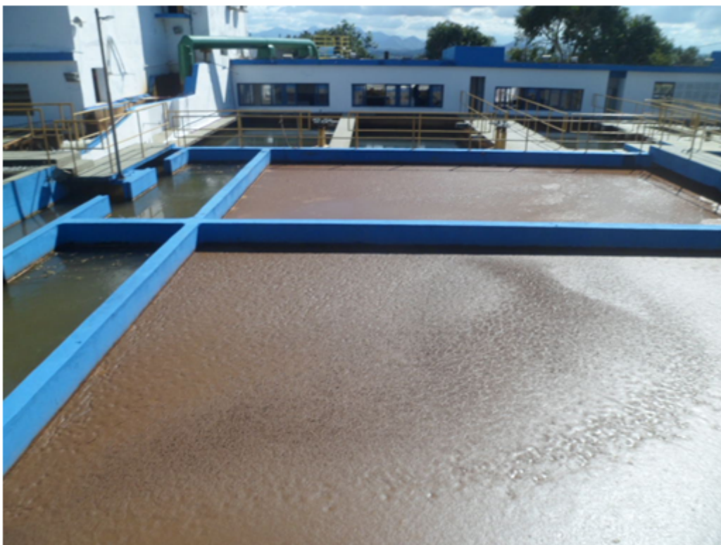
Foto 12 – 02 (dois) Tanques Floculação
