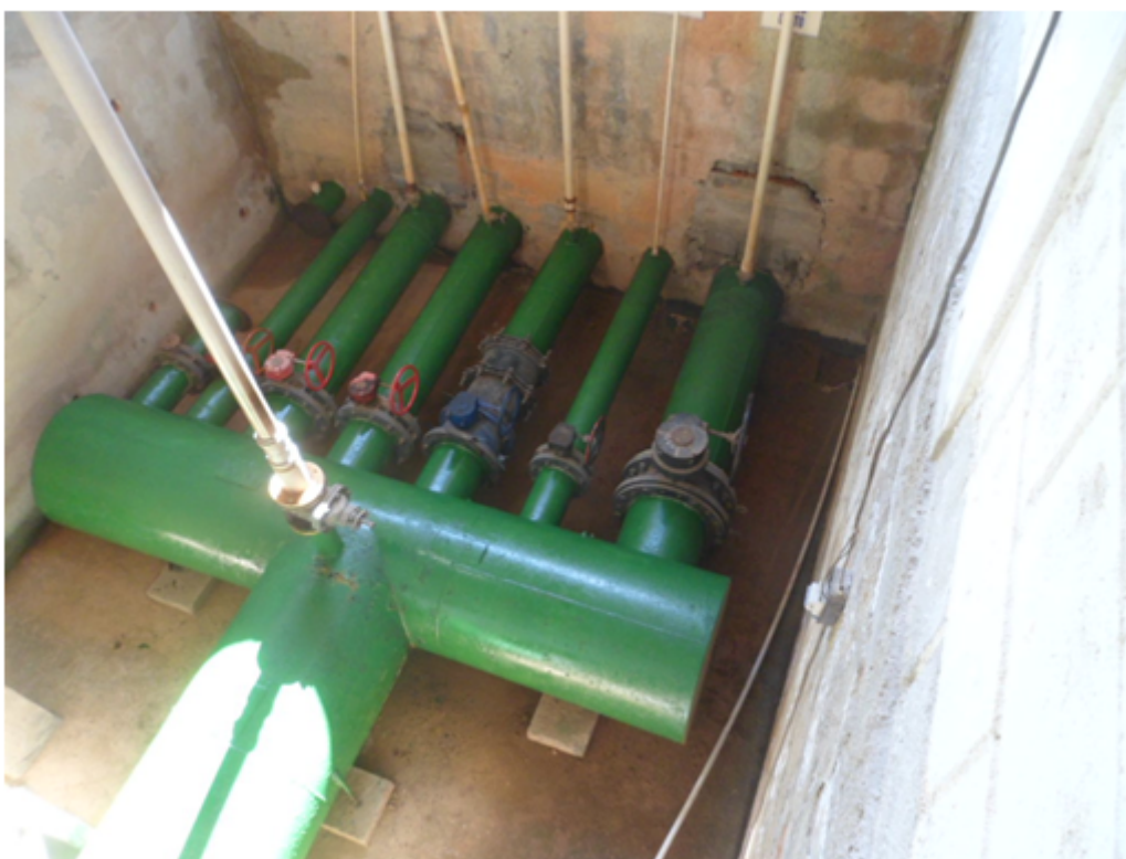
Foto 27 – Barriletes de Distribuição
