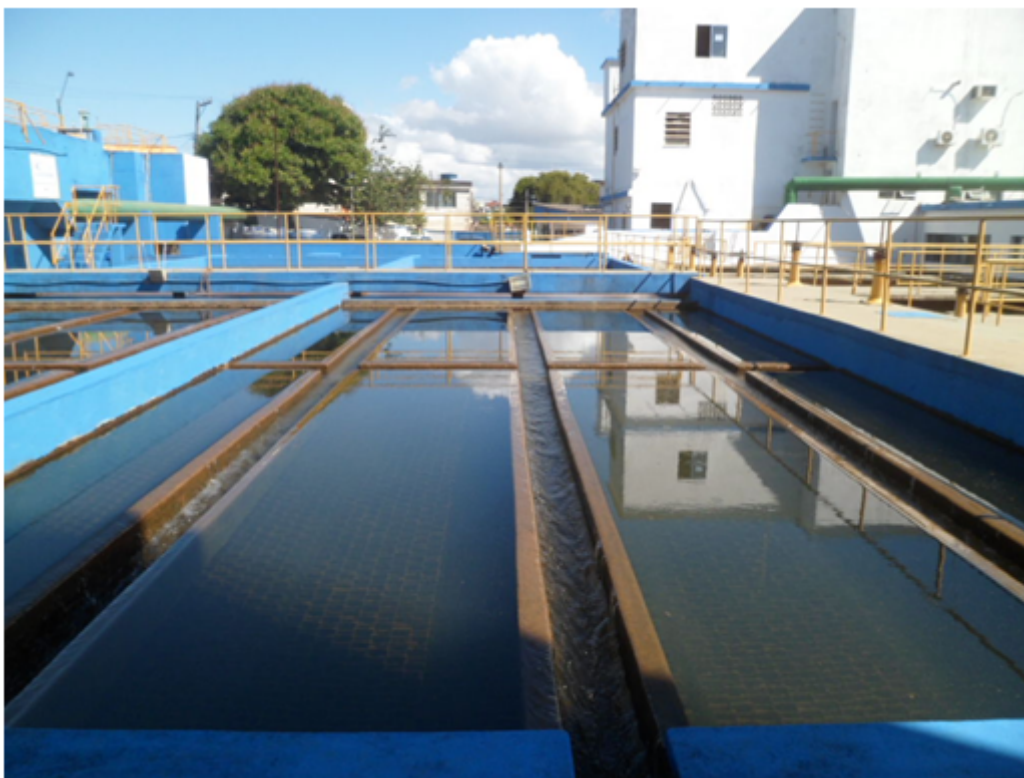
Foto 14 – Tanques de Decantação
