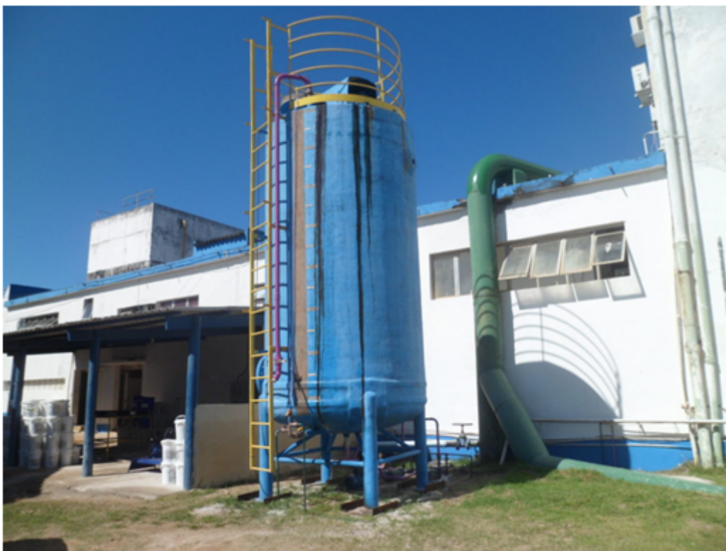
Foto 24 – Reservatório de Hidróxido de Cálcio
