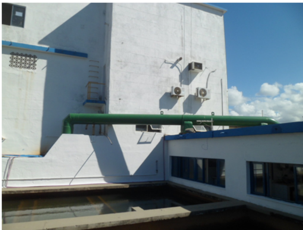
Foto 09 – Chegada da Água Bruta pela Primeira Adutora
