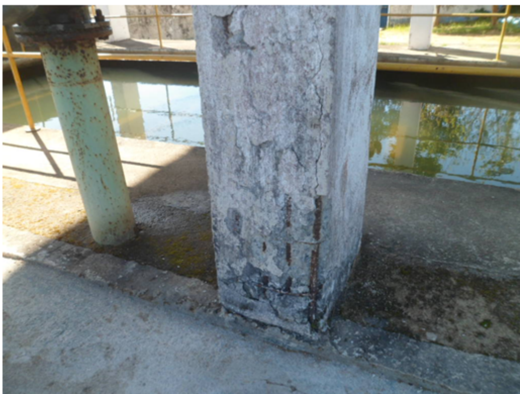
Foto 17 – Ferragens expostas e Trincas no Concreto no Pilar da Caixa D'Água
