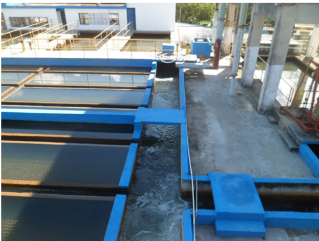
Foto 15 – Canal Receptor das Águas Vindas dos Decantadores para Filtragem
