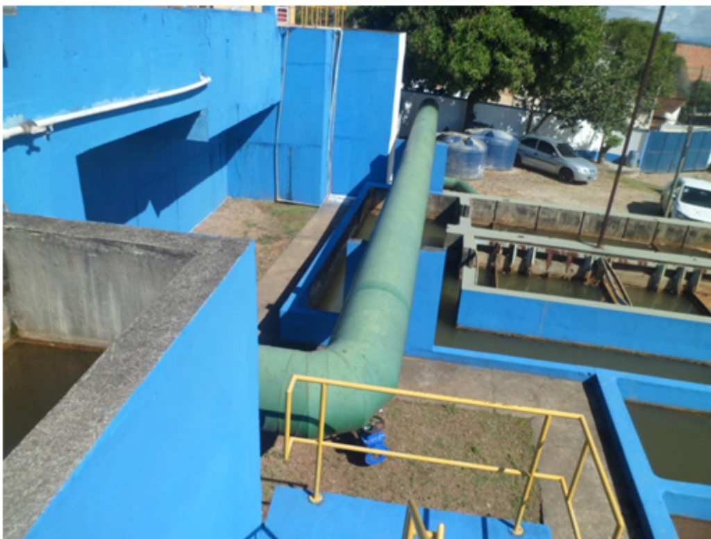
Foto 10 – Chegada da Água Bruta pela Segunda Adutora
