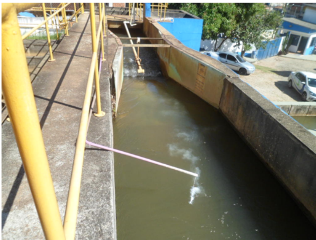
Foto 11 – Calha Parshall, Entrada Água Bruta e Dosagem de Hidróxido de Cálcio em Suspensão
