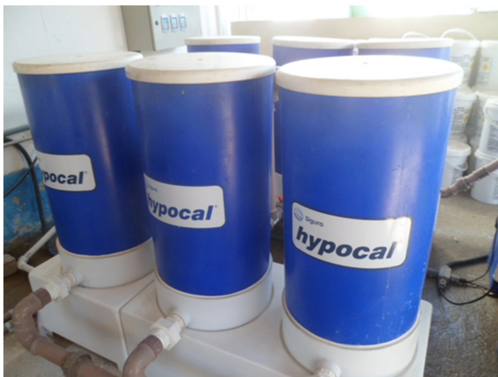
Foto 21– Tanques de Hipoclorito (Dosadores)
