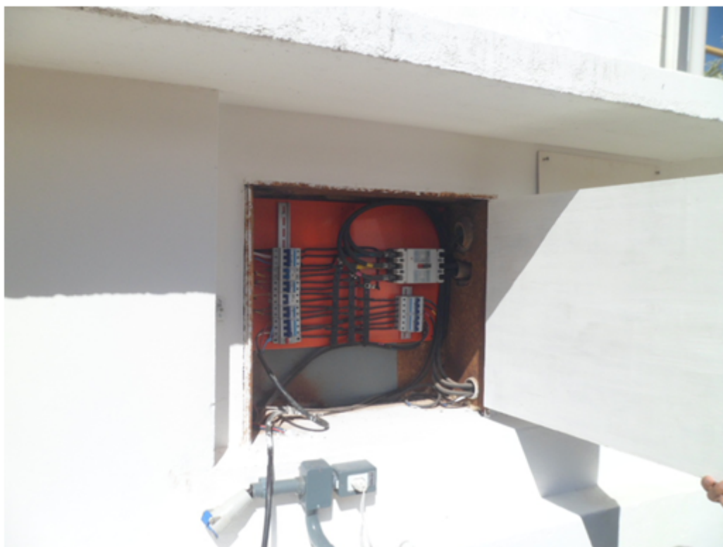
Foto 25 – Quadro Elétrico com Porta
