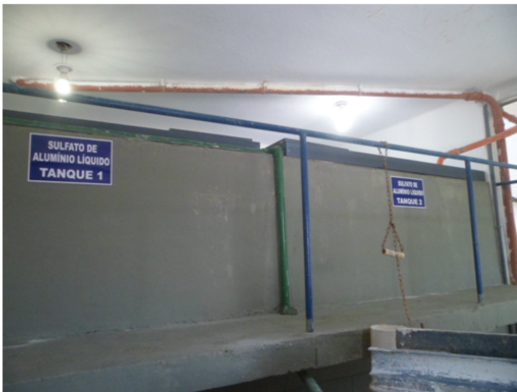
Foto 26 – Tanques de Sulfato de Alumínio Líquido
