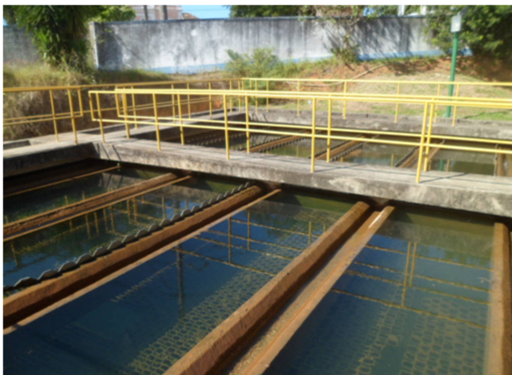
Foto 13 – Tanques de Decantação
