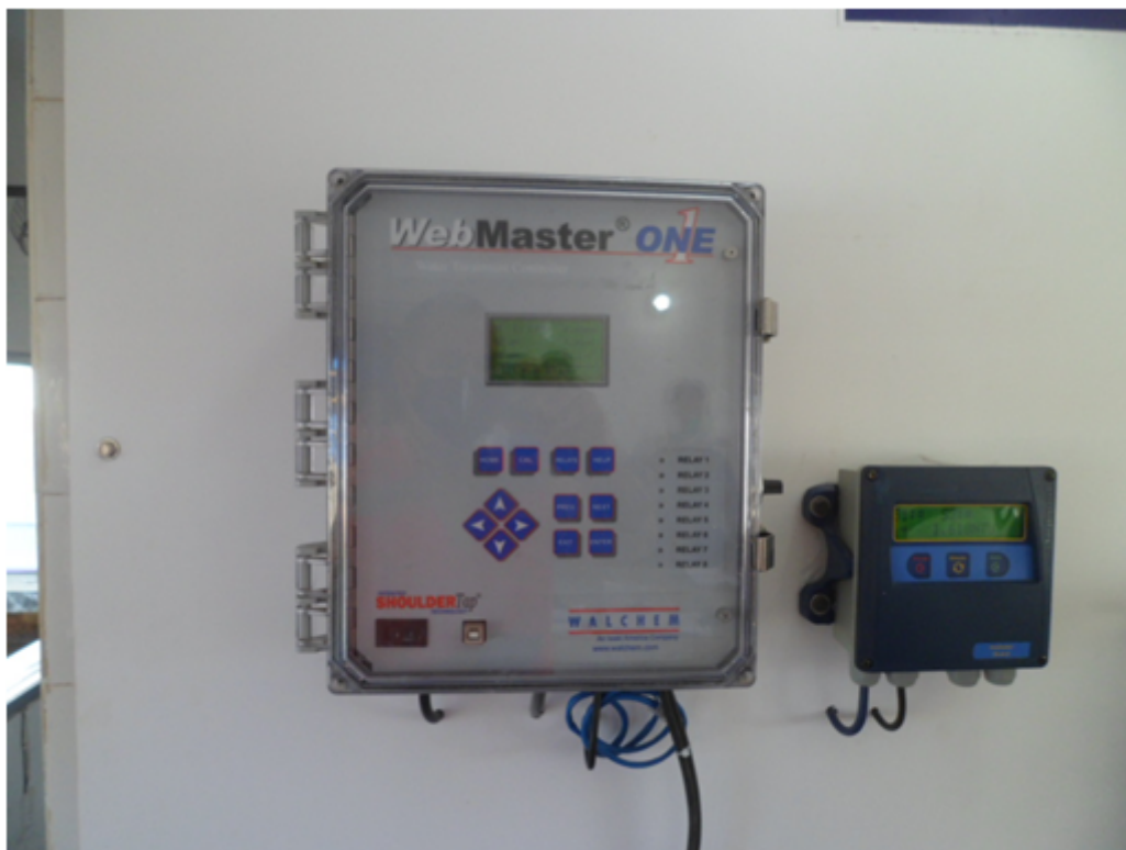
Foto 06 – Controlador Automatizado que Mede, Controla e Dosa o Cloro
