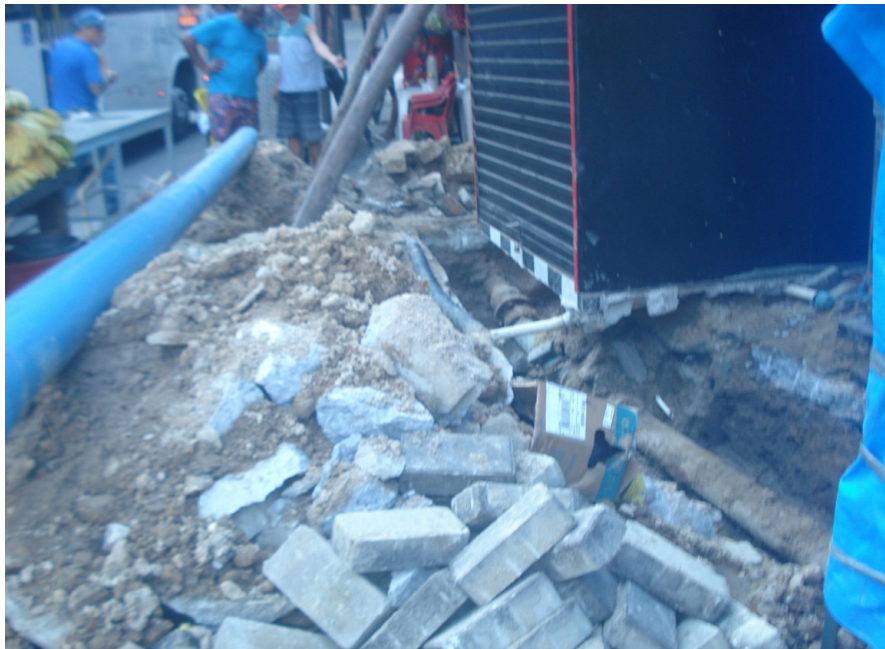
Foto 03 – Registro entupido embaixo de Barraca (Largo das Flores), sem placa de sinalização
