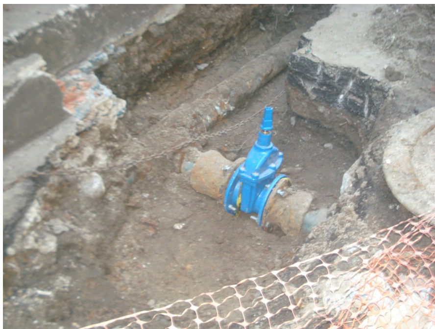
Foto 10 – Substituição de Registro (Rua Caminho dos Boiadeiros) sem placas de sinalização
