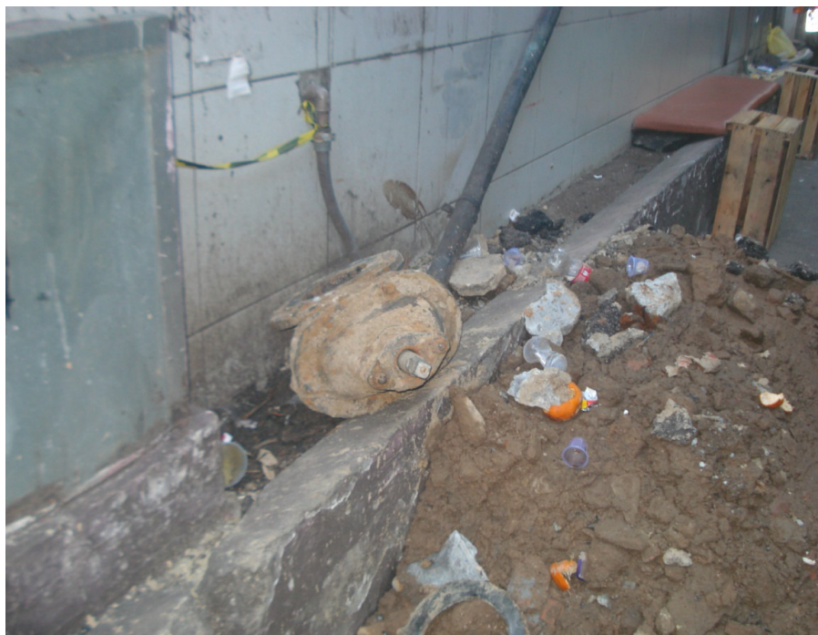
Foto 07 – Registro Danificado Retirado (Travessa Mesopotânia no Bairro Barcelos)
