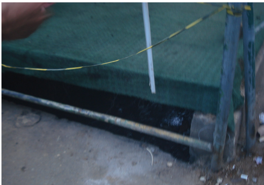
Foto 16 – Tubulação abaixo de estrutura de ferro (Rua do Valão) ponto crítico da visita
