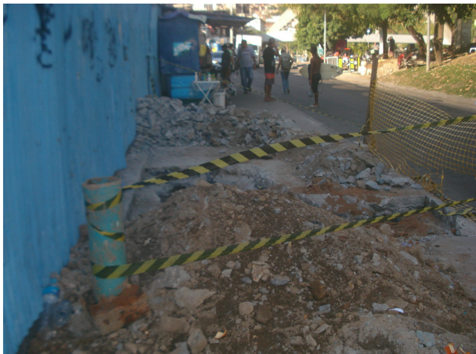
Foto 05 – Substituição de Registro (Estrada Lagoa Barra), sem placa de sinalização
