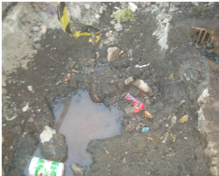
Foto 09 – Registro totalmente danificado (Rua Caminho dos Boiadeiros)
