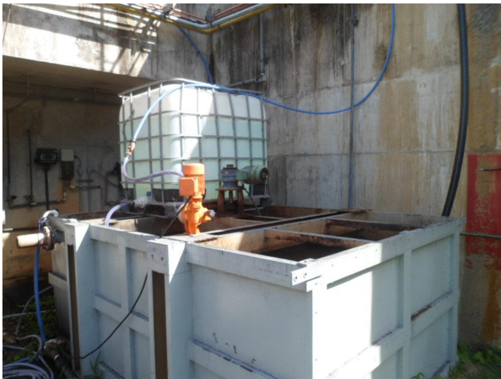
Foto 10 – Reservatório de Peróxido e Depósito de Carvão Ativado para lançamento no tanque
