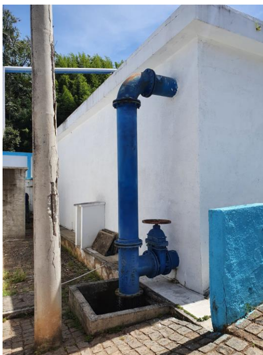
Tubulação do extravasor e descarga de fundo em Ferro Fundido com DN 400 mm.
