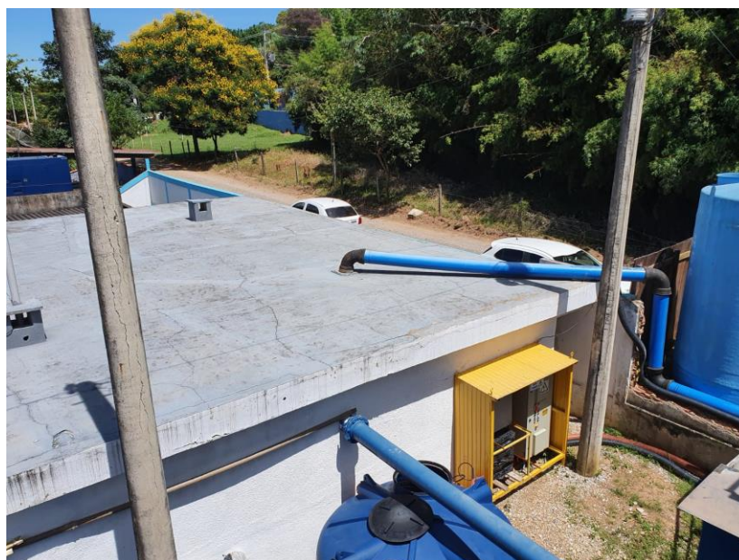
Tubulação DEFOFO DN 150 mm que sai da ETA móvel e abastece o reservatório
