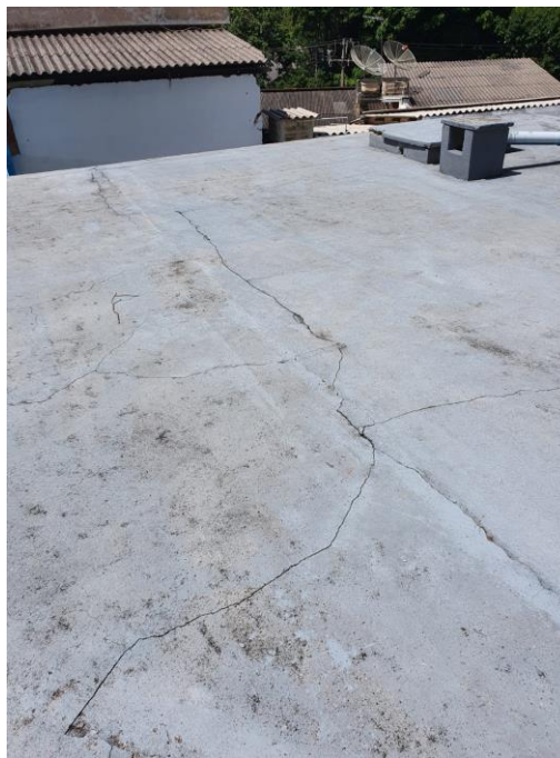
trincas na laje da cobertura
