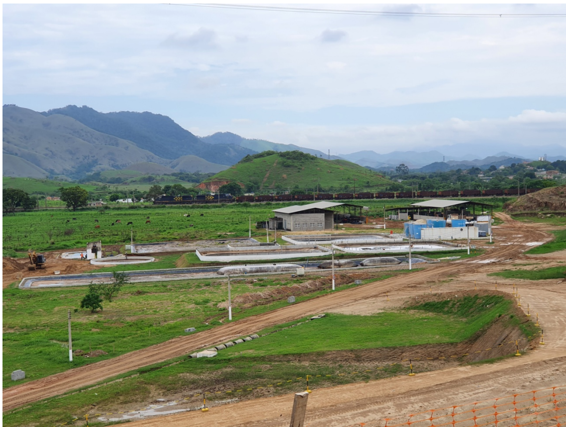
Figura 06: Vista da estação de tratamento de chorume
