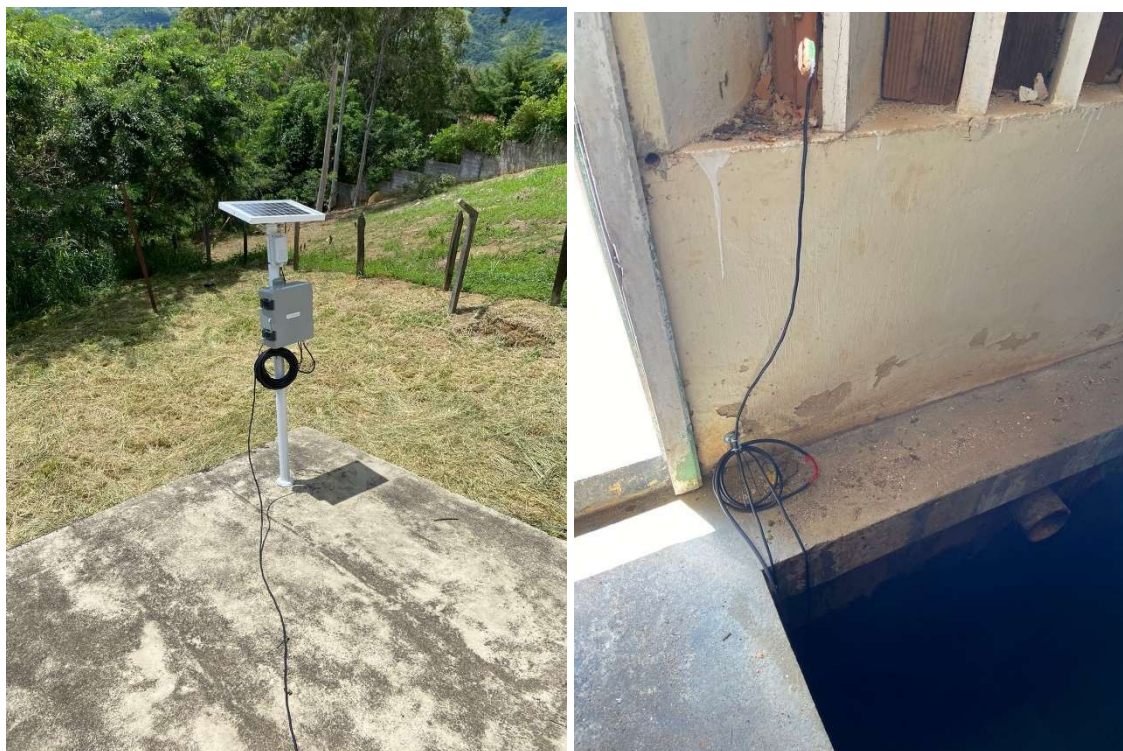
Sistema de monitoramento remoto do reservatório
