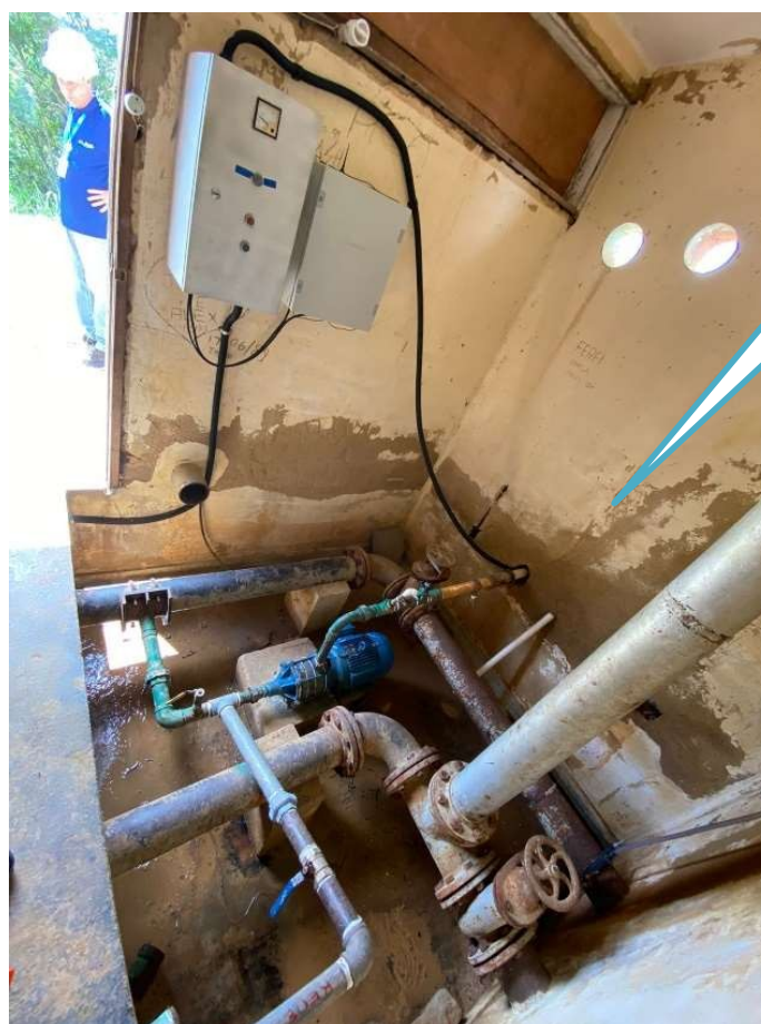
Interior da casa de bombas
