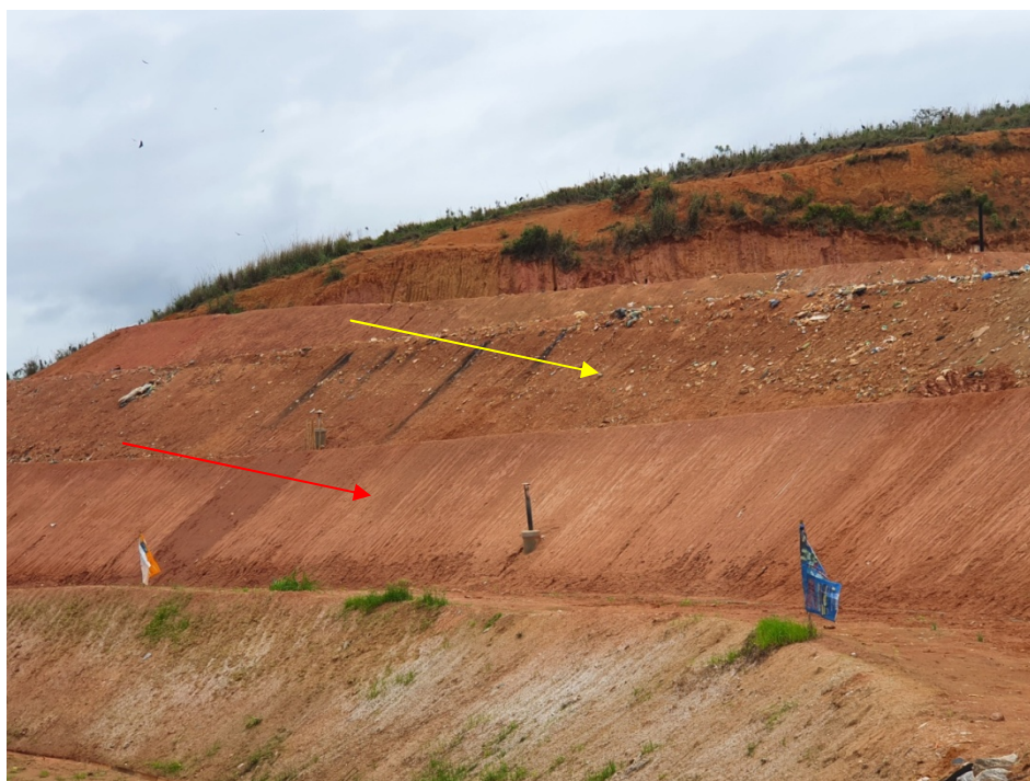
Figura 9: Vista de camadas com operação concluída, porém, faltando a colocação de colchão reno (indicada com seta vermelha) e outra camada faltando cobertura e o colchão reno (indicada com seta amarela).
