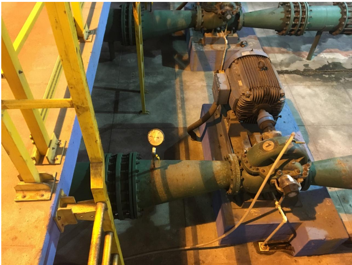
CONJUNTO MOTOR-BOMBA Nº 1
