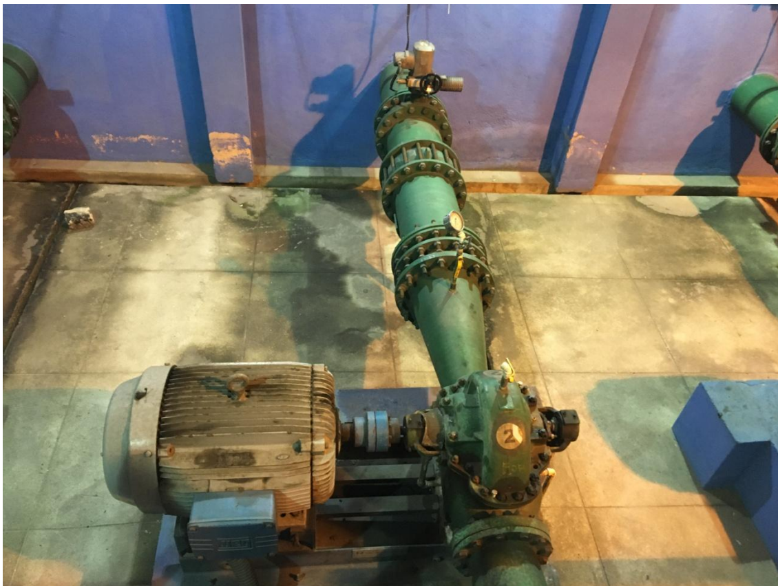
CONJUNTO MOTOR-BOMBA Nº 2
