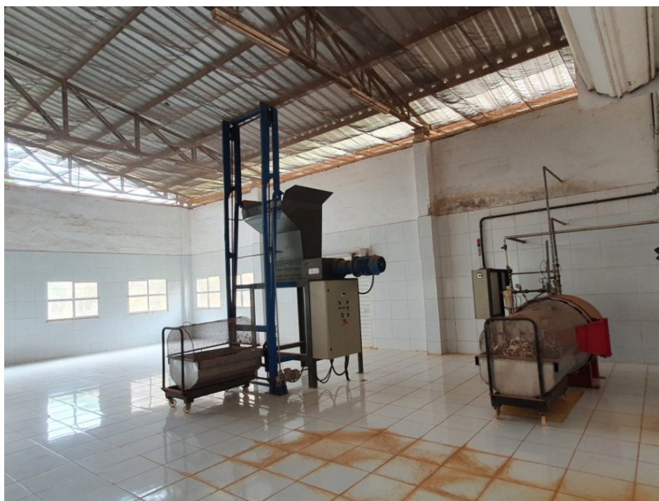
Figura 13: Autoclave disponibilizada para realizar o tratamento de RSS. Inoperante.
