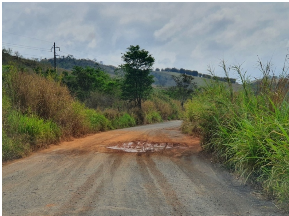
Figura 3: Trecho da estrada de acesso onde pode ser observado um declive.
