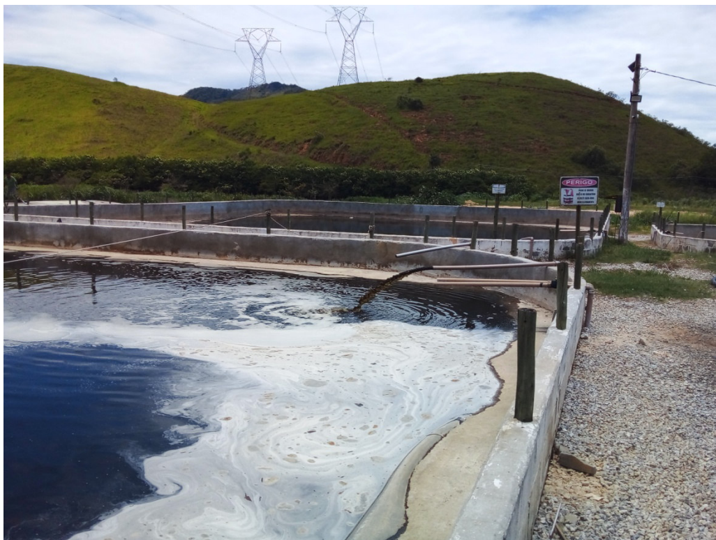
Figura 8: Lagoa de chorume primária com areador em funcionamento
