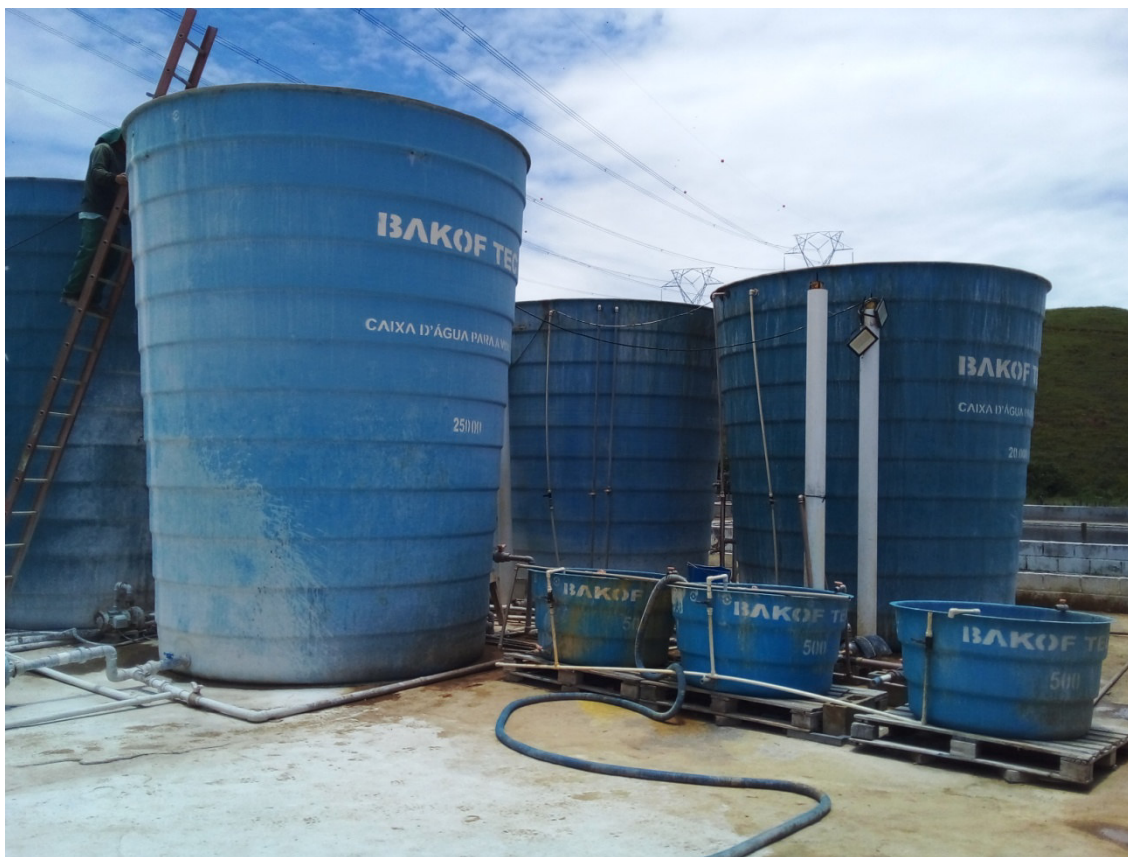
Figura 12 : Tanques de armazenamento para o tratamento da água em osmose reversa
