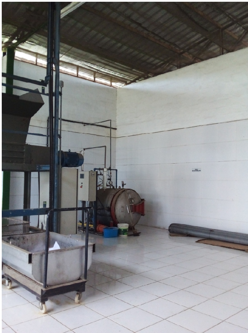
Figura 15: Vista da autoclave.
