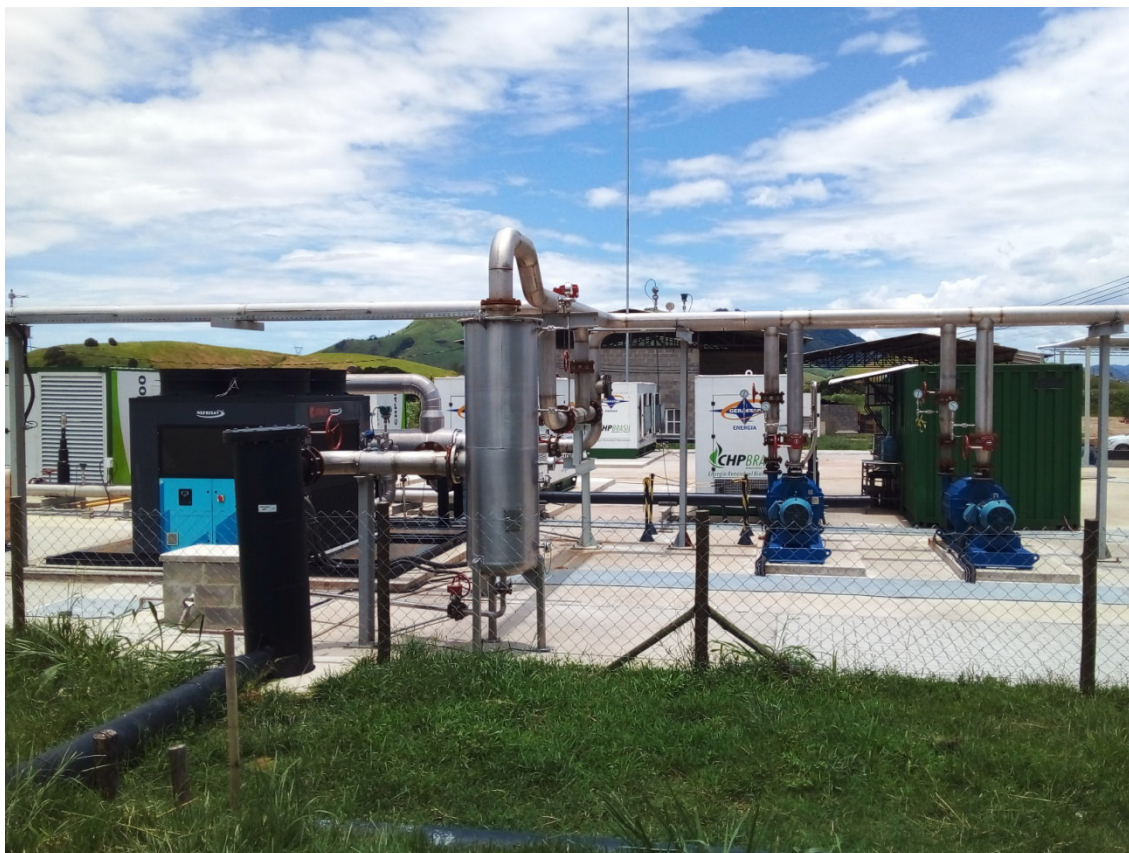
Figura 19: Vista da estação de Biogás
