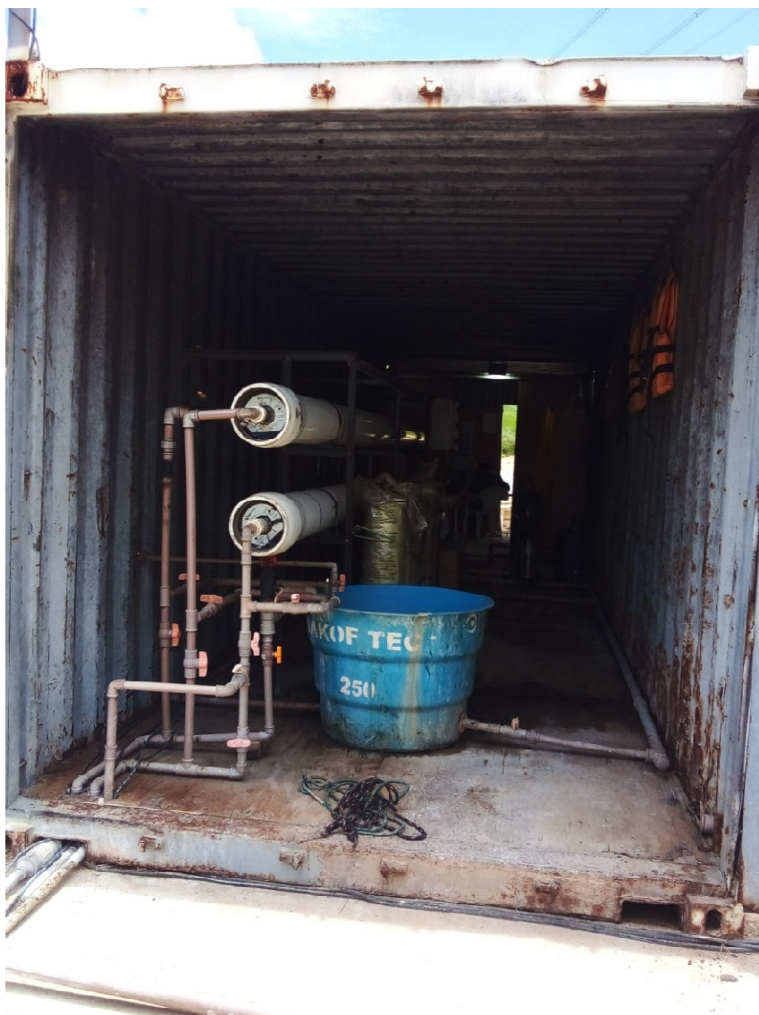
Figura 13 : Sistema de filtragem e membranas para a osmose reversa
