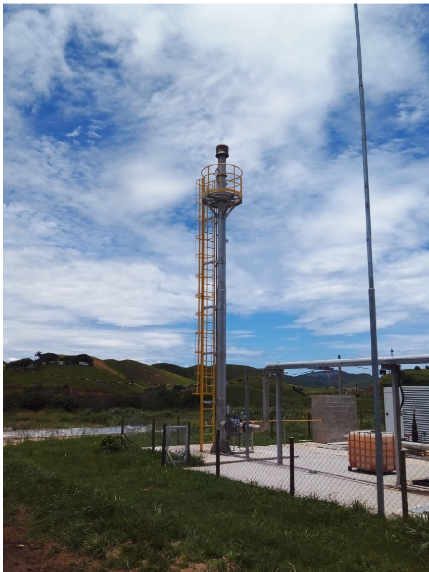
Figura 22: Flare da Estação de Biogás
