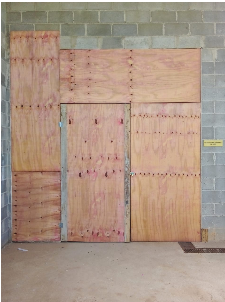
Figura 17: Porta de acesso ao RSS foi danificada, uma nova porta já se encontra em processo de produção .
