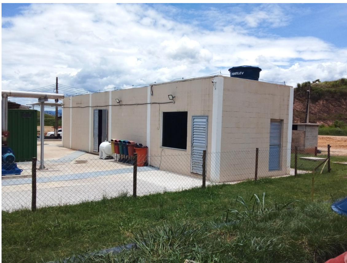
Figura 18: Vista da sala de controle da estação de Biogás
