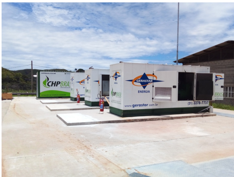
Figura 20: Vista dos geradores da estação de Biogás
