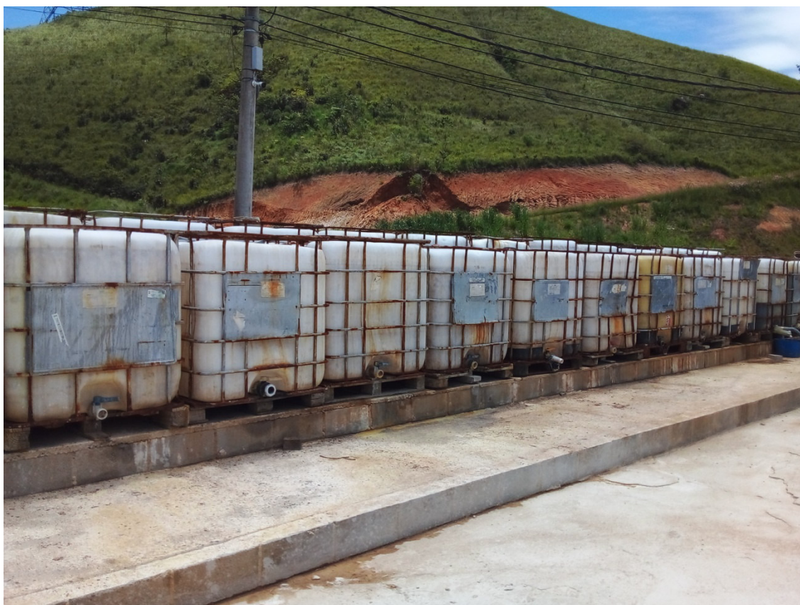
Figura 11 : Armazenagem dos produtos químicos para o tratamento do efluente gerado
