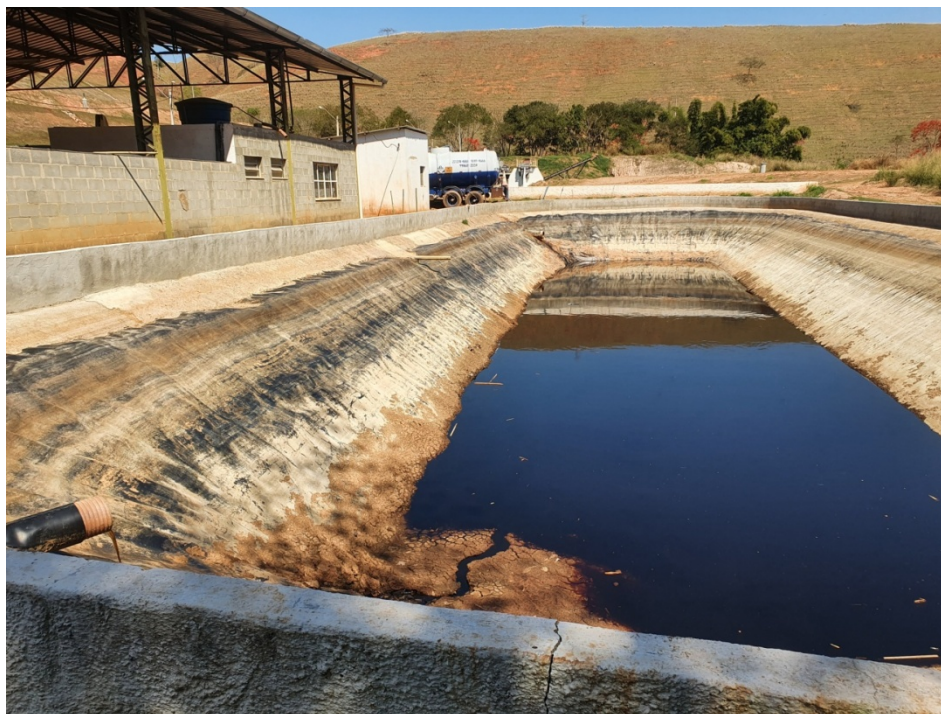
Figura 12: Lagoa de armazenamento de chorume.
