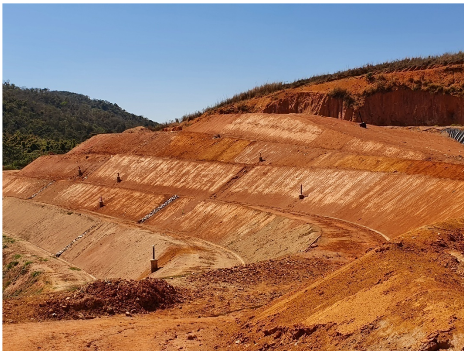
Figura 8: Vista de camadas da célula B com a operação concluída, com ausência de cobertura vegetal.
