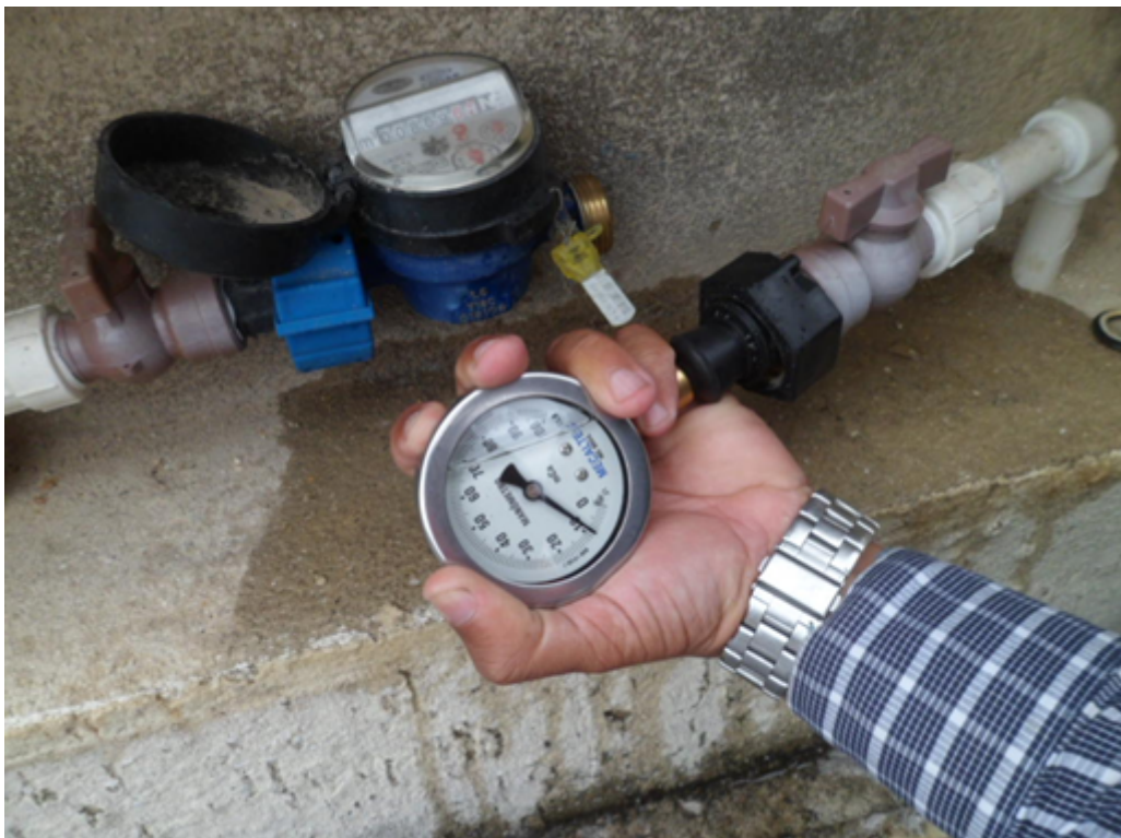
Foto 07 – Manômetro Marcando 10 M.C.A de Pressão
