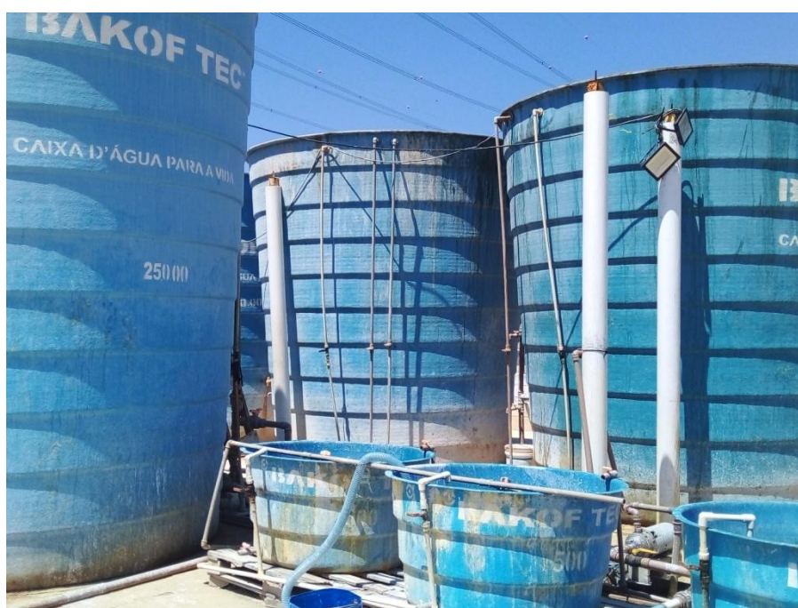
Figura 11 : Tanques de armazenamento para o tratamento da água em osmose reversa
