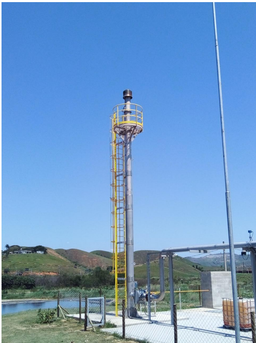
Figura 21: Flare da Estação de Biogás
