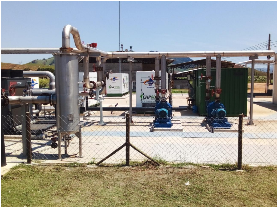
Figura 18: Vista da estação de Biogás
