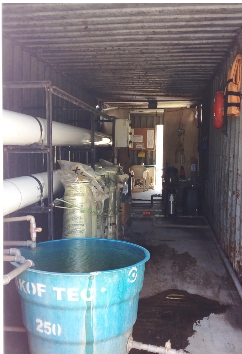
Figura 13 : Sistema de filtragem e membranas para a osmose reversa
