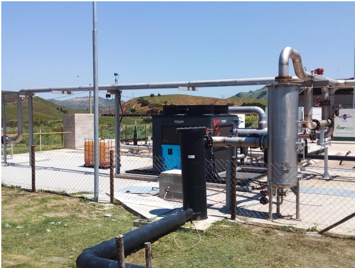
Figura 19: Vista da estação de Biogás
