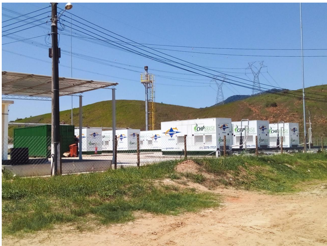
Figura 20: Vista dos geradores da estação de Biogás
