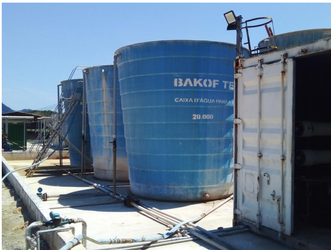
Figura 12 : Tanques de armazenamento para o tratamento da água em osmose reversa
