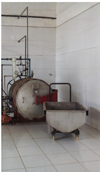
Figura 16: Vista da autoclave.
