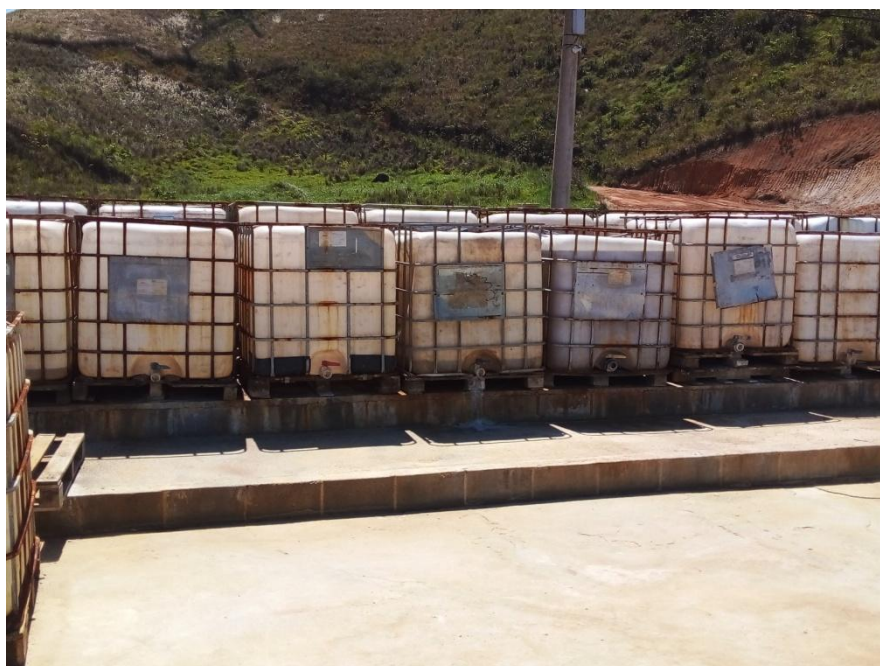
Figura 10 : Armazenagem dos produtos químicos para o tratamento do efluente gerado
