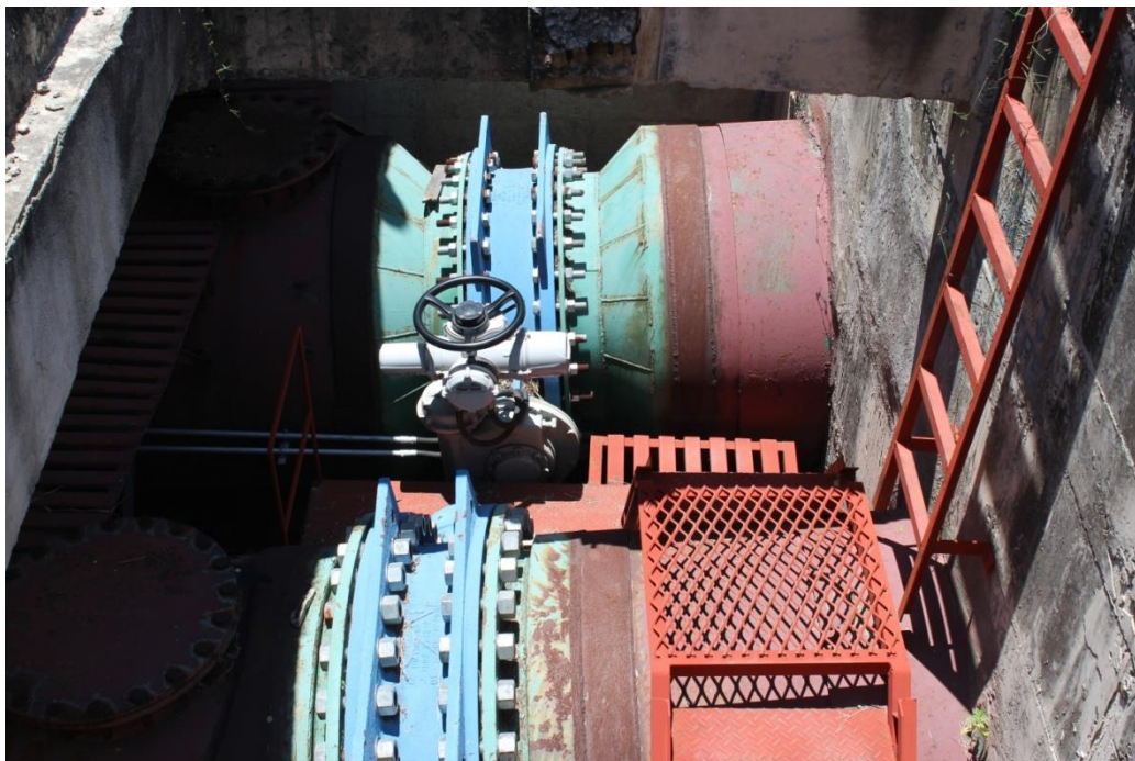
Adutora de abastecimento da Zona Norte
