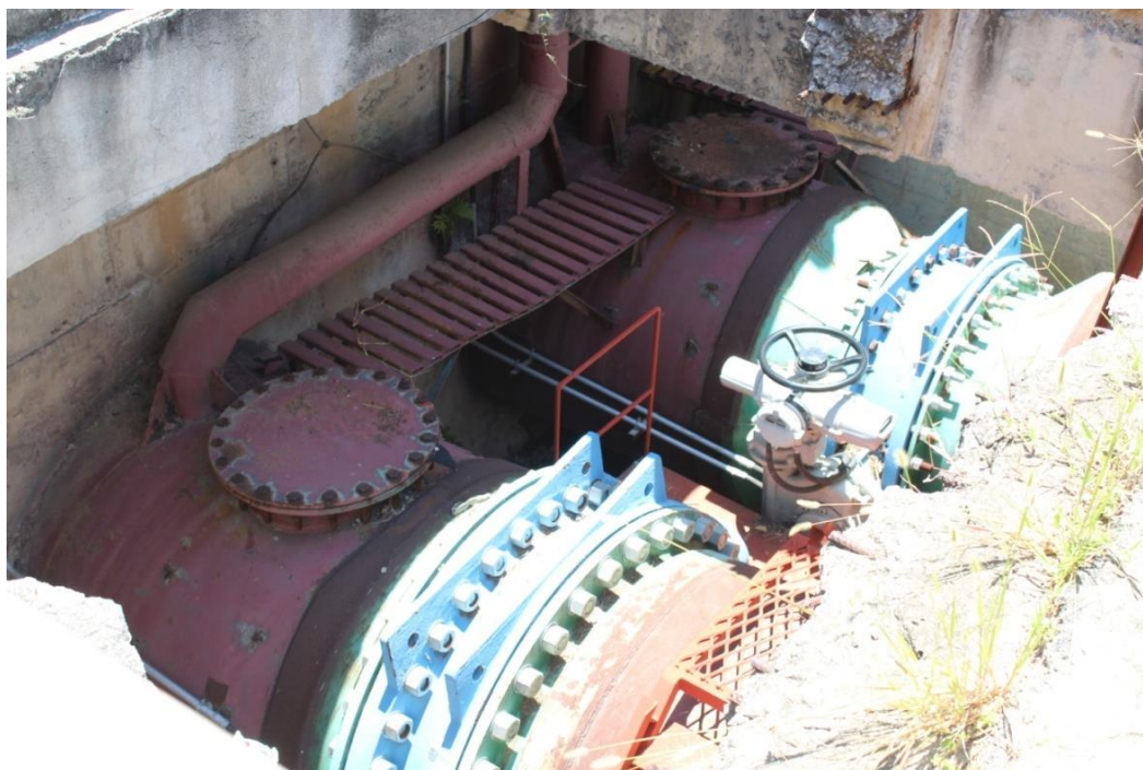
Adutora de abastecimento da Zona Oeste
