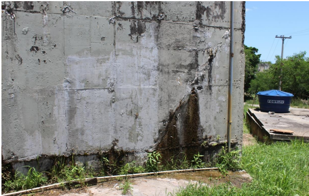
Infiltração da Caixa
