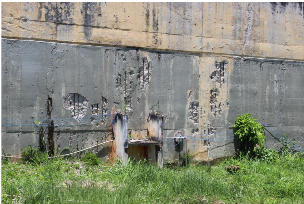
Infiltração da Caixa
