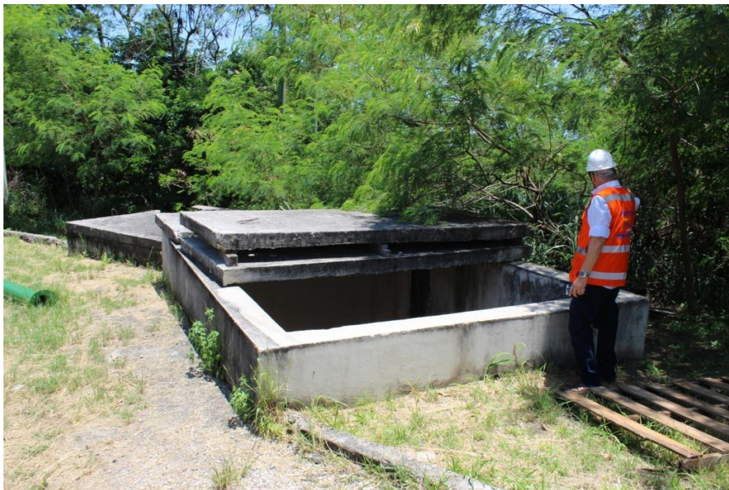
Adutora de abastecimento da Baixada Fluminense
