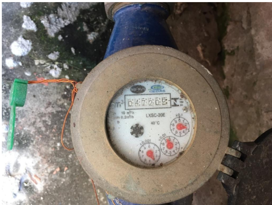
HIDRÔMETRO DO BLOCO E - DETALHE
