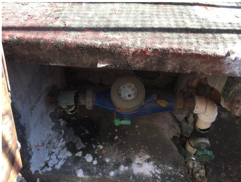
HIDRÔMETRO DO BLOCO E
