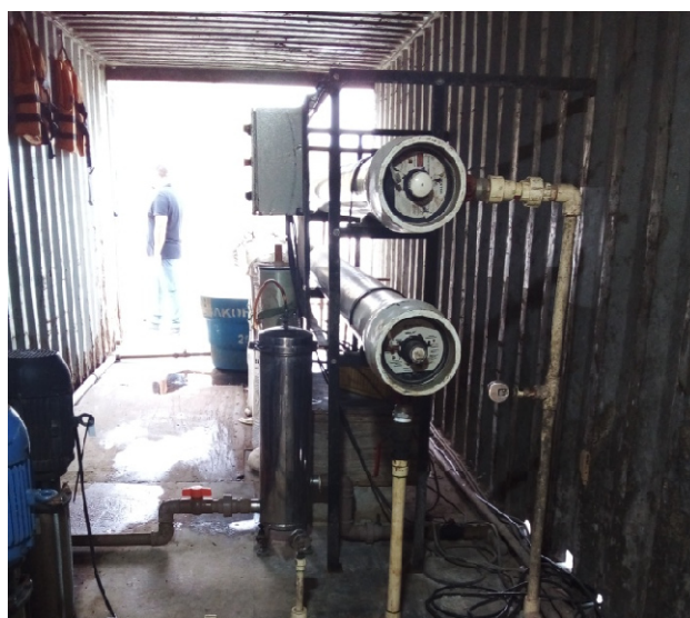
Figura 12 : Detalhe do equipamento de osmose reversa
