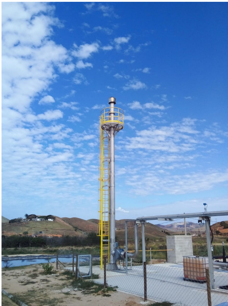
Figura 22: Vista da Estação de biogás.
