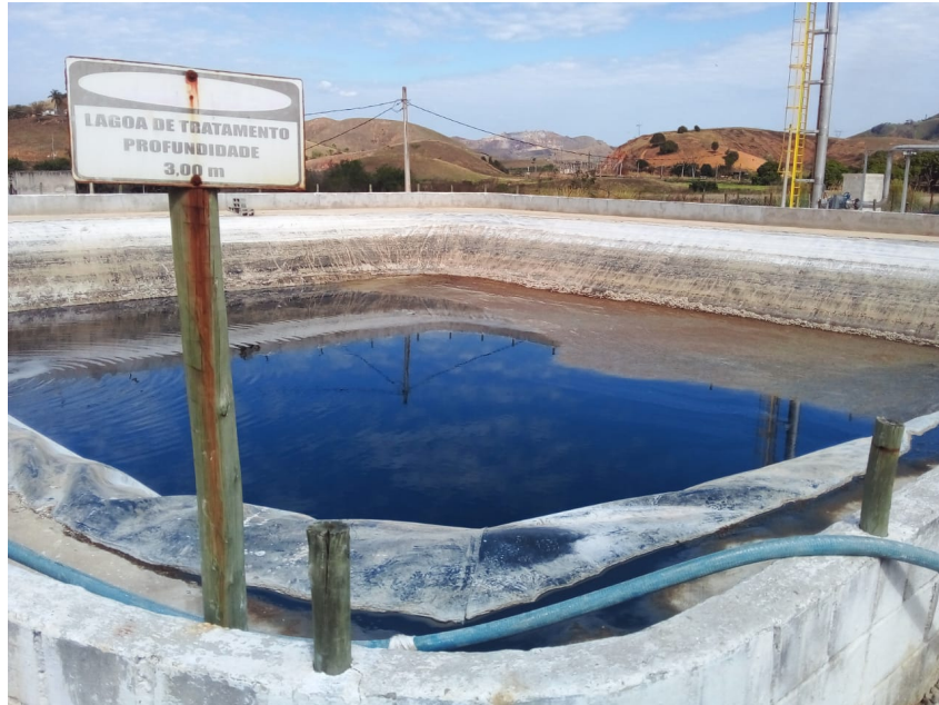
Figura 9: Segunda lagoa de chorume em manutenção para a retirada do lodo acumulado
