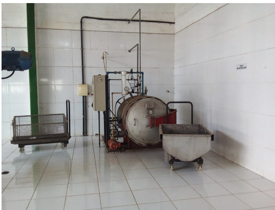
Figura 17: Vista da autoclave.
