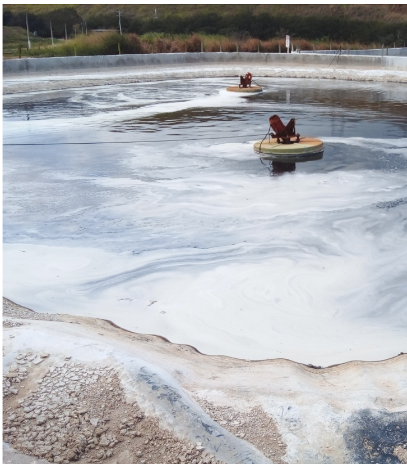
Figura 8: Primeira Lagoa de chorume com aerador em funcionamento, que são equipamentos que trabalham na superfície das lagoas e têm função de oxigenar o chorume, acarretando um processo mais rápido de decomposição.
