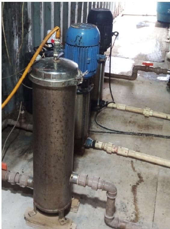
Figura 13 : Detalhe do equipamento de osmose reversa
