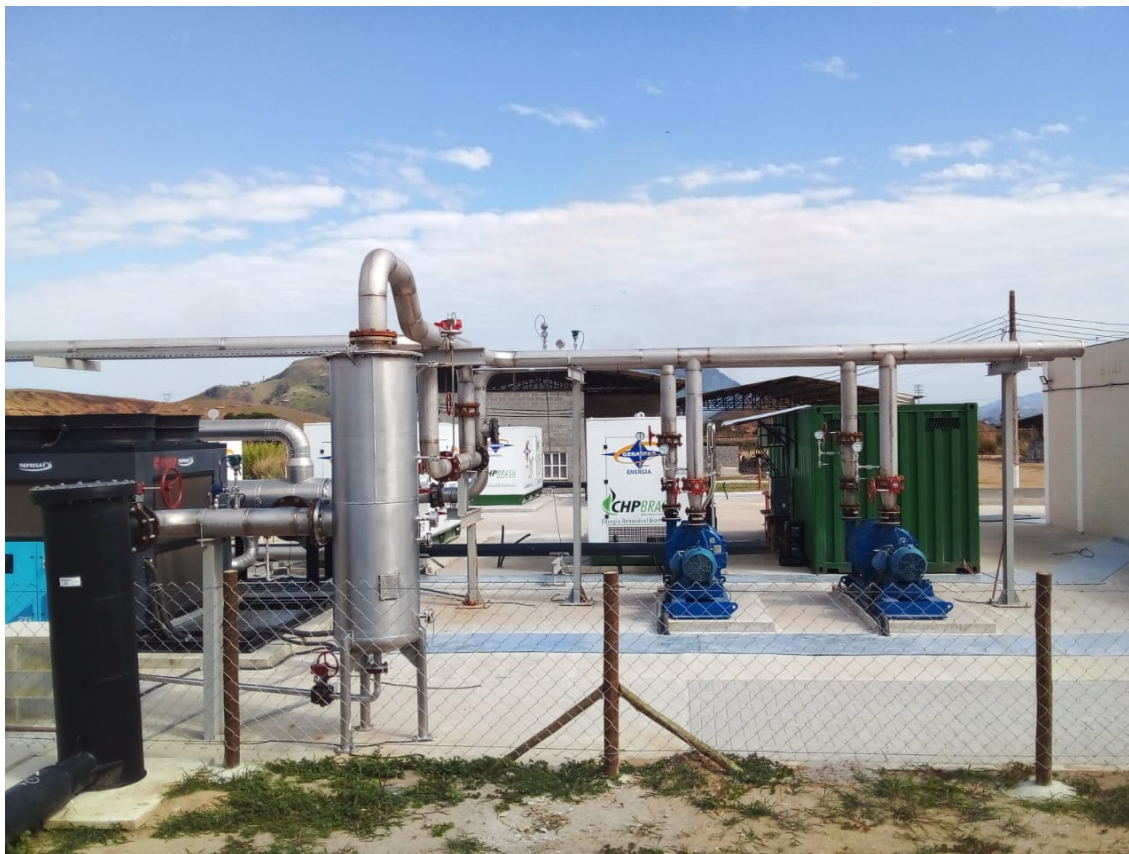
Figura 23: Vista dos motores da estação.
