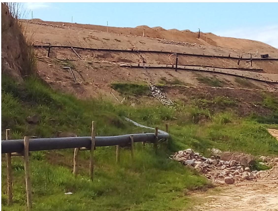
Figura 20: Vista das camadas do maciço e dos dutos de biogás.
