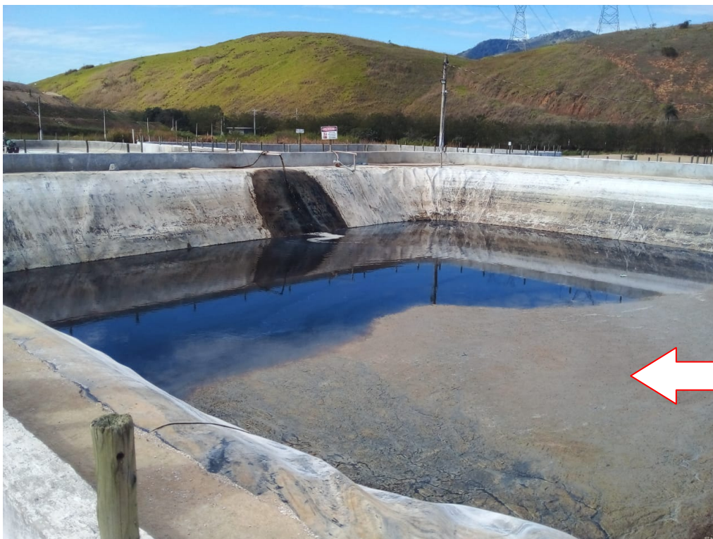
Figura 10: Segunda lagoa de chorume em manutenção para a retirada do lodo acumulado. Detalhe do lodo pela seta.
