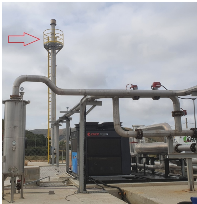
Figura 8: Vista do flare, queimador de biogás.
