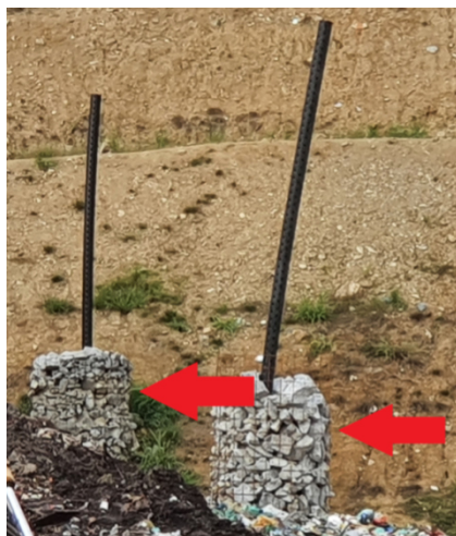
Figura 23: Vista dos dutos secundários de biogás
