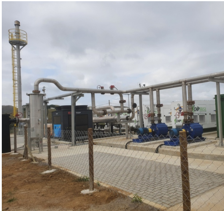
Figura 7: Vista da Estação de biogás.
