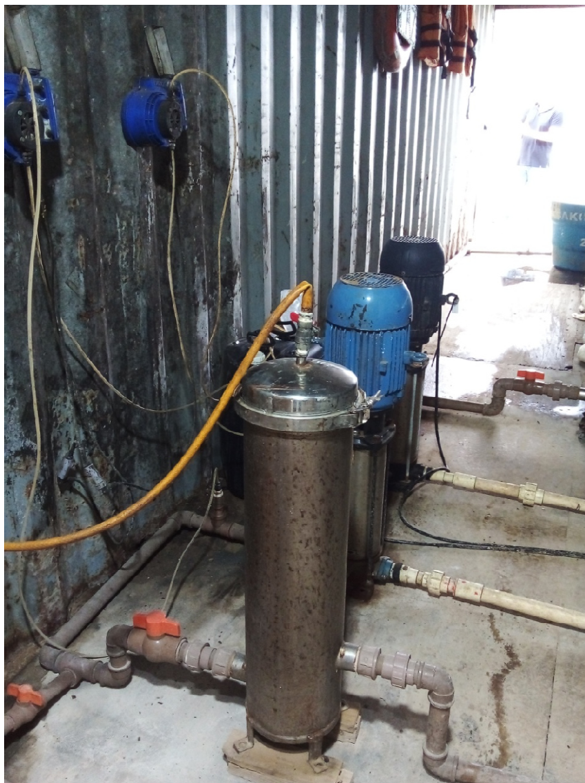
Figura 14 : Detalhe do equipamento de osmose reversa
