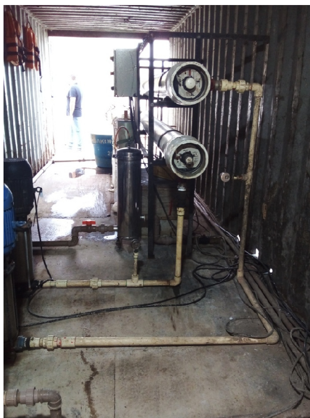
Figura 13 : Detalhe do equipamento de osmose reversa
