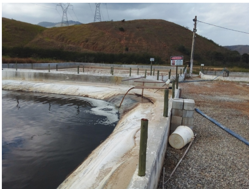
Figura 12: Lagoa de tratamento de chorume.
