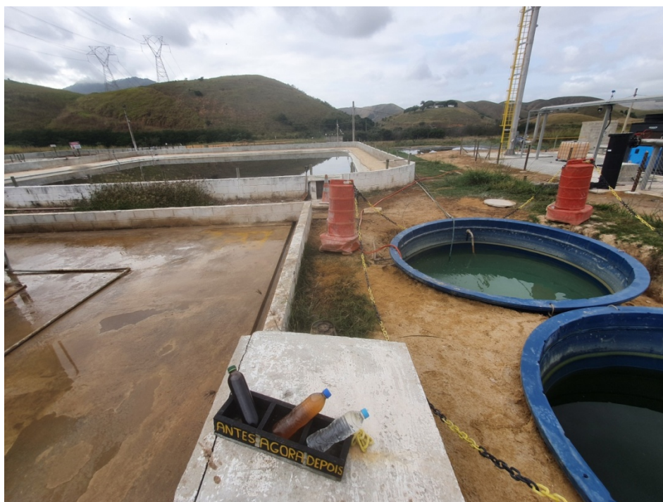
Figura 16: Vista da lagoa de tratamento de chorume ao fundo, à direita observa-se o reservatório do efluente após o tratamento e, à frente, pode ser visto o comparativo em garrafas entre o efluente antes, durante e após o tratamento
