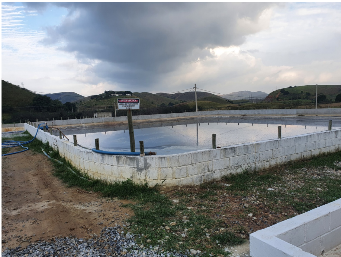
Figura 04: Lagoa de tratamento de chorume.
