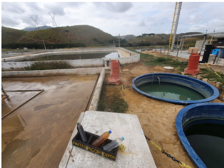
Figura 12: Vista da lagoa de tratamento de chorume ao fundo, à direita observa-se o reservatório do efluente após o tratamento e, à frente, pode ser visto o comparativo em garrafas entre o efluente antes, durante e após o tratamento.
