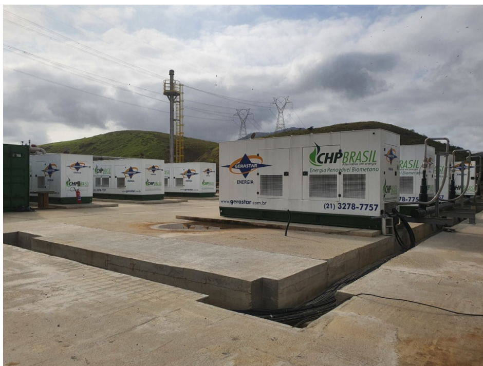
Figura 22: Vista dos motores da estação.
