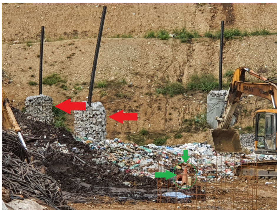
Figura 18: Vista dos dutos secundários de biogás (sinalizados em vermelho) e do primário, onde aparece um cone, sinalizado em verde.
