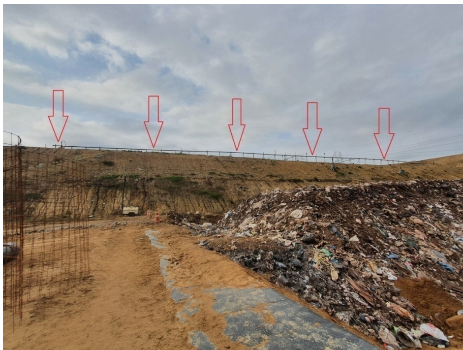
Figura 17: Vista dos dutos de biogás.
