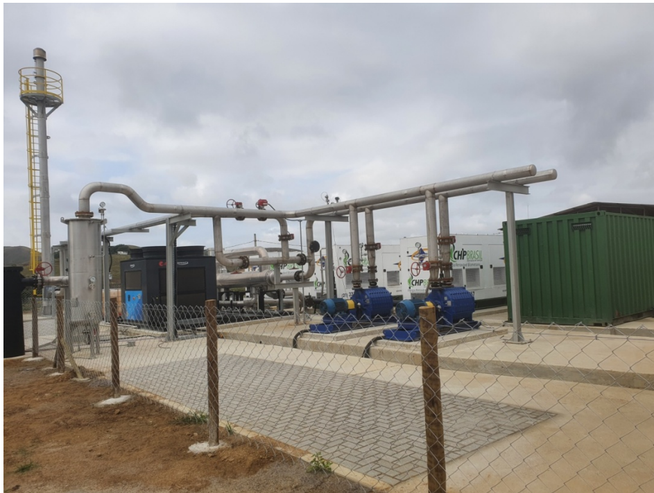
Figura 20: Vista da Estação de biogás.
