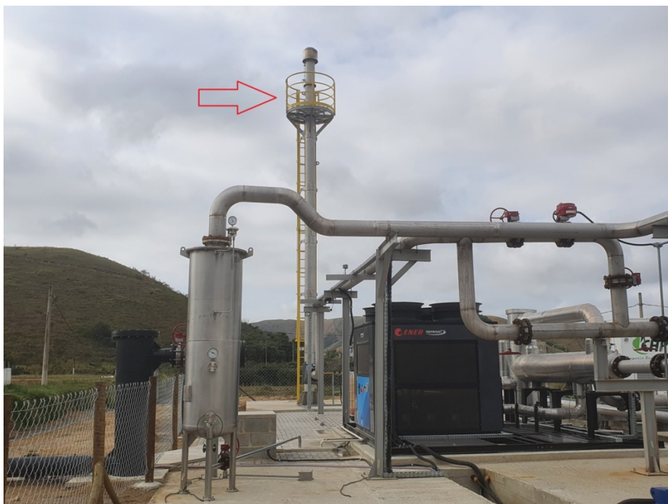
Figura 21: Vista do flare, queimador de biogás.
