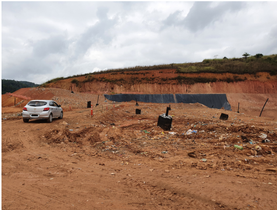
Figura 11: Vista da célula b, etapa 2, com resíduos descobertos espalhados fora da frente de trabalho.
