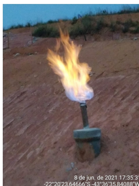
Figura 17: Vista do dreno vertical de gás no momento da queima de biogás, iniciada em 08/06/21. Imagem disponibilizada pelo gerente operacional do CTDR/Vassouras.
