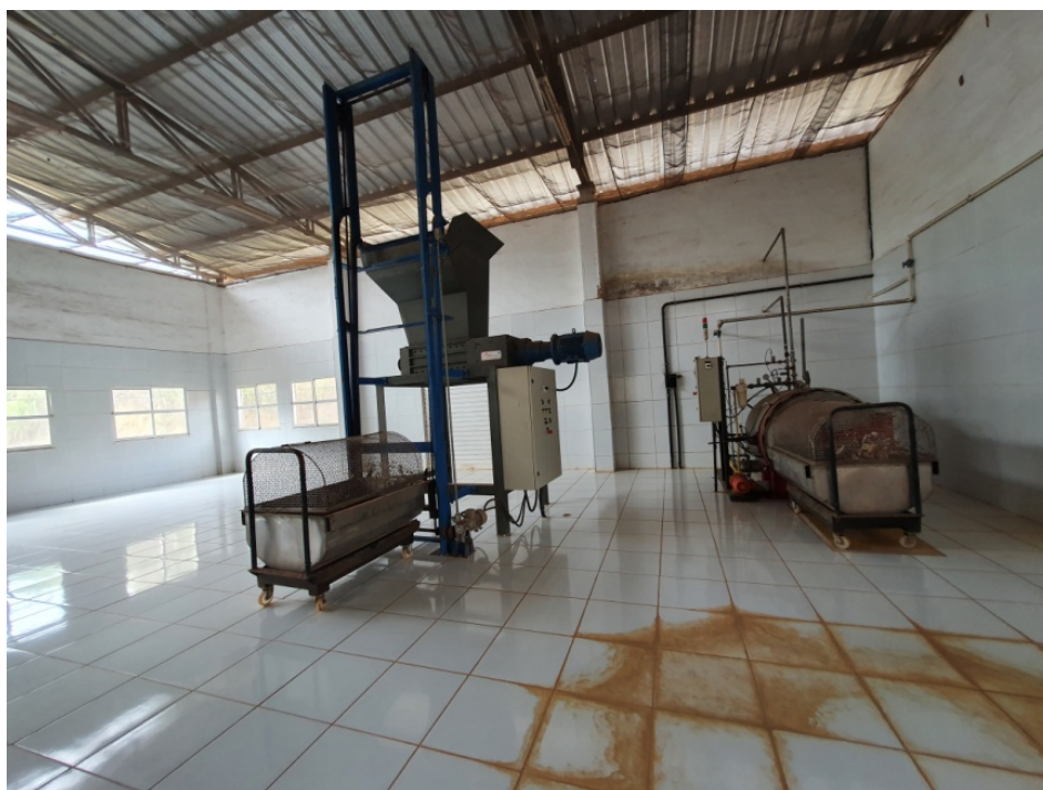
Figura 19: Autoclave disponibilizada para realizar o tratamento de RSS. Inoperante.
