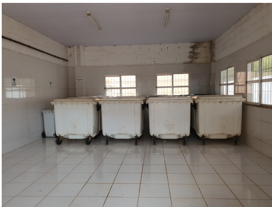
Figura 18: Abrigo temporário de RSS. Onde os resíduos são estocados até serem direcionados para a SERVIOESTE, empresa contratada para realizar a autoclavagem.
