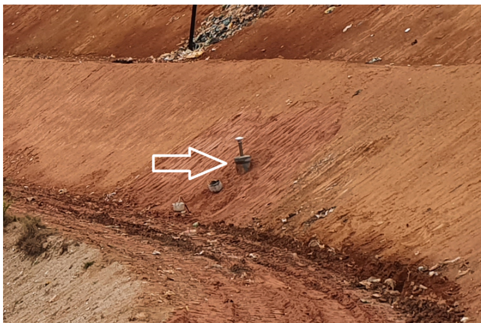
Figura 16: Vista do dreno vertical de gás com a presença do “chapéu chinês” para a realização da queima de biogás.
