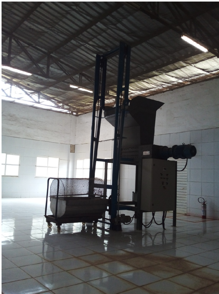
Figura 18: Autoclave disponibilizada para realizar o tratamento de RSS. Inoperante.
