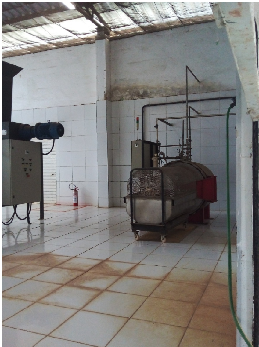
Figura 19: Autoclave disponibilizada para realizar o tratamento de RSS. Inoperante
