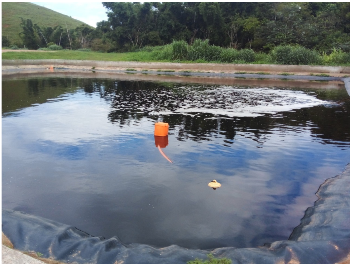
Figura 11: Lagoa de recebimento e armazenagem de chorume.
