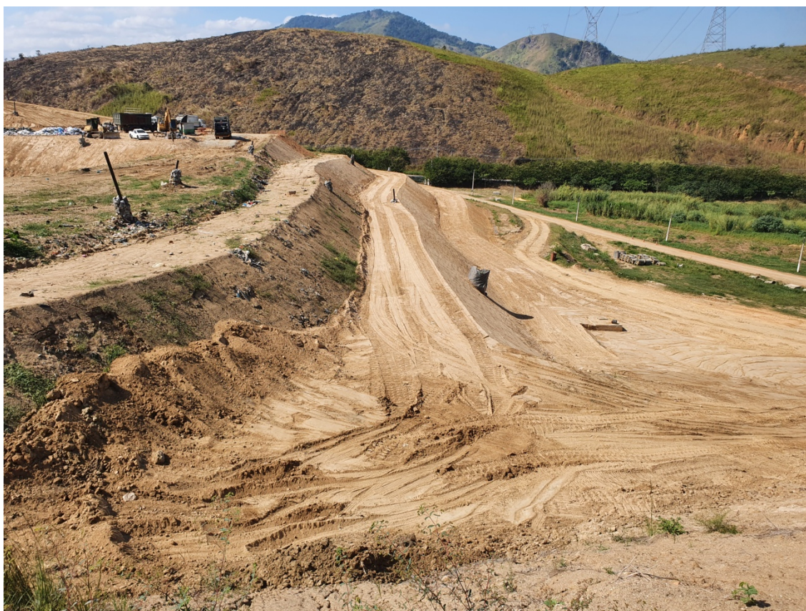
Figura 04: Talude sem cobertura vegetal, suscetível a erosão.
