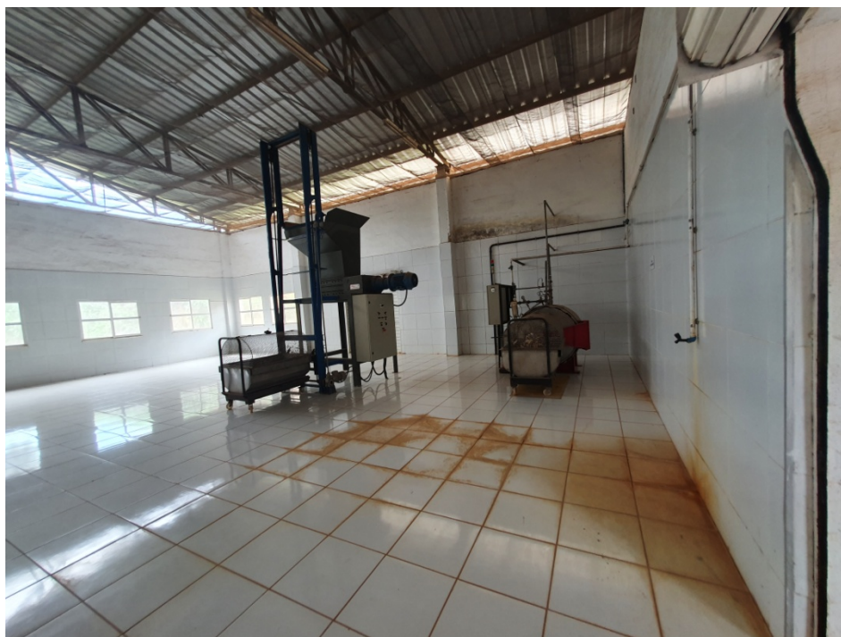
Figura 16: Autoclave disponibilizada para realizar o tratamento de RSS. Inoperante.
