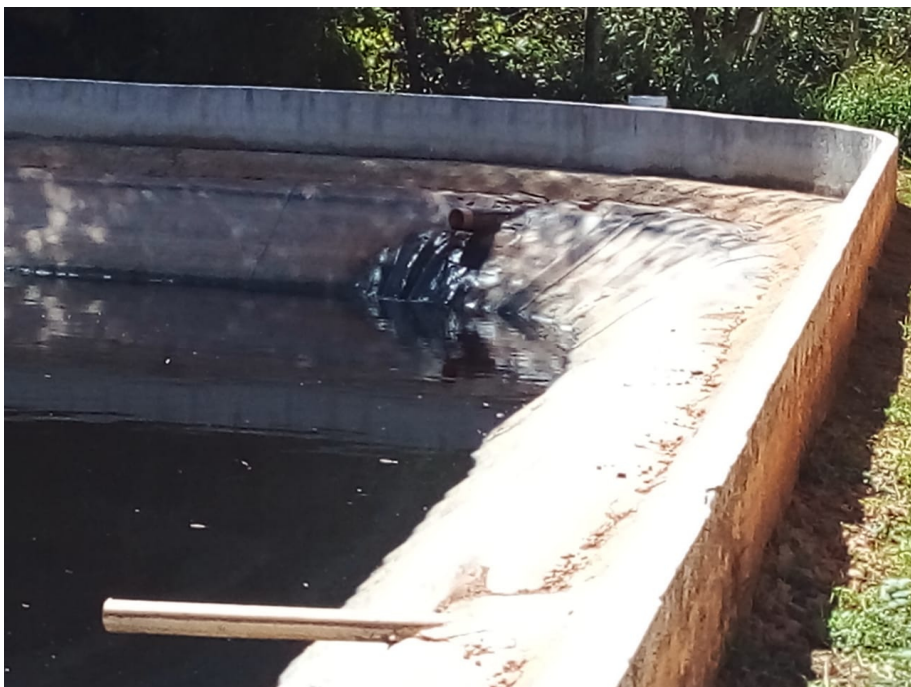
Figura 09: Lagoa de recebimento de chorume.
