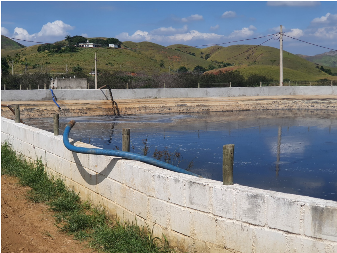
Figura 06: Lagoa de tratamento de chorume.
