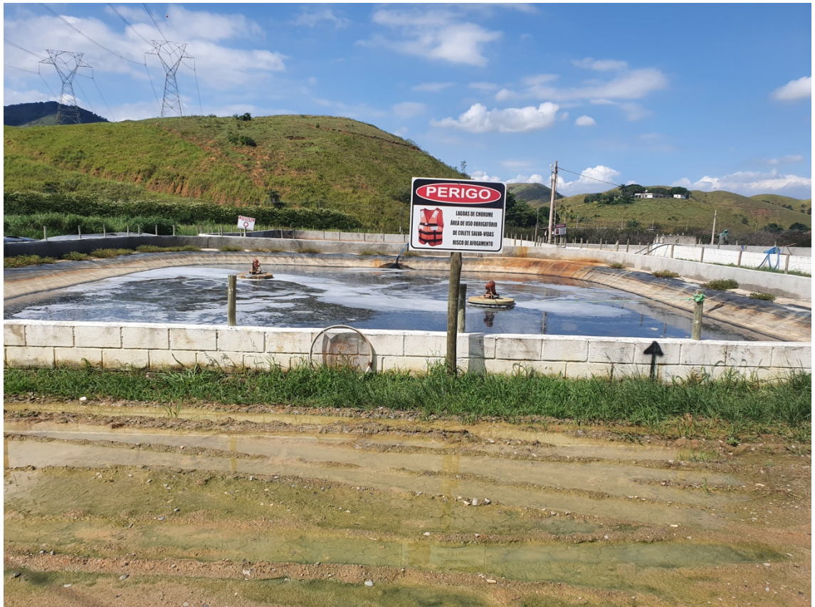
Figura 05: Lagoa de chorume com aerador em funcionamento.
