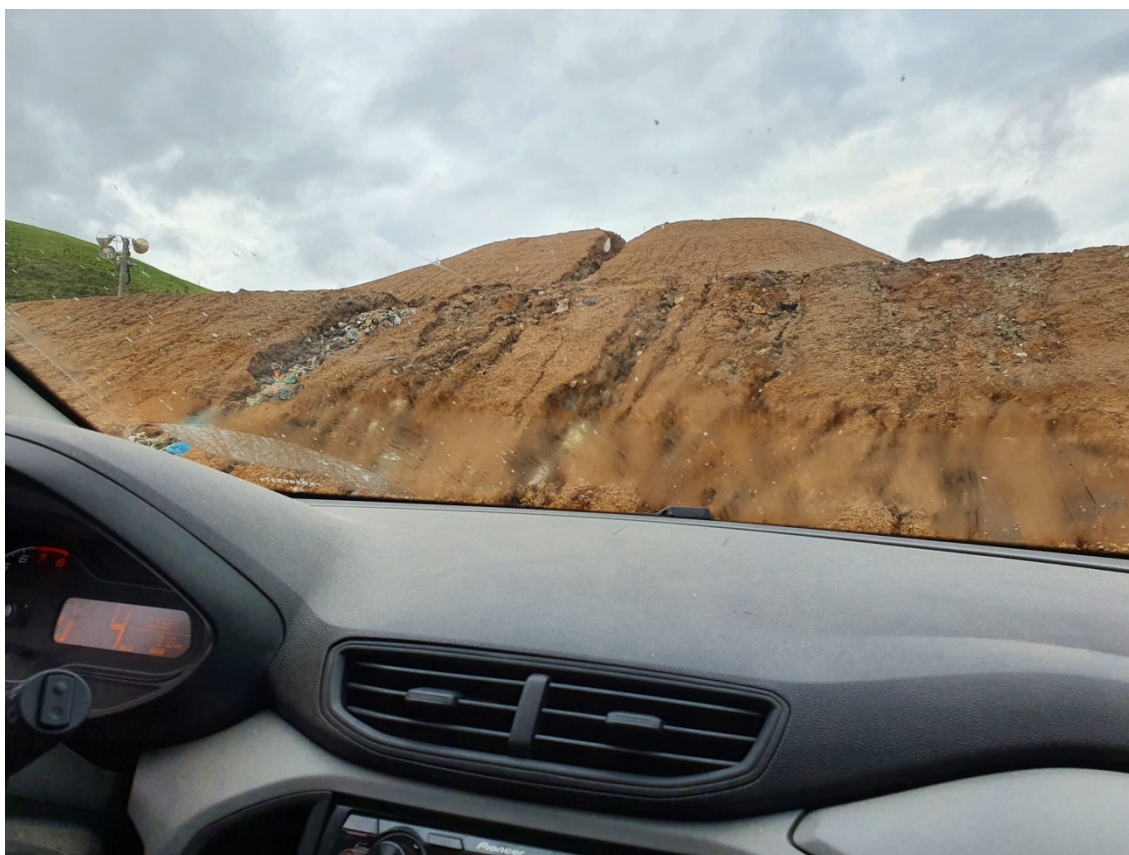
Figura 05: Vista de um talude sem cobertura vegetal sendo suscetível há erosão e descobrimento do resíduo.
