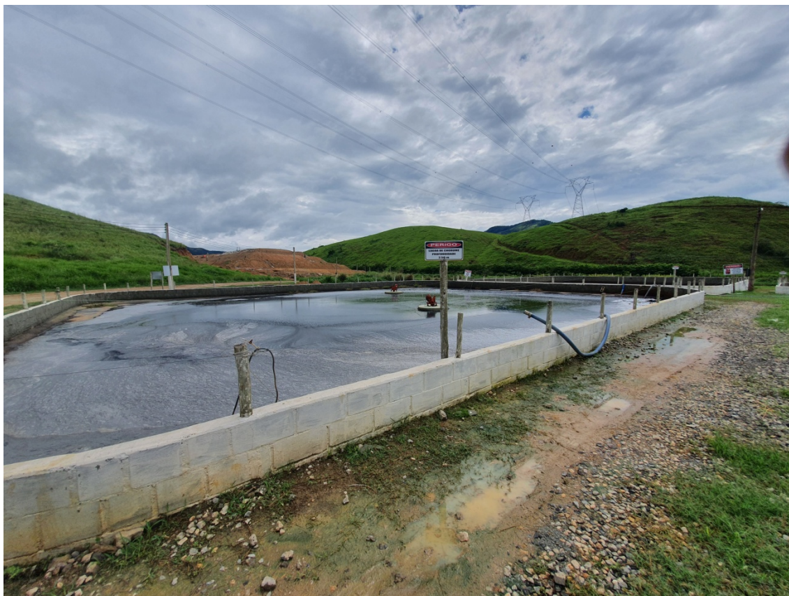
Figura 08: Lagoa de chorume com aerador sem funcionar no momento da vistoria.
