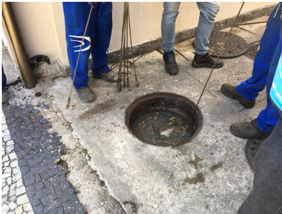
CAIXA DE PASSAGEM/INSPEÇÃO DE ESGOTO NO EDIFÍCIO (ENTUPIDA)
