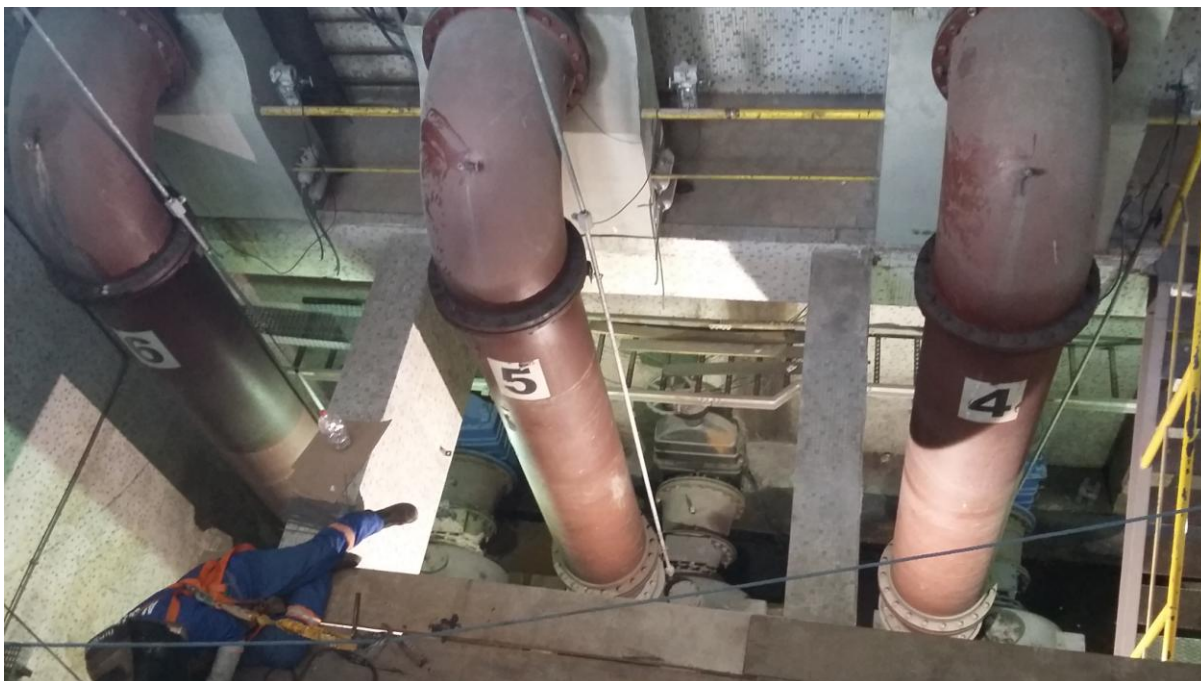
SISTEMA DE BOMBEAMENTO EM OPERAÇÃO
