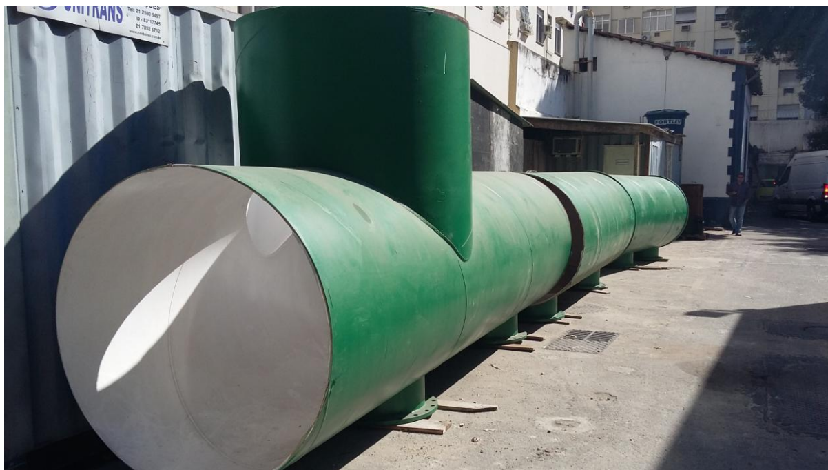
NOVO BARRILETE DE INTERLIGAÇÃO
