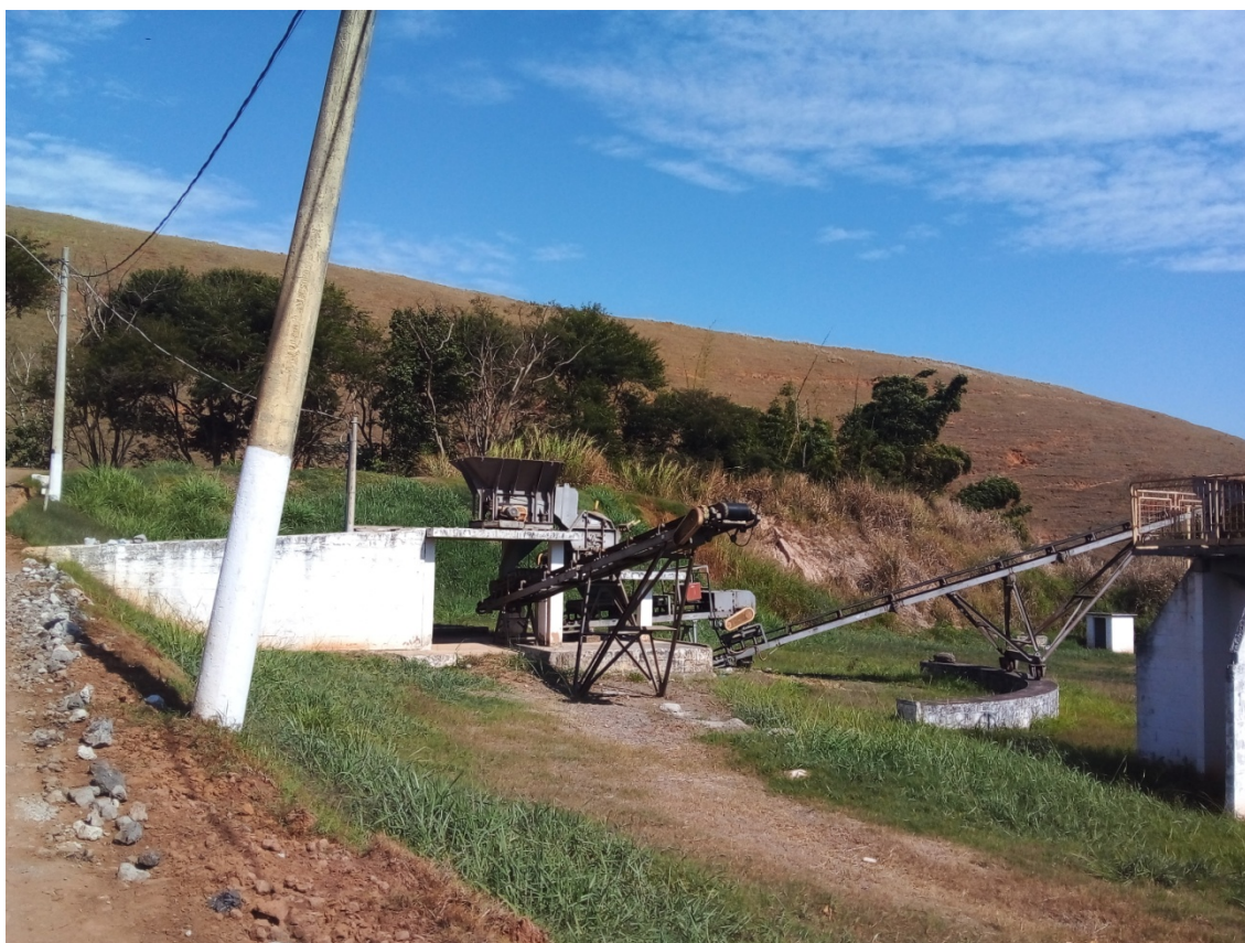
Figura 14: Britador de resíduos da construção civil. Há um funcionamento muito abaixo do esperado ,esporadicamente tem sido posto em operação
