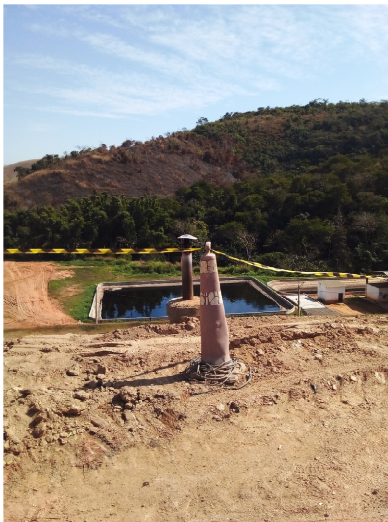
Figura 10: Vista de um dos queimadores e a lagoa de armazenamento de chorume ao fundo.
