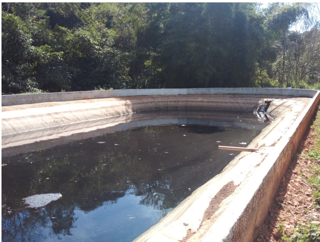
Figura 8: Lagoa de recebimento e armazenamento de chorume.
