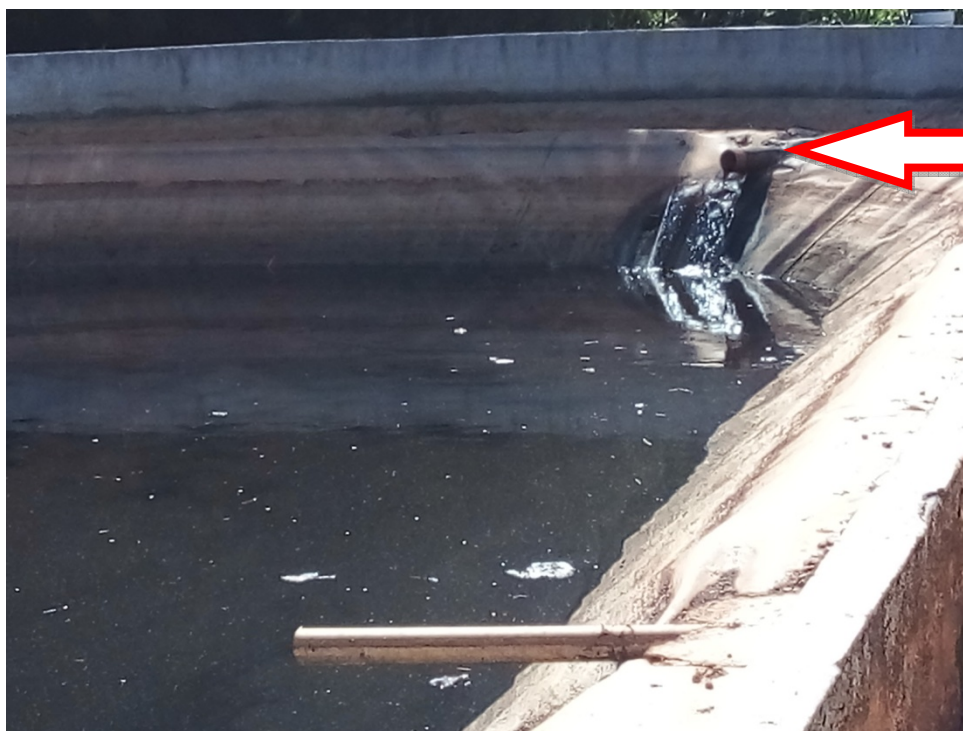
Figura 9: Lagoa de recebimento de chorume. Detalhe ao fundo destacando o recebimento do chorume gerado pela célula .
