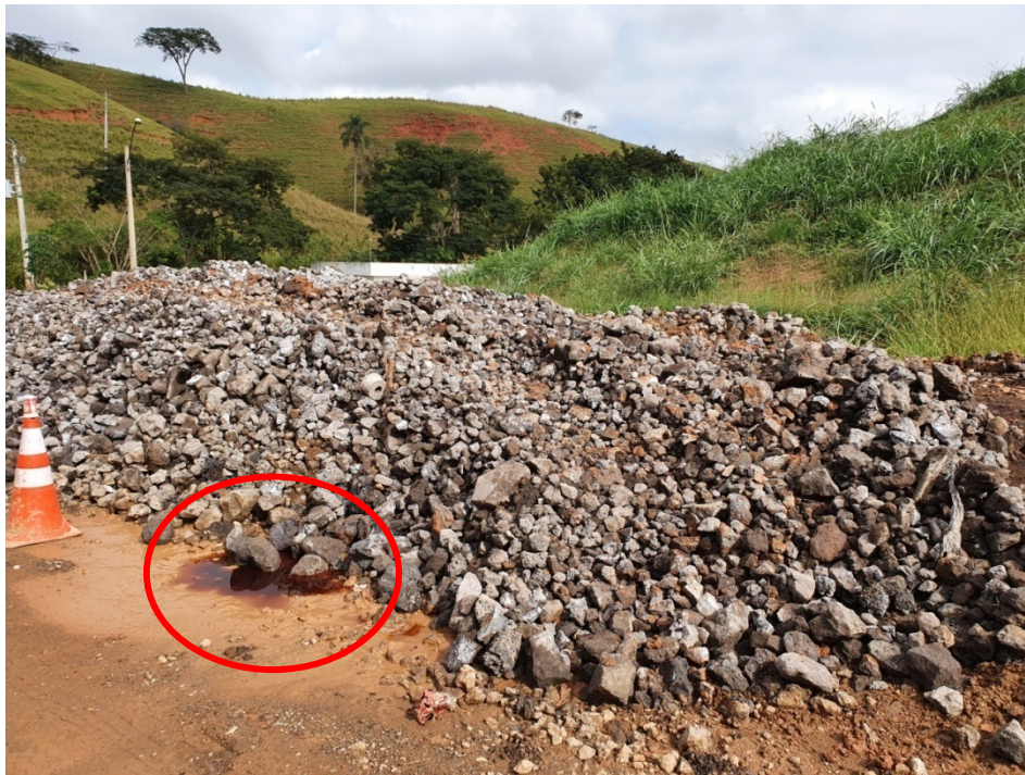
Figura 10: Material utilizado para pavimentação das vias. É possível notar poça de chorume, conforme circulado. A mesma está localizada próximo à célula A, a qual necessita de remediação.
