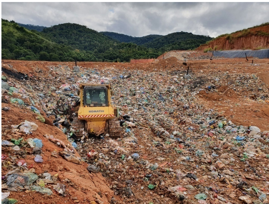
Figura 5: Vista da frente de trabalho. Visível a grande quantidade de resíduos expostos.
