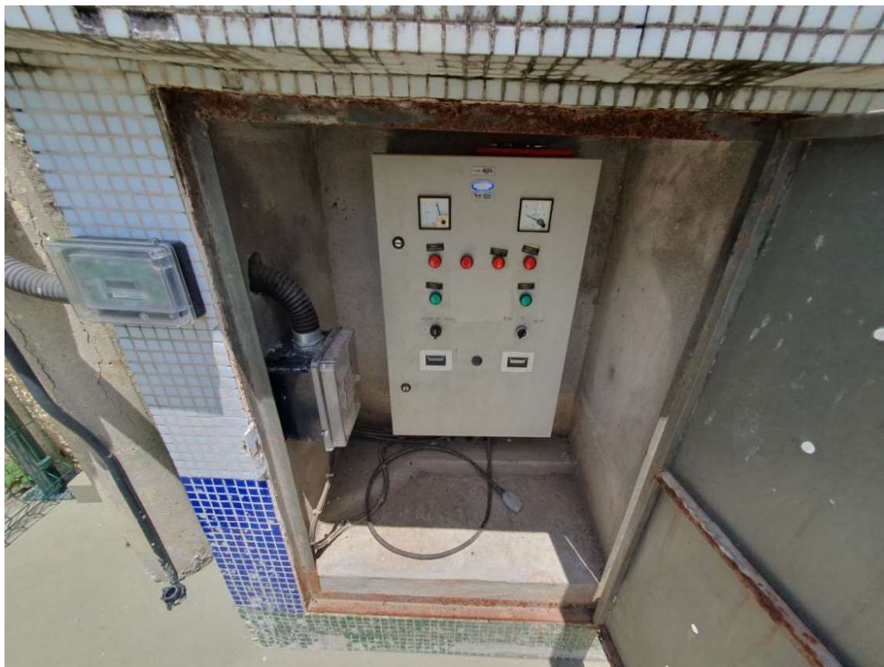
Quadro de comando
