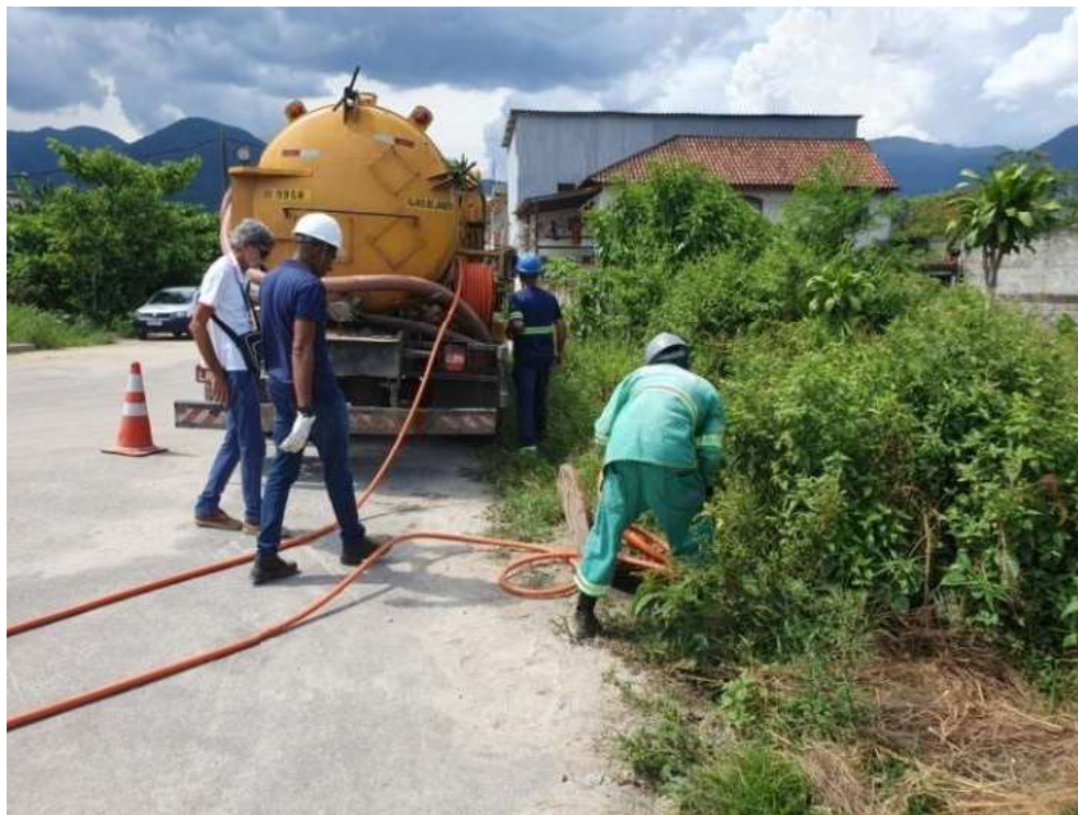
Equipe da Iguá tentando desobstruir o PV externo
