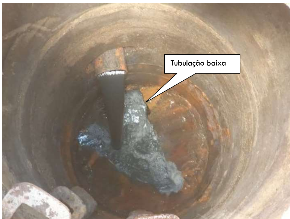
Esgoto retido na obstrução escoando após limpeza da tubulação alta, pois a baixa saiu barro caracterizando tudo quebrado.
