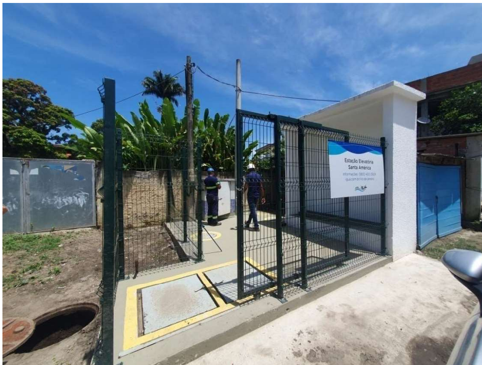
Estação Elevatória de Esgoto Santa América
