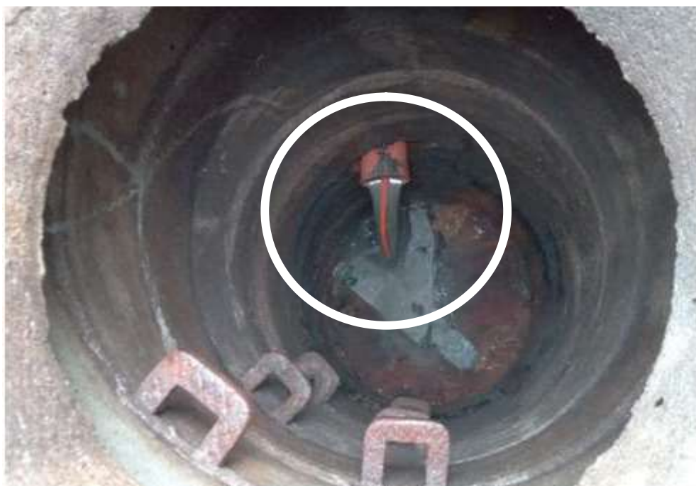
Mangueira no PV externo
