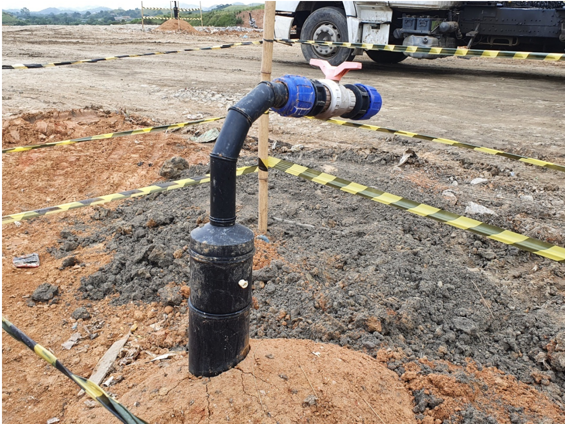
Figura 05: tubulação do Bio gás.
