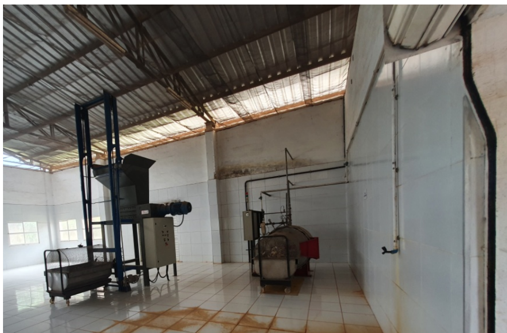
Figura 07: Autoclave disponibilizada para realizar o tratamento de RSS. Inoperante.
