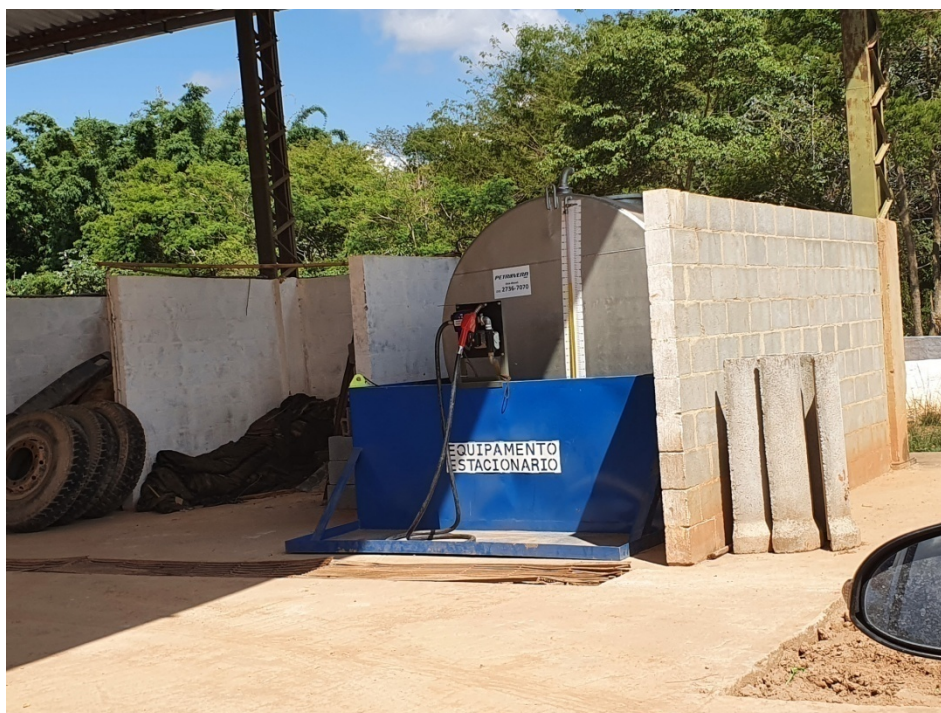
Figura 10: Tanque para armazenamento de combustível a ser utilizado nos equipamentos operantes.
