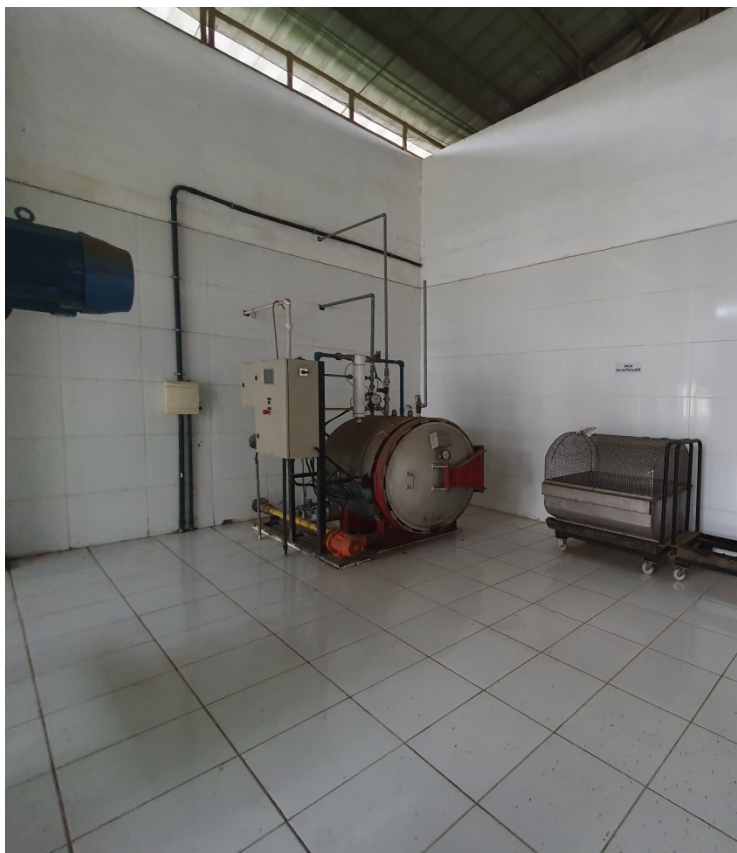
Figura 7 Captação do biogás
