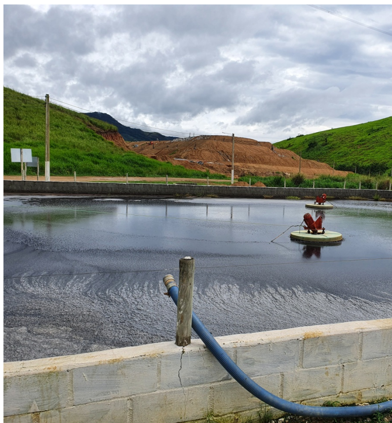
Figura 5: Lagoa de chorume com aerador .
