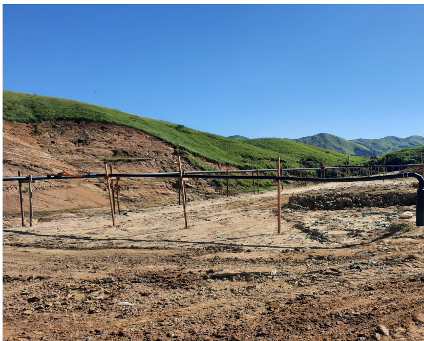
Figura 3 Captação do biogás.
