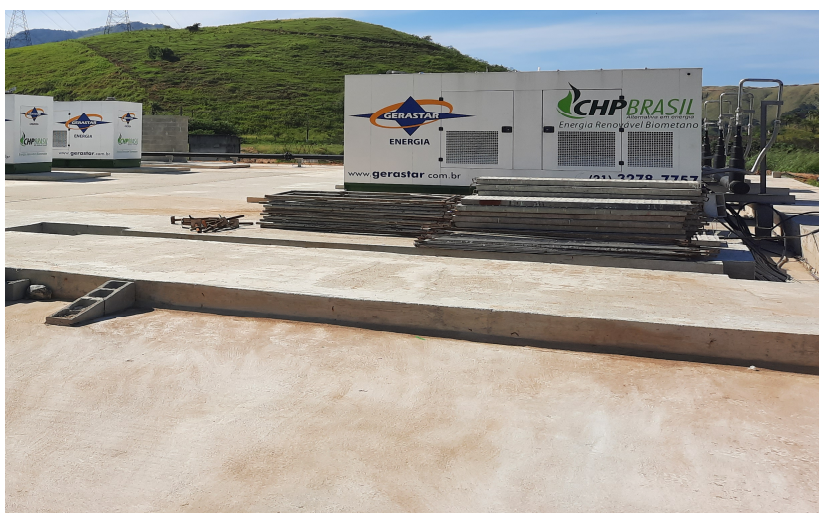
Figura 4 Motor gerador de energia , através do Biogás.
