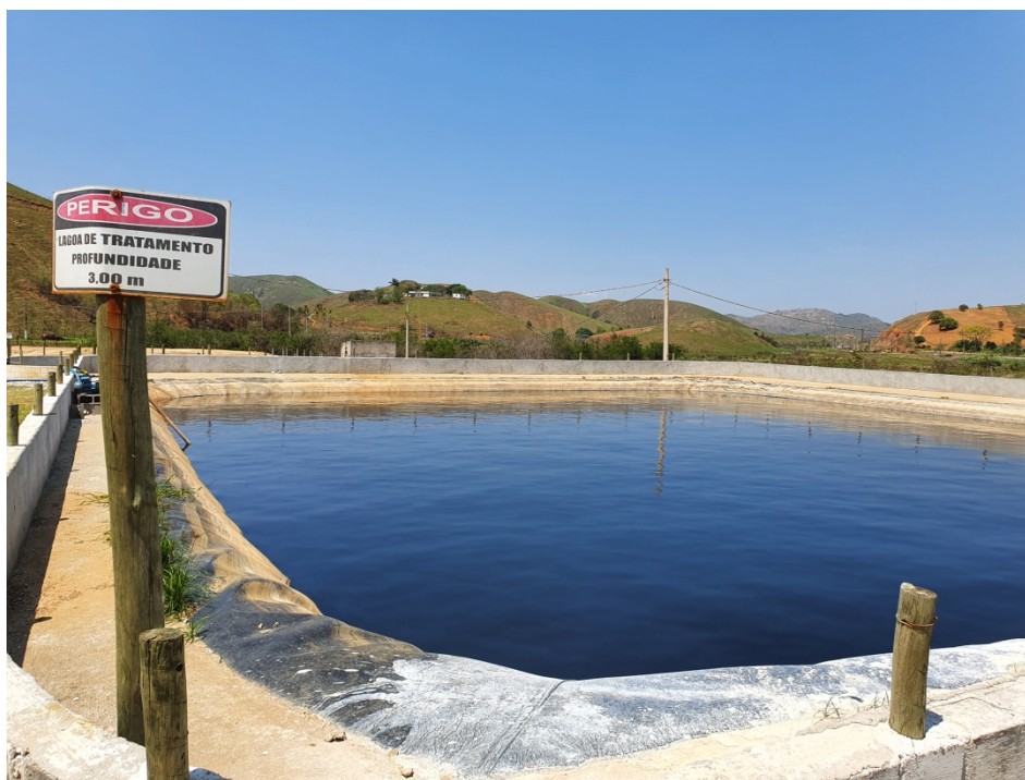
Figura 05: Lagoa de tratamento de chorume.
