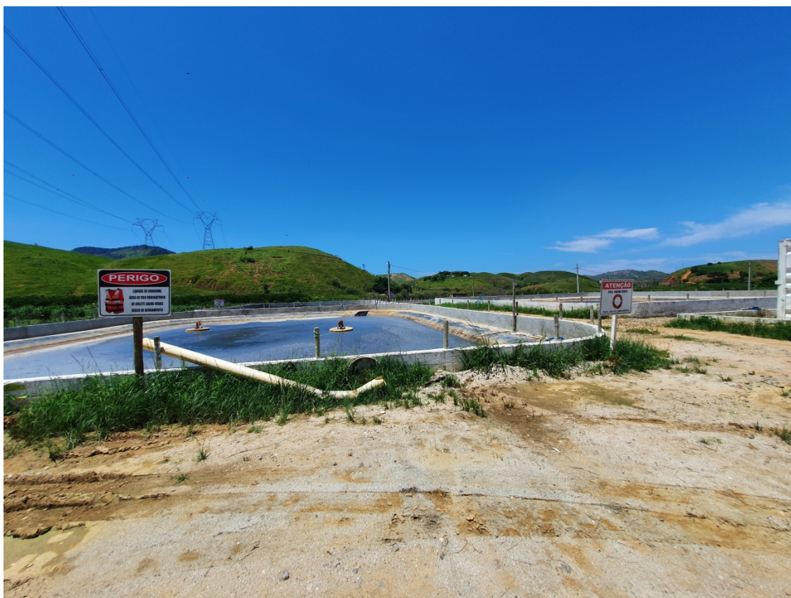
Figura 04: Lagoa de chorume com aerador sem funcionamento.
