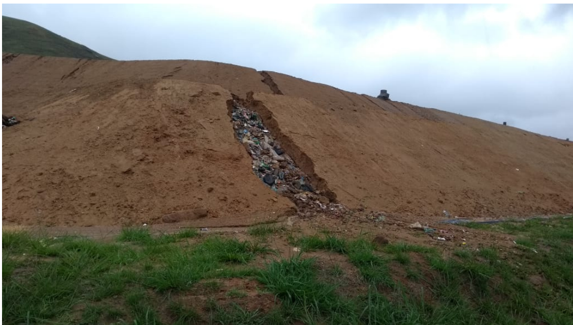
Figura 03: Talude sem cobertura vegetal, assim mais suscetível a erosão.
