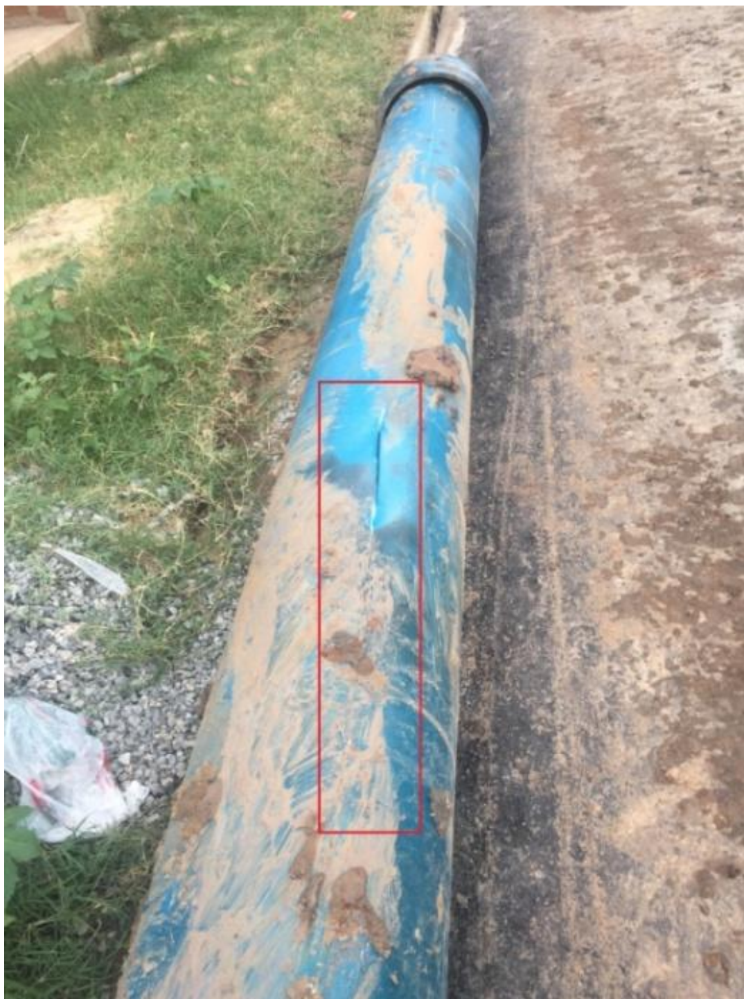
TUBULAÇÃO DANIFICADA E SUBSTITUÍDA
