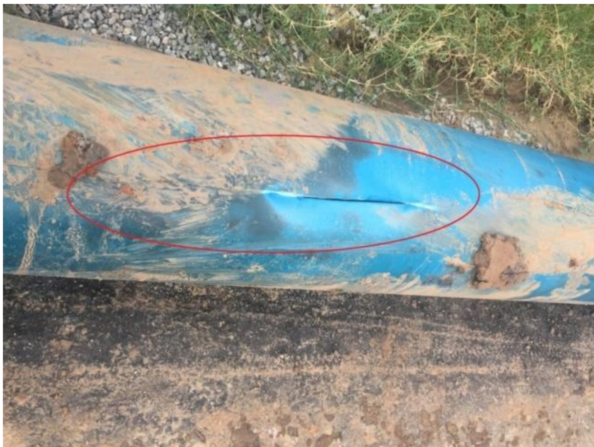
TUBULAÇÃO DANIFICADA E SUBSTITUÍDA
