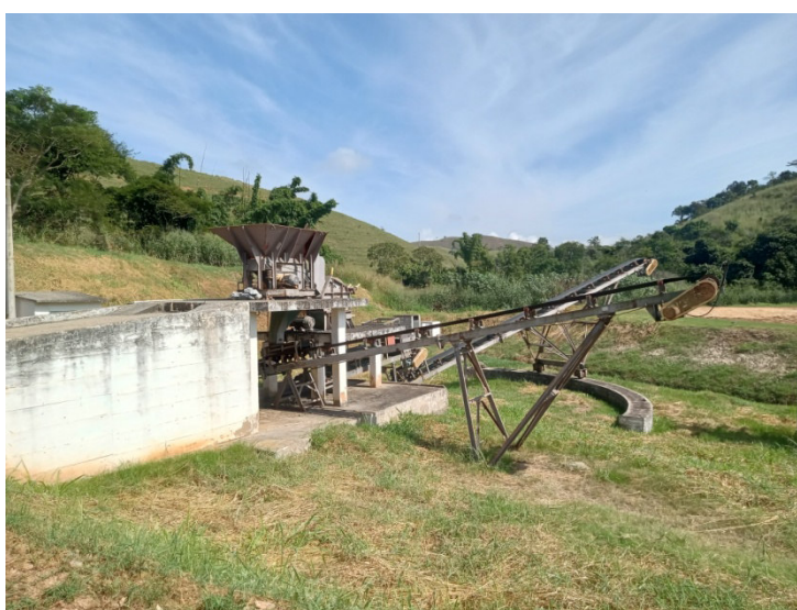
Figura 26: Britador de resíduos da construção civil. Há um funcionamento muito abaixo do esperado ,esporadicamente tem sido posto em operação
