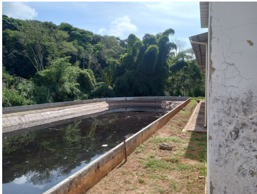
Figura 15: Lagoa de recebimento e armazenagem de chorume.
