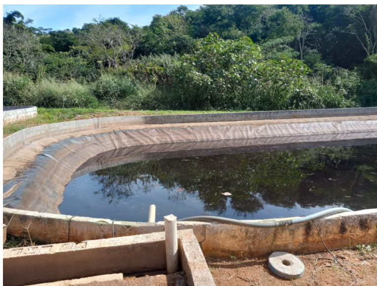
Figura 14: Lagoa de recebimento e armazenagem de chorume.
