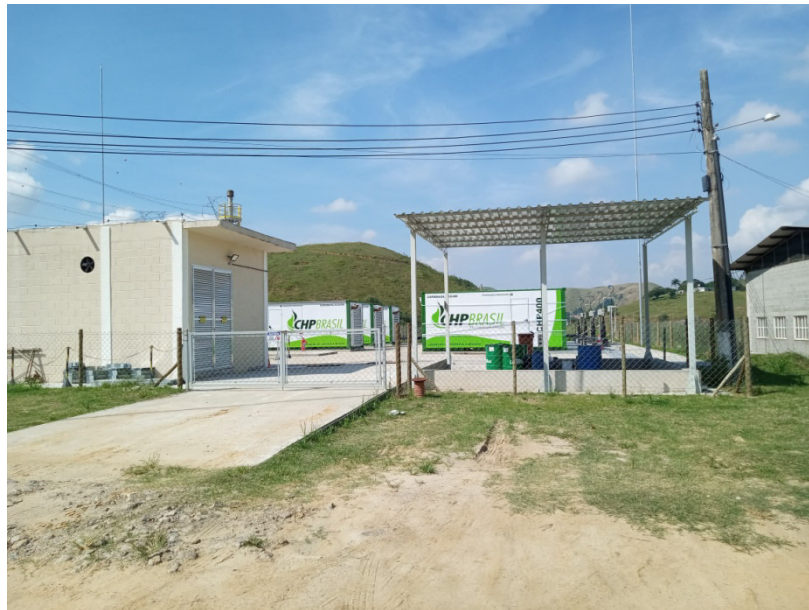
Figura 25: Vista dos geradores da estação de Biogás
