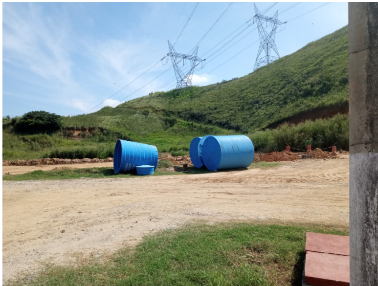
Figura 15: Novos tanques da estação de tratamento
