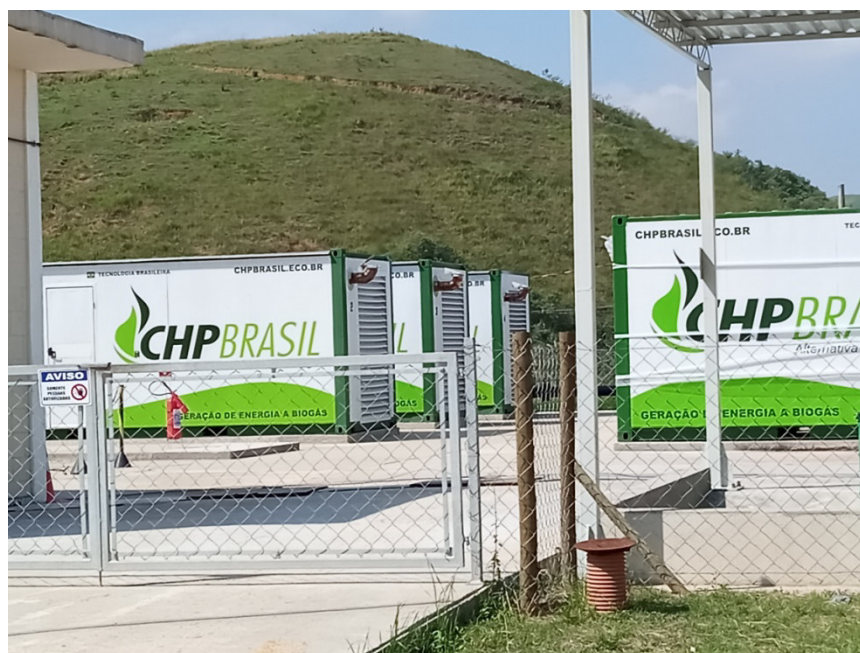
Figura 26: Vista dos geradores da estação de Biogás
