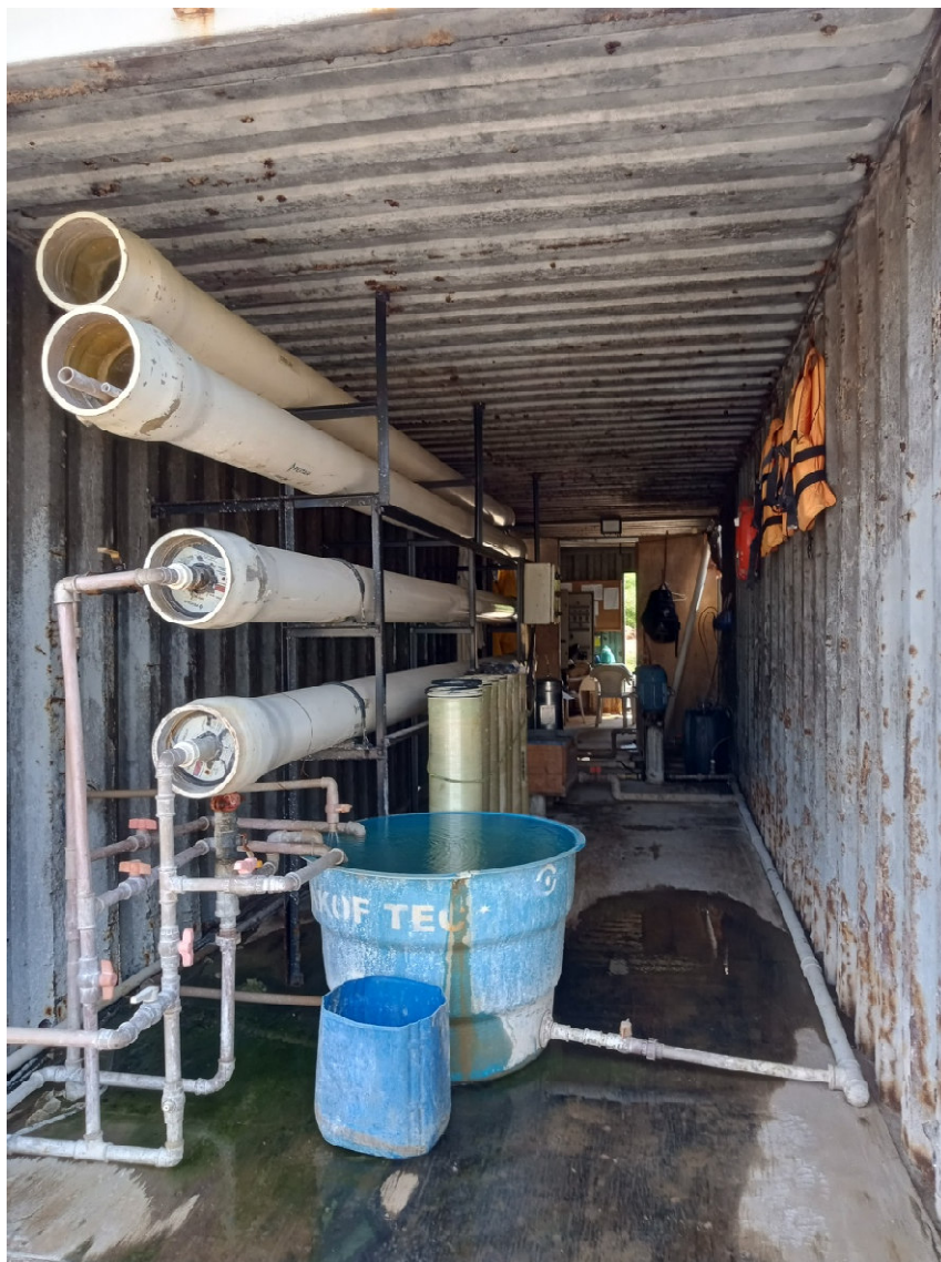
Figura 14 : Sistema de filtragem e membranas para a osmose reversa
