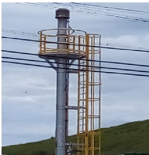
Figura 27: Flare da Estação de Biogás
