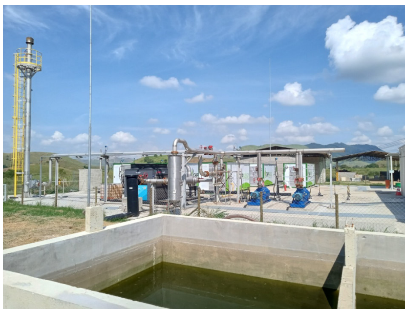
Figura 24: Estação de Biogás
