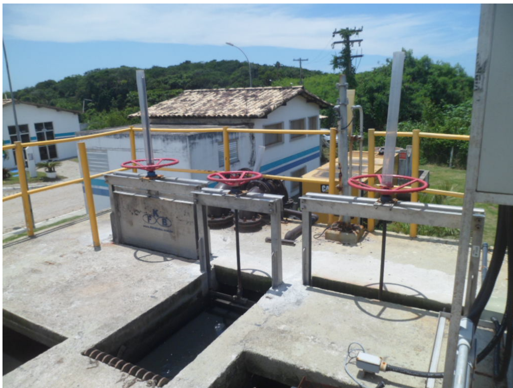
Foto 04 – Entrada do esgoto bruto In Natura 120 l/s
