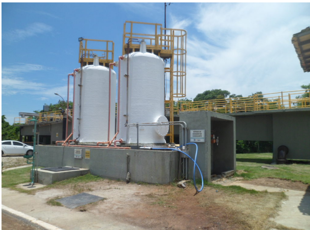
Foto 21 – Reservatórios de Policloreto de Alumínio (PAC)
