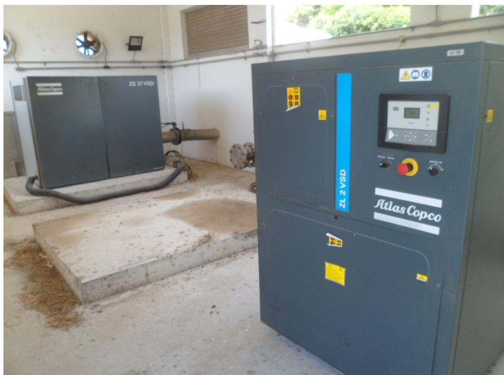
Foto 13 – Sala dos Sopradores que Lançam Cargas de Ar para o Tanque de Aeração
