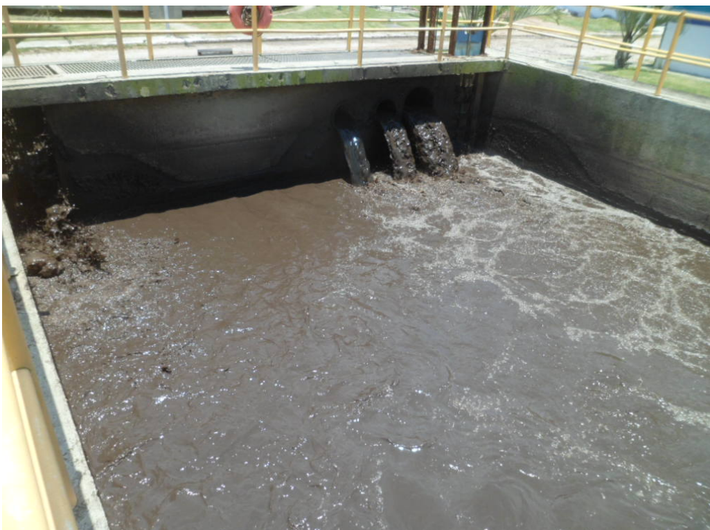
Foto 11 – Tanque Anóxico, Entrada do Esgoto Bruto e Lodo Recirculado
