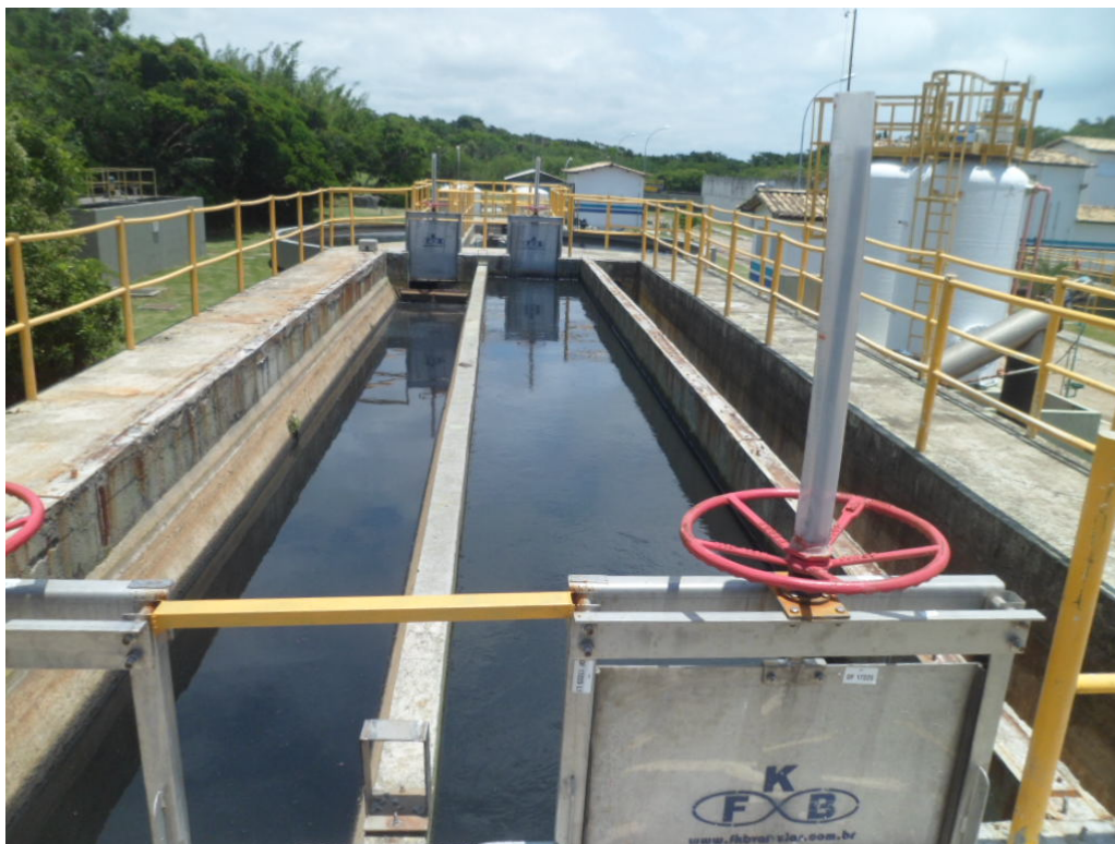
Foto 08 – Tanques de Areia
