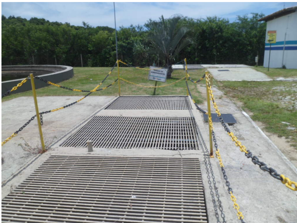
Foto 22 – Tanque de Desinfecção
