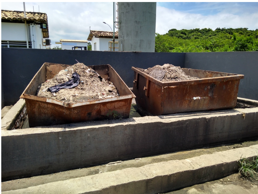
Foto 07 – Local de Recebimento de Caminhão Fossa (Caçambas deterioradas e com furos)
