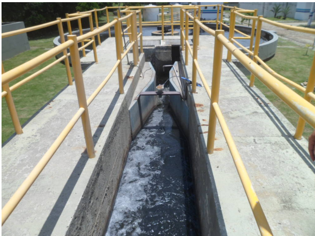
Foto 09 – Medidor de vazão Calha Parshall
