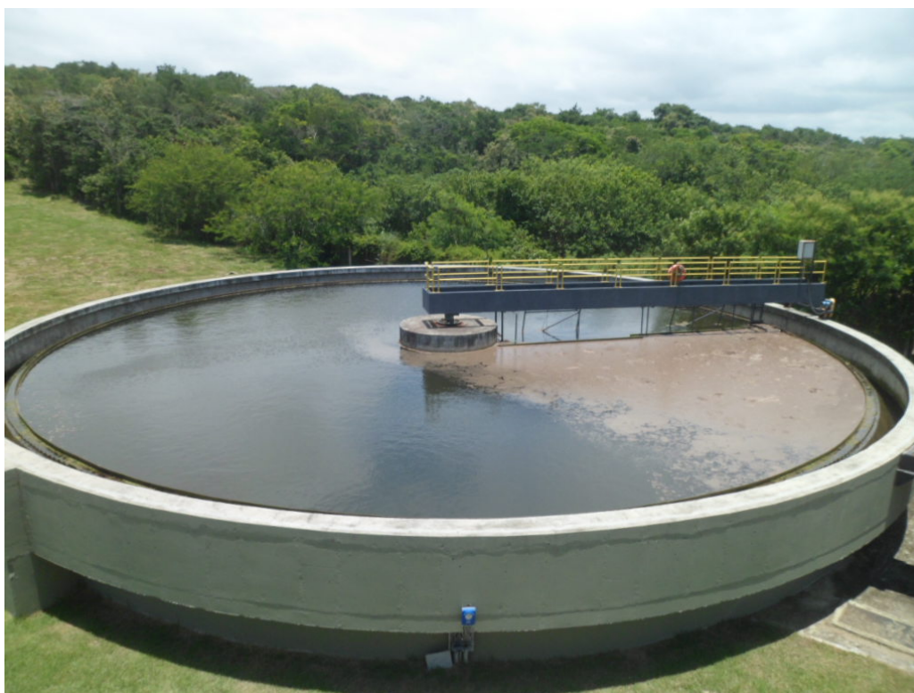
Foto 15 – Tanque de Decantação Secundário 02
