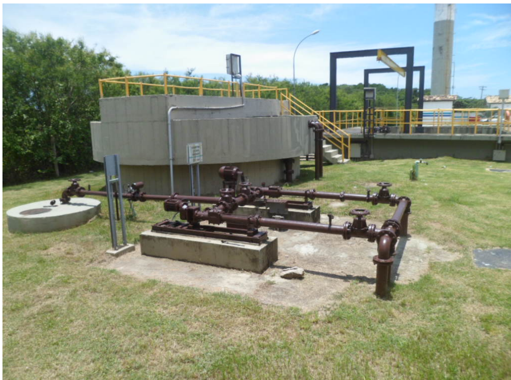
Foto 18 – Tubulação de Recalque do Lodo
