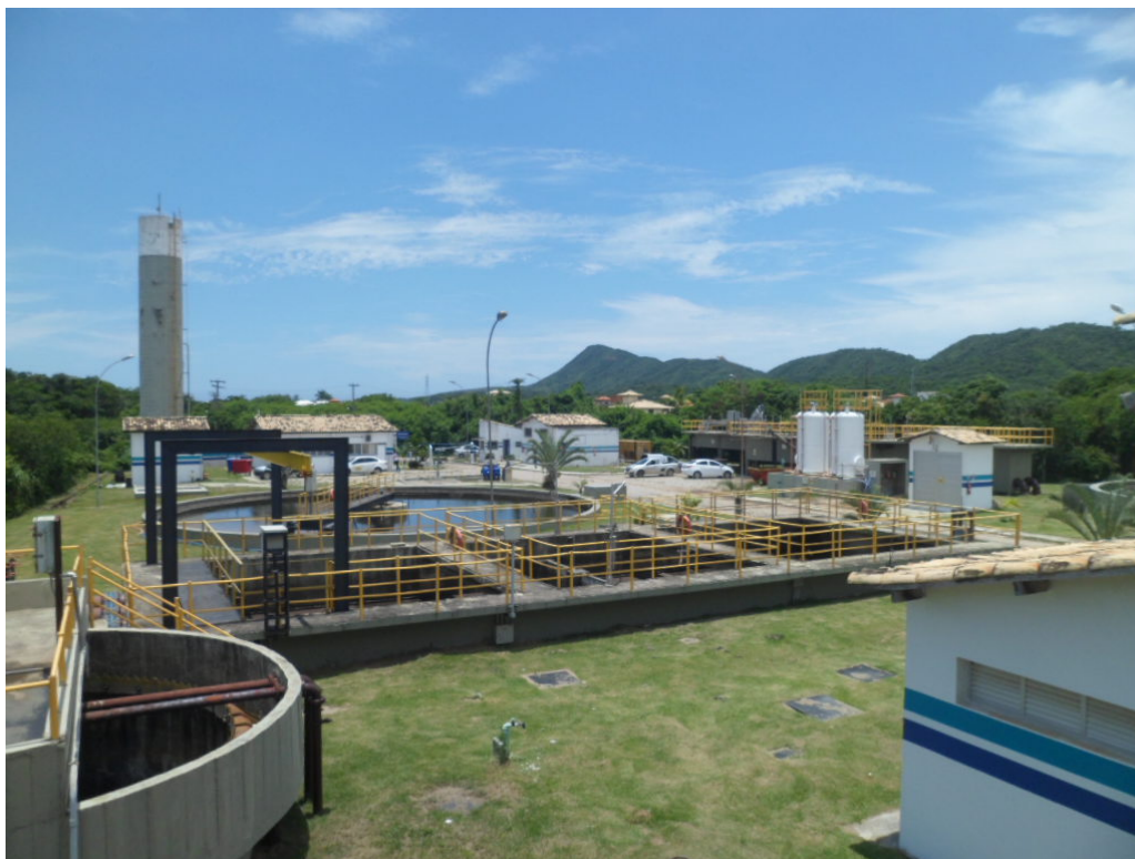
Foto 16 – Tanque de Decantação Secundário 03
