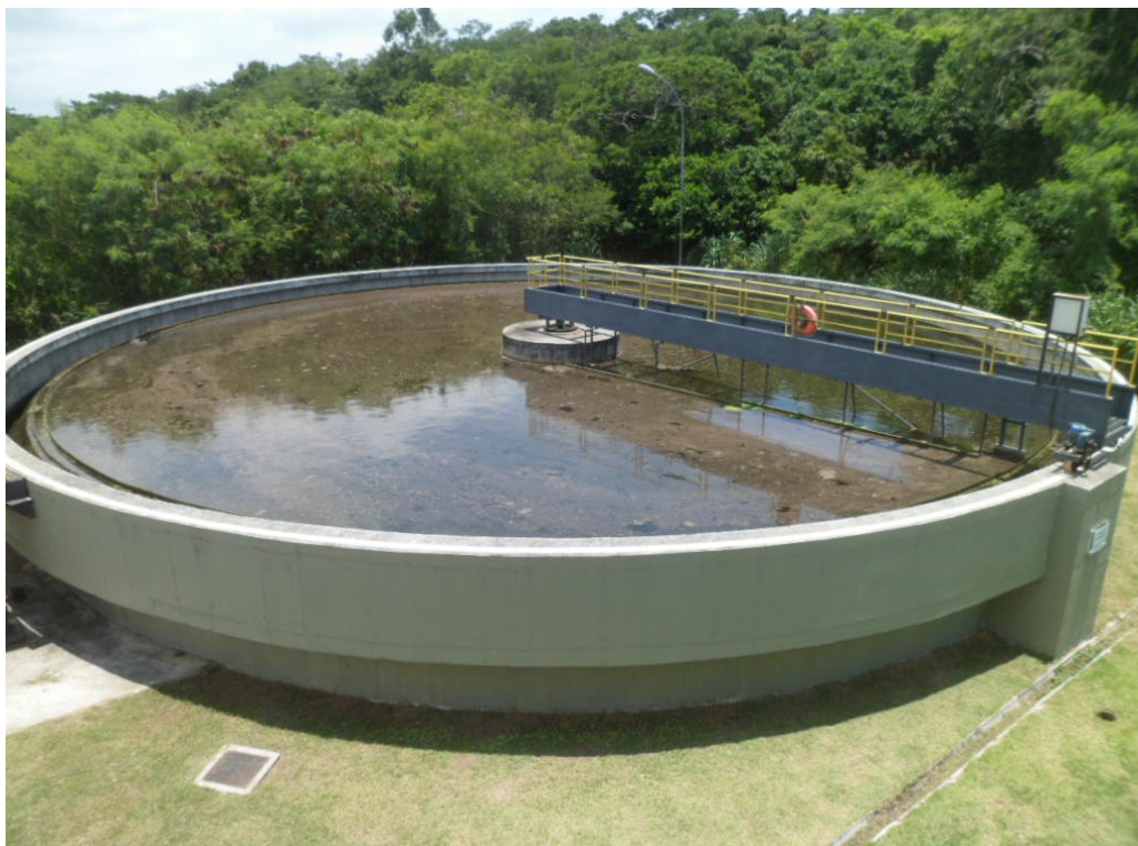
Foto 14 – Tanque de Decantação Secundário 01
