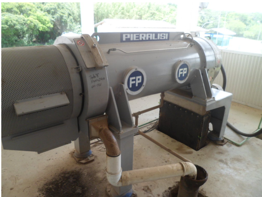
Foto 19 – Centrífuga de Desidratação do Lodo
