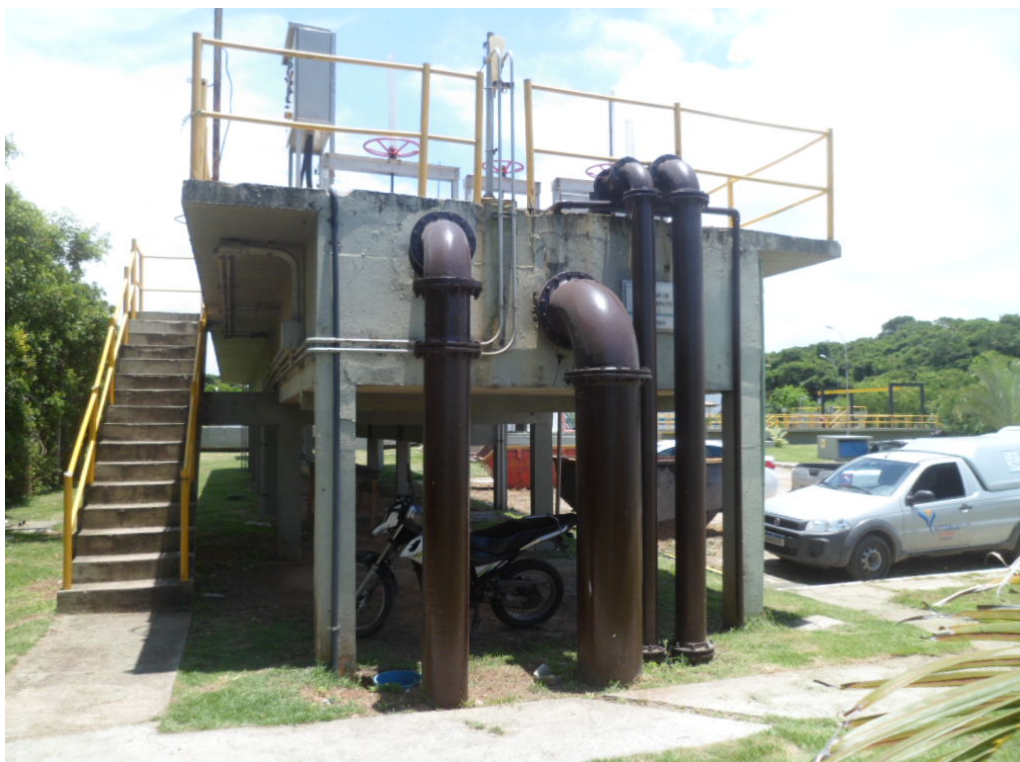
Foto 03 – Tubulações de Chegada do esgoto bruto
