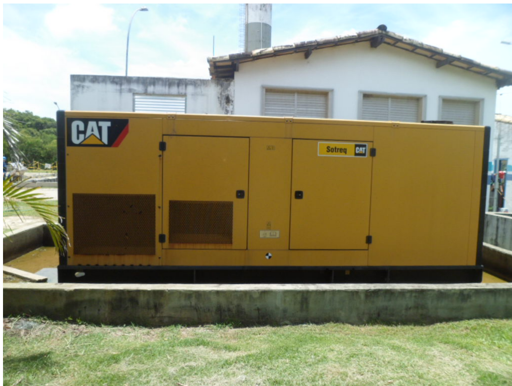
Foto 24 – Gerador da Estação
