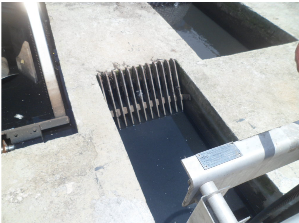
Foto 05 – Gradeamento na Entrada do Esgoto Bruto
