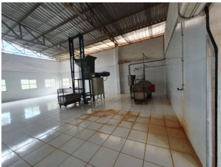
Figura 12: Autoclave disponibilizada para realizar o tratamento de RSS. Inoperante.
