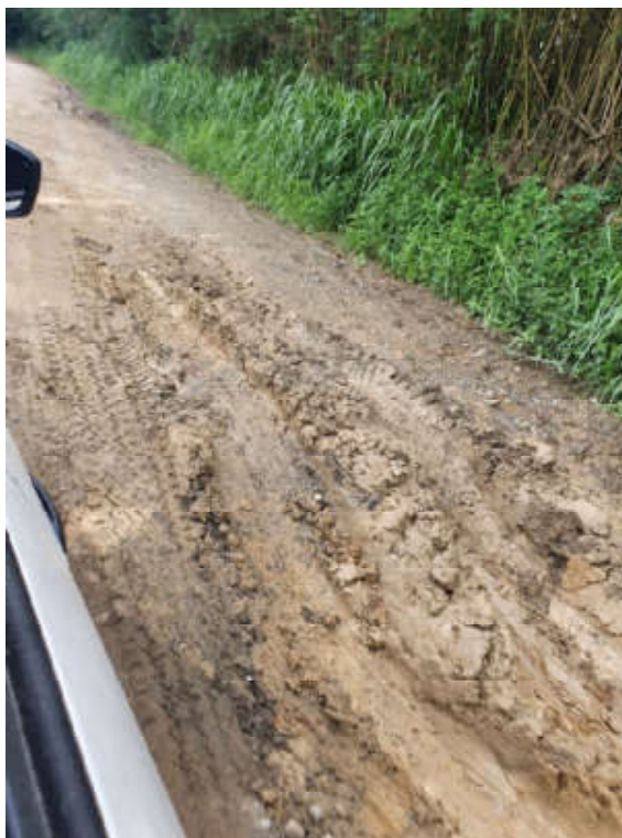
Figura 3: Parte da estrada onde apresenta umidade e buracos.
