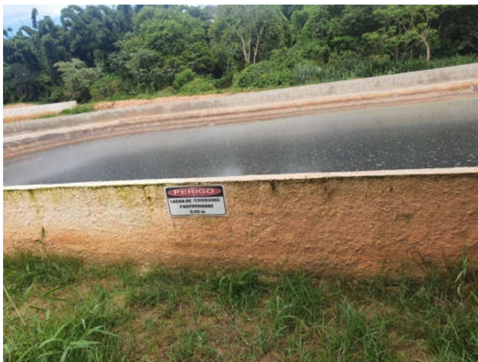
Figura 10: Lagoa de armazenamento de chorume, cujo efluente é recolhido por caminhões para posterior tratamento.
