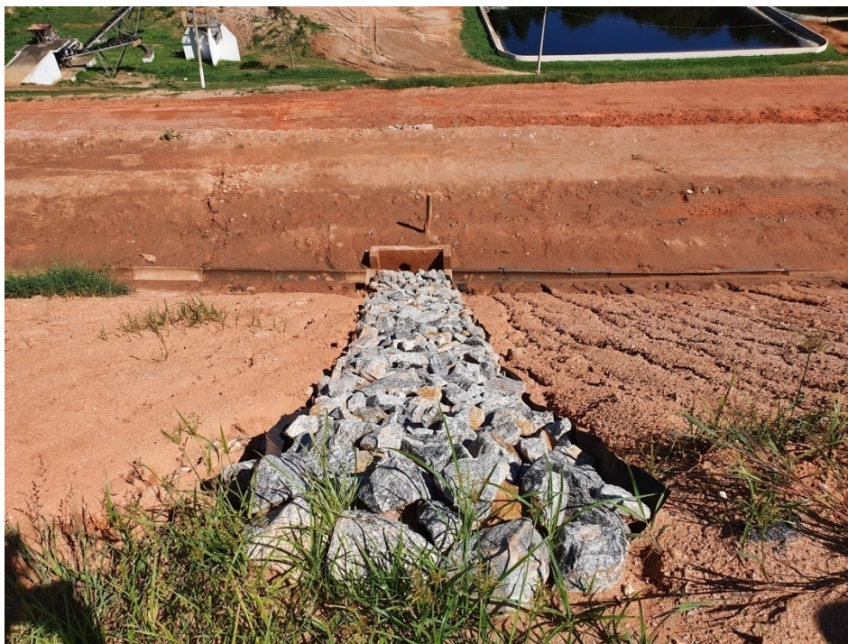
Figura 8: Vista do colchão reno, utilizado para drenagem de água pluvial.
