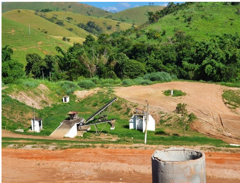
Figura 10: Britador de resíduos da construção civil.
