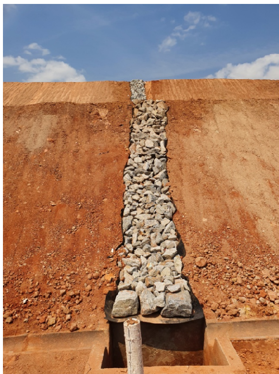
Figura 10: Dreno de água pluvial.
