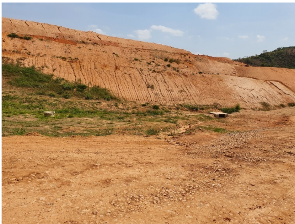
Figura 9: Vista de taludes da célula b concluídos e apresentando erosões devido à ausência de cobertura vegetal.
