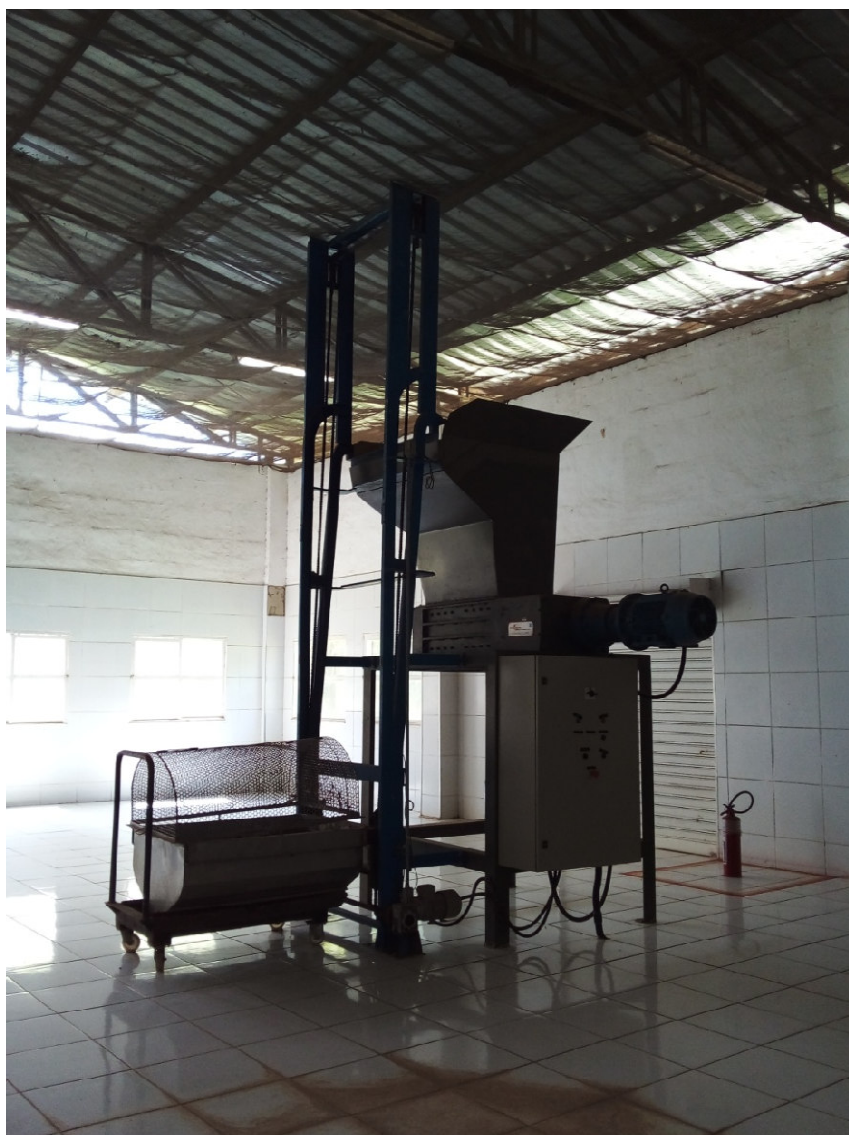
Figura 23: Autoclave disponibilizada para realizar o tratamento de RSS. Inoperante.
