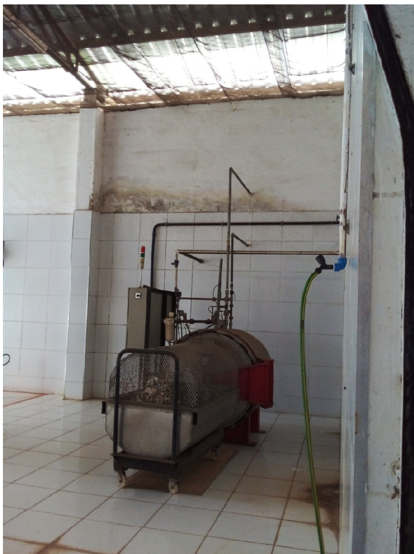
Figura 24: Autoclave disponibilizada para realizar o tratamento de RSS. Inoperante
