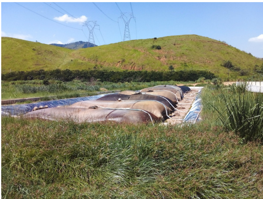
Figura 24: Bags de armazenagem e secagem do lodo
