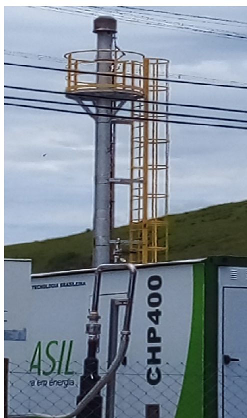
Figura 31: Flare da Estação de Biogás
