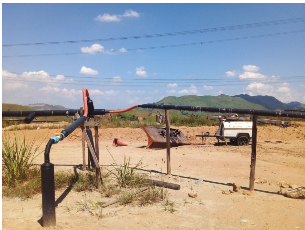
Figura 11: Dutos coletores de gás
