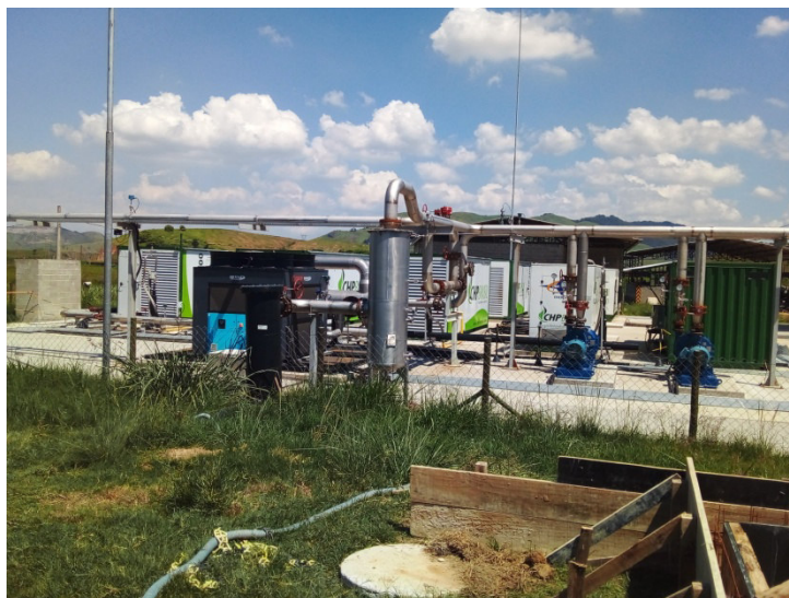
Figura 29: Estação de Biogás
