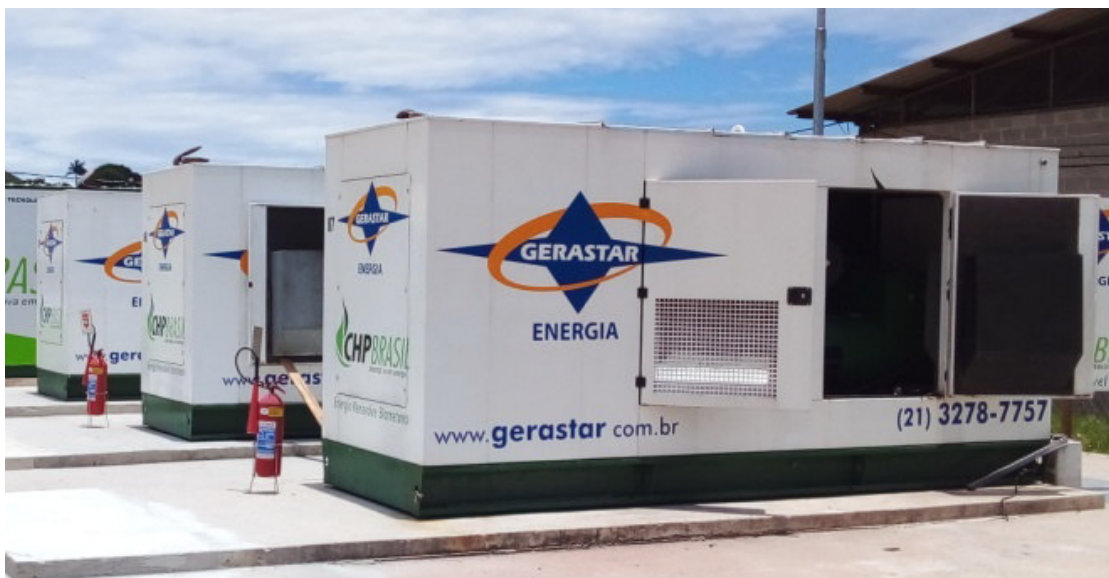
Figura 30: Vista dos geradores da estação de Biogás
