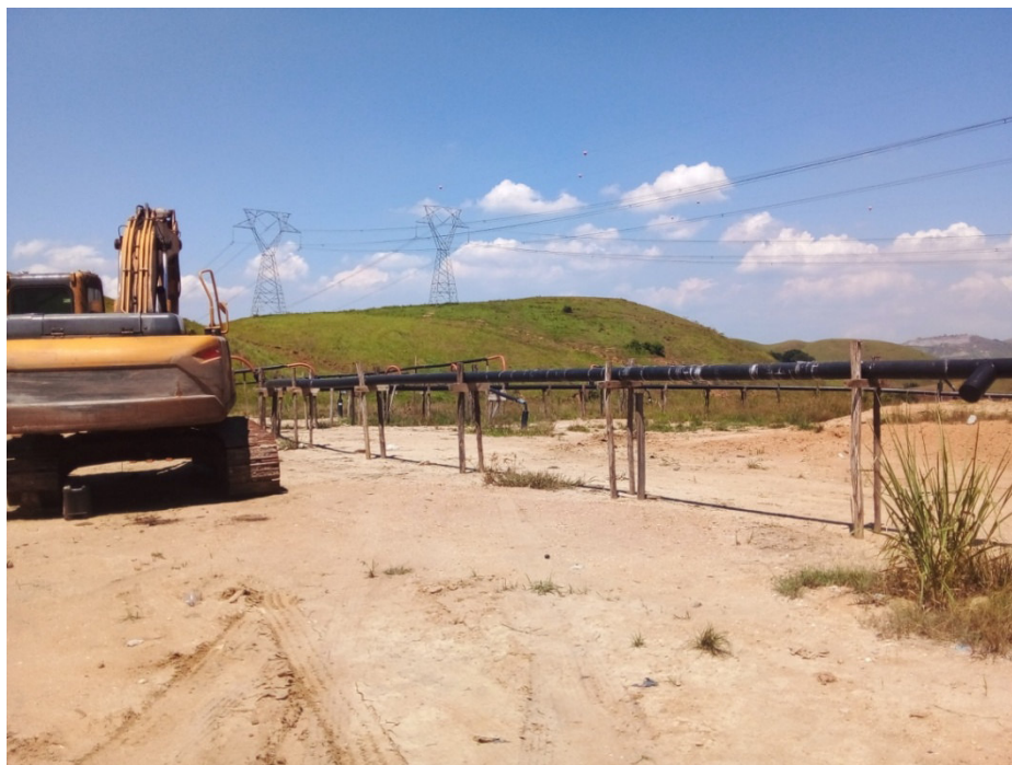
Figura 10: Dutos coletores de gás
