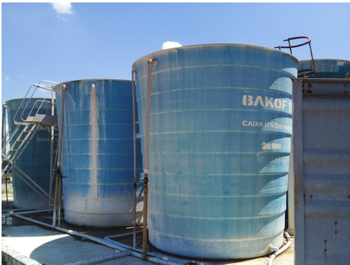
Figura 22: Tanques da estação de tratamento
