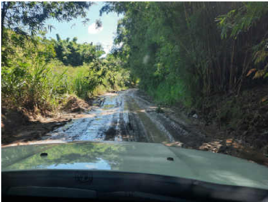
Figura 2: Vista do trecho da estrada de acesso com presença de buracos e poças de água. Fonte: Relatório de Fiscalização CARES/AGENERSA nº 02/2022.
