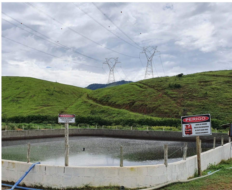
Figura 7: Lagoa de tratamento de chorume.
