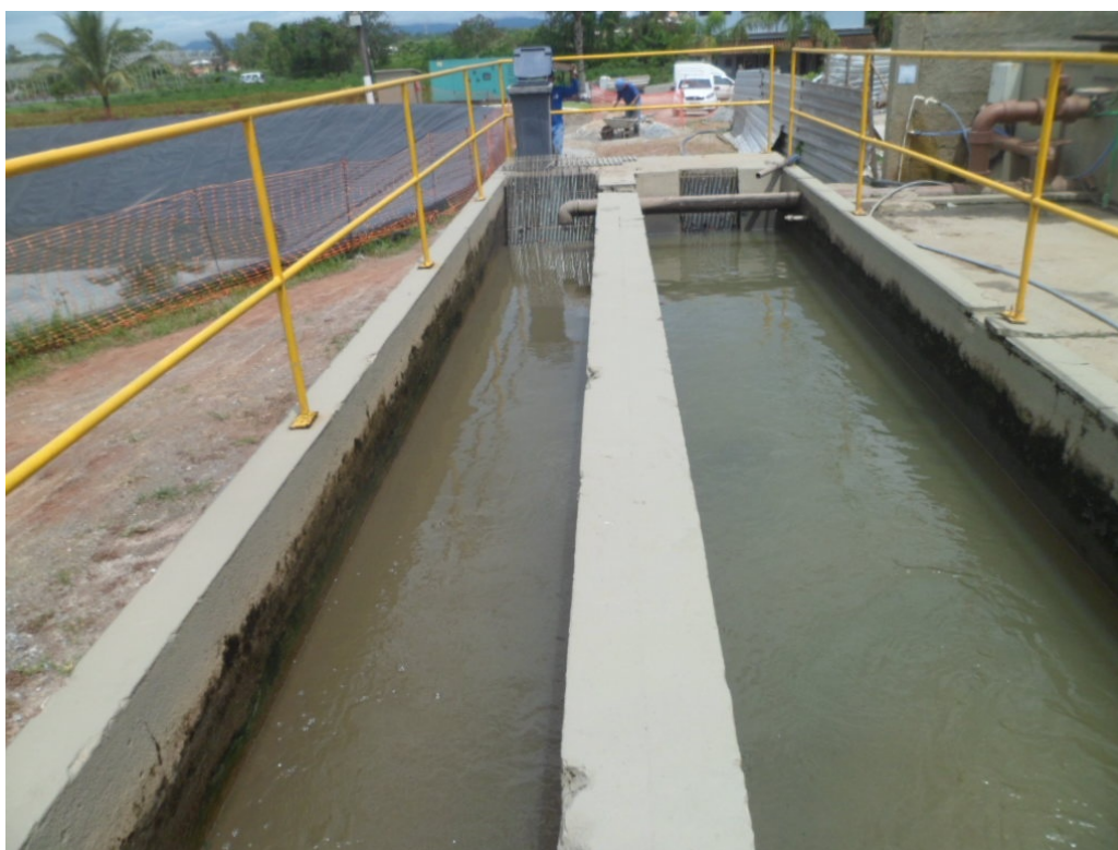
Foto 05 – Tanques de Sedimentação de Areia na Entrada do Esgoto Bruto
