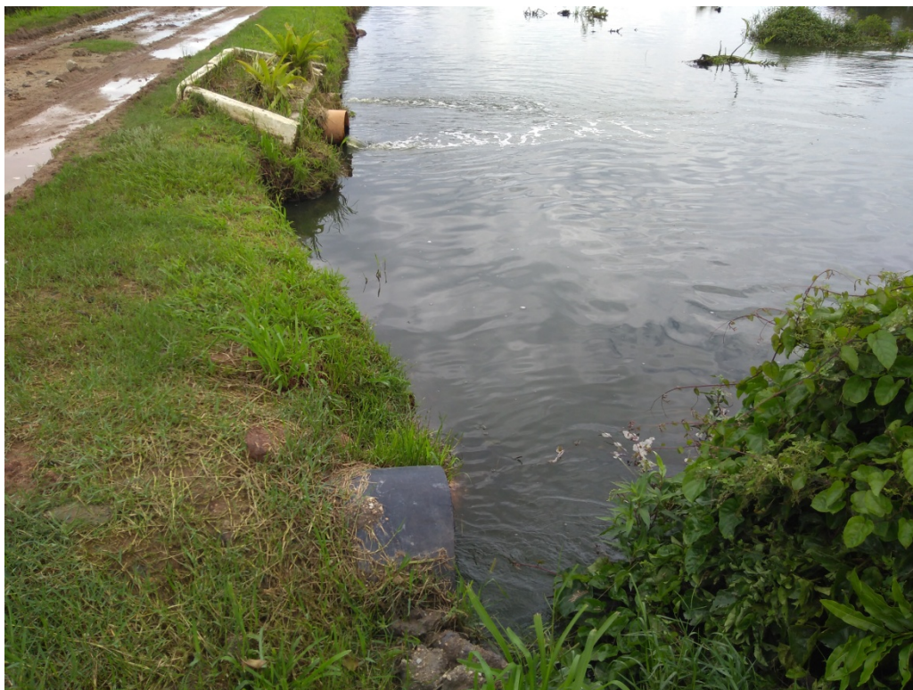
Foto 16 – Saída do Esgoto Tratado das Wetland
