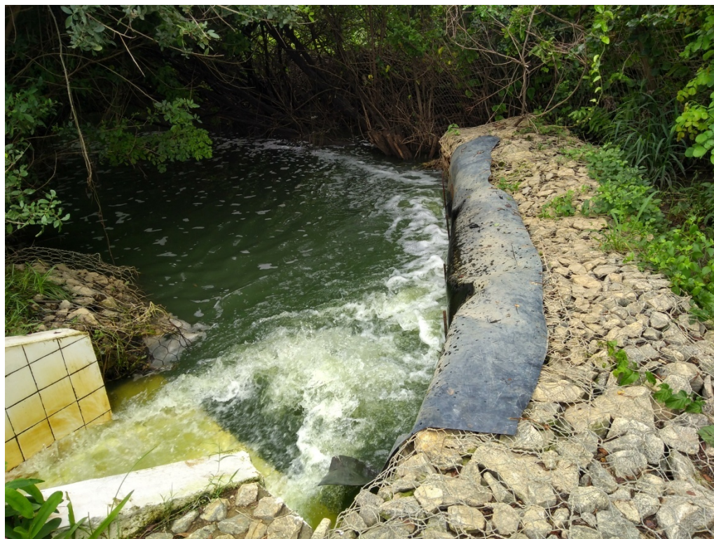
Foto 18 – Saída do Esgoto Tratado
