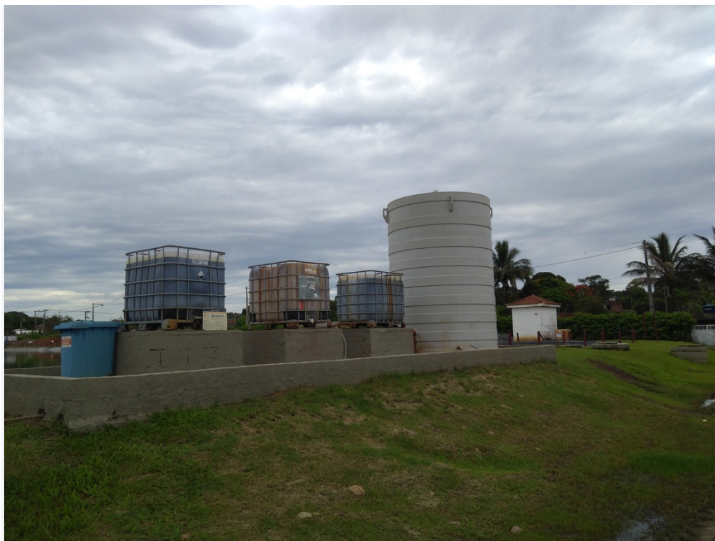
Foto 14 – Reservatórios de Policloreto de Alumínio (PAC)
