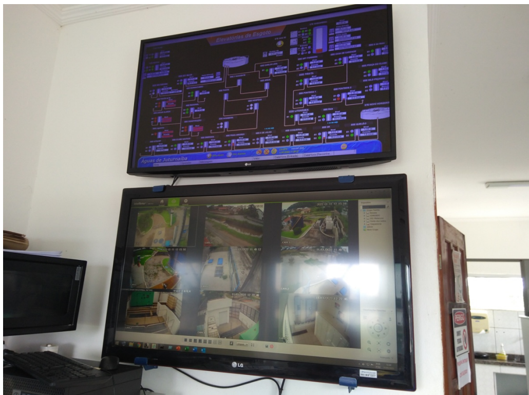
Foto 23 – CCO no Escritório da Estação de Tratamento
