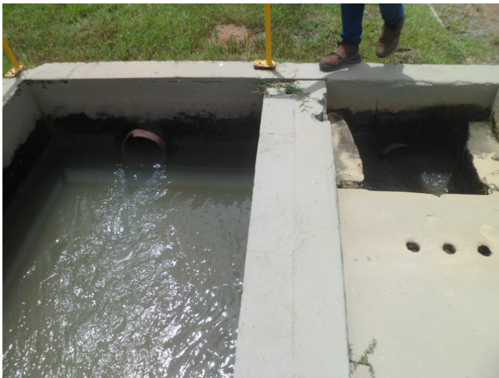
Foto 02 – Entrada do Esgoto Bruto na ETE
