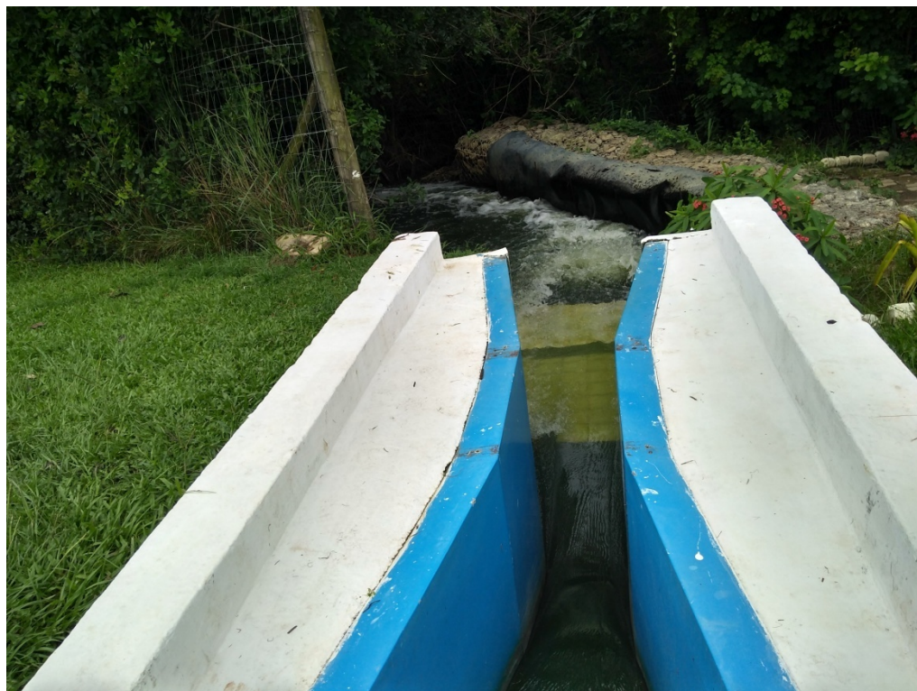
Foto 17 – Medidor de Vazão (Calha Parshall) Saída do Esgoto Tratado
