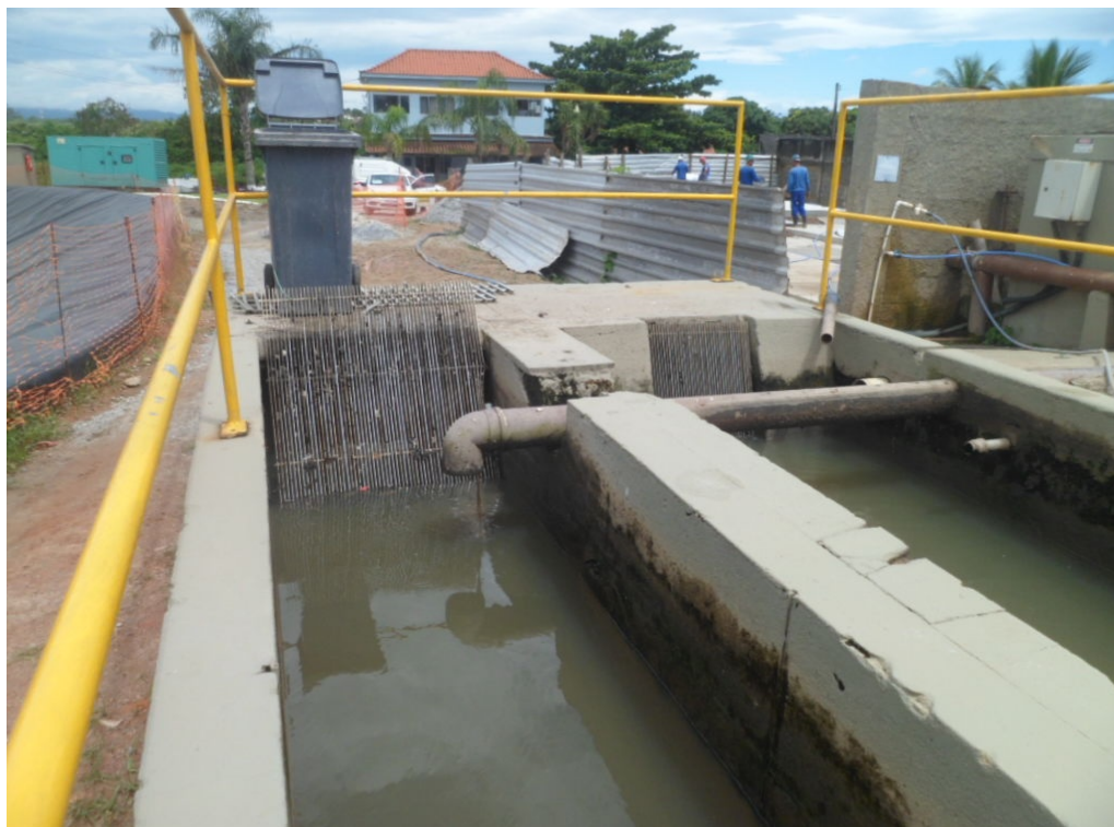
Foto 03 – Entrada do Esgoto Bruto na ETE e Gradeamento
