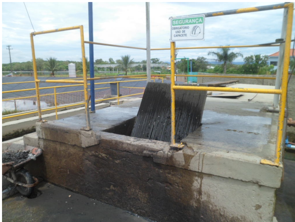
Foto 04 – Local de Recebimento de Caminhão Limpa Fossa com Gradeamento
